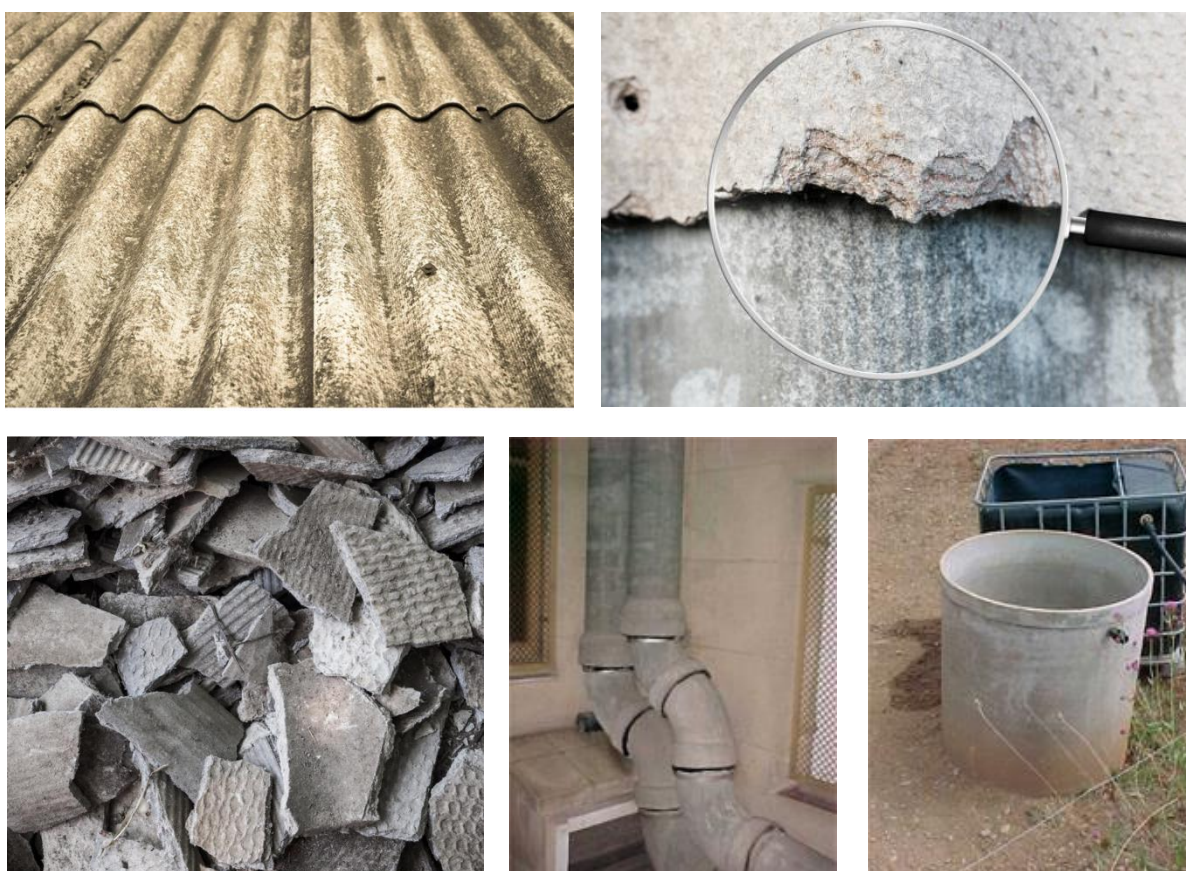
Materiales con presencia de fibrocemento: placas onduladas, tuberías y depósitos de agua.
