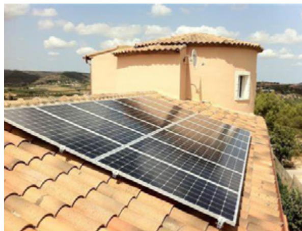
Figura 16. Instalación Solar Fotovoltaica en Vivienda Aislada. Fuente: Solar Montroi Instalaciones Solares.
