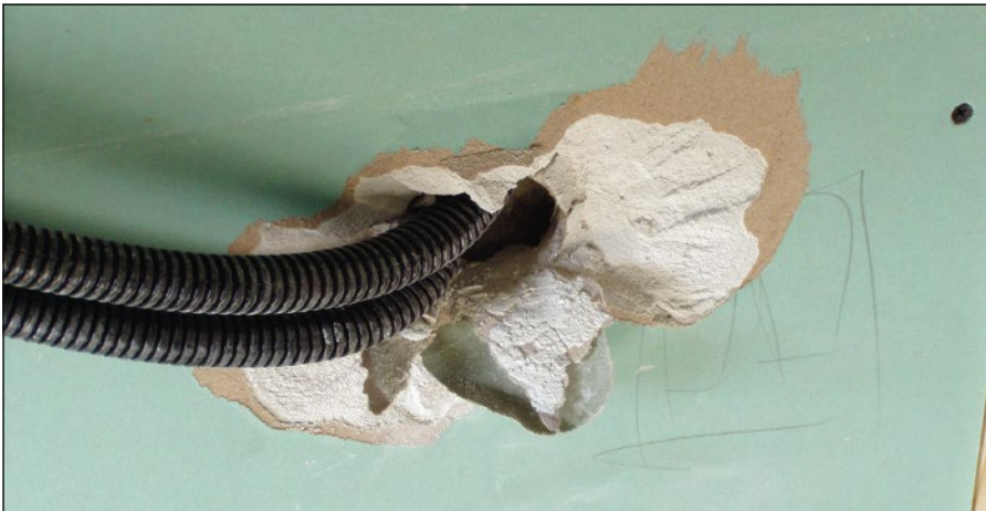
-Imagen N- Ejemplo de la mala realización de una apertura de un orificio para alojar un mecanismo de electricidad en donde la perforación se ha efectuado por con el impacto de un martillo.
