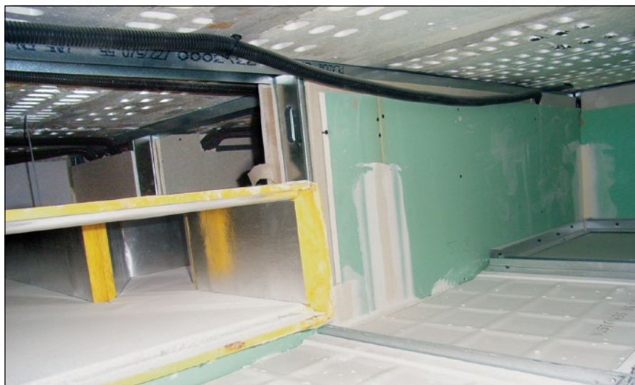
-Imagen I- Vista del plenum de entre un forjado y el falso techo. Se aprecia que el tabique no se ha cerrado en el tramo existente sobre el conducto de ventilación.
