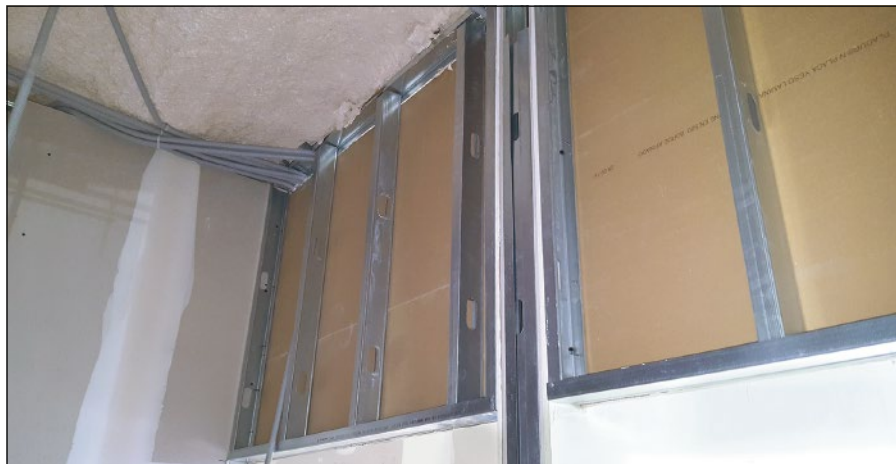
-Imagen J- Parte superior del hueco de dos puertas separadas por un tabique en perpendicular. Se aprecia que las canales no doblan a 90° para solapar sobre los montantes.
