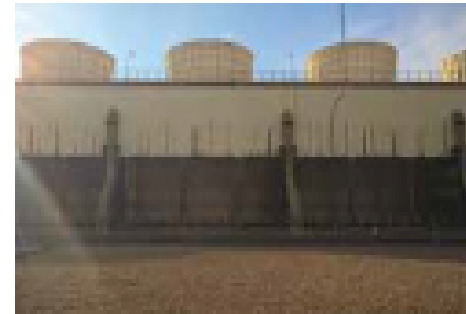
Torres de refrigeración, Valencia
