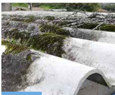
Fibrocemento deteriorado. Material friable.
