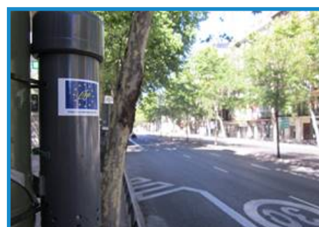
Figura 48: Detalle de sensor instalado en zona de aplicación del tratamiento superficial fotocatalítico. Fuente: Cartif.
