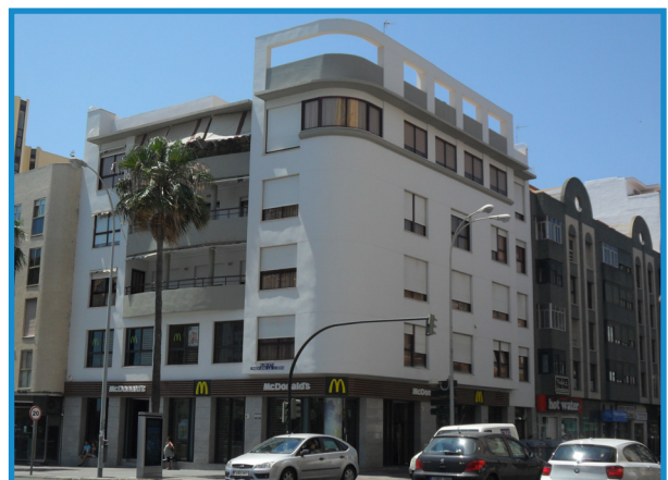
Figura 33: Fachada con pintura fotocatalítica en Ingeniero La Cierva. Cádiz (España). Fuente: KEIM
