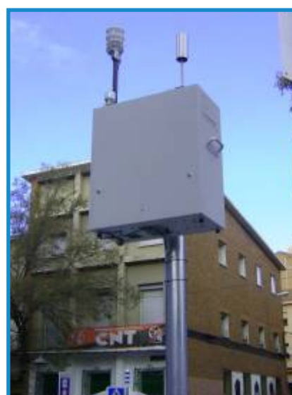
Figura 43: Analizador automático en continuo para la determinación en el aire ambiente de óxidos de nitrógeno (NO, NO 2 , NO x ) y de ozono (O 3 ) puesto en la plaza de Ágata. Fuente: Eptisa.
