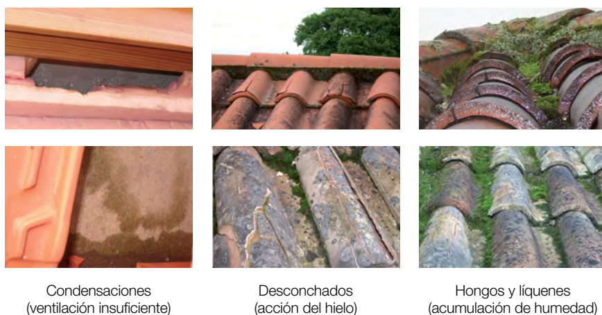
Figura 12. Posibles efectos adversos en cubiertas con tejas fijadas con mortero por falta de microventilación
