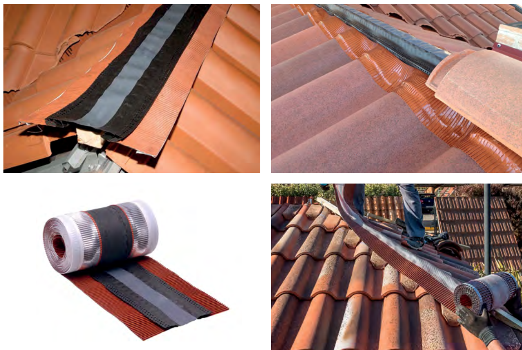
Figura 77. Instalación de bandas impermeables traspirables o microperforadas para conseguir la micro-ventilación en cumbrera y limatesas
