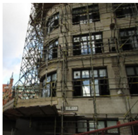
Andamios metálico tubular no modular, de tubo y grapa
