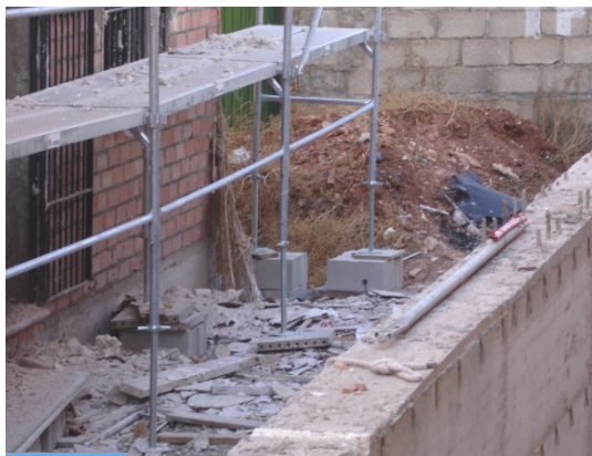
Incorrecto apoyo de un andamio sobre bloques inestables.
