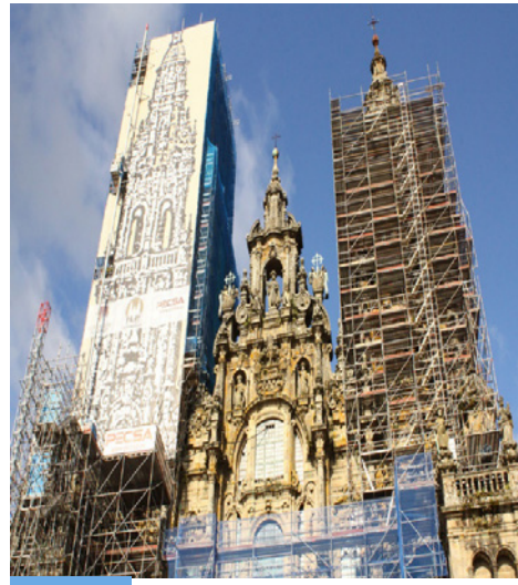
Un andamio con revestimiento requiere mayor sujeción porque se puede producir el efecto vela, debido al viento.
