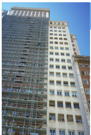
Foto izquierda Andamio con distancia entre apoyos superior a 8 metros.
