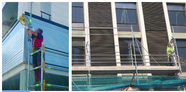
Foto izquierda Polea para la elevación de materiales en el montaje de andamios. Foto derecha Las poleas se pueden fijar sobre los montantes verticales o marcos del andamio.
