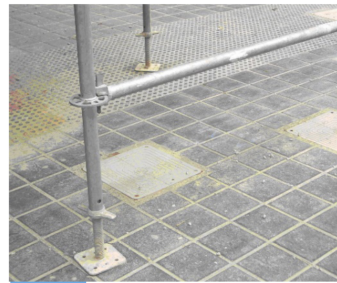
Configuración errónea de las bases regulables para evitar su instalación sobre una arqueta
