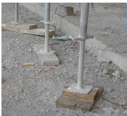
Apoyo de un andamio sobre durmiente de madera.
