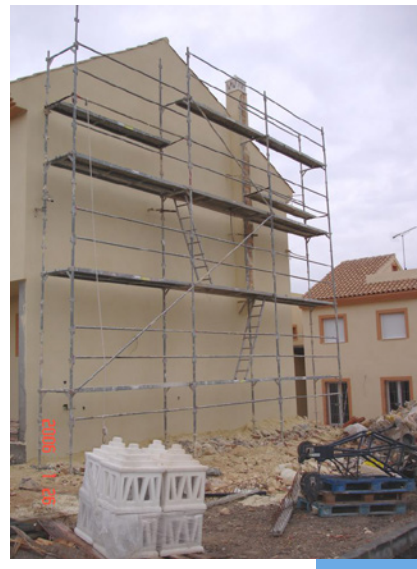
Detalle de andamio unidireccional de fachada, con ausencia de elementos de protección en las áreas de trabajo
