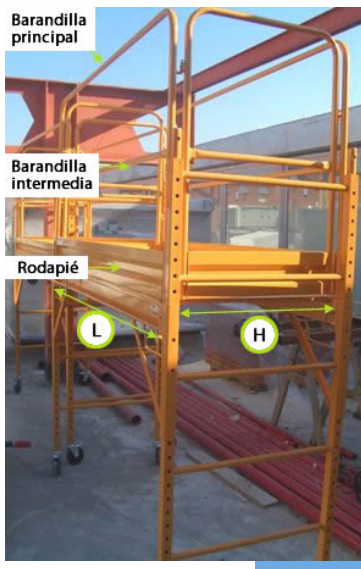
También las barandillas de las torres móviles se dispondrán de forma que su superficie más alta esté como mínimo a un metro sobre el nivel superior de la zona de trabajo. Contarán, además, con protección intermedia y rodapié.
