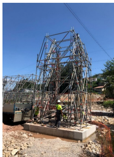
En todo trabajo en proximidad de elementos en tensión, el trabajador deberá permanecer fuera de la zona de peligro y lo más alejado de ella que el trabajo permita.
