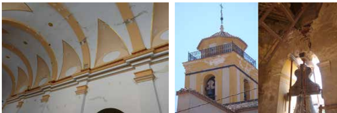
Figura 3. Interior de la bóveda de la nave y daños en el campanario.
