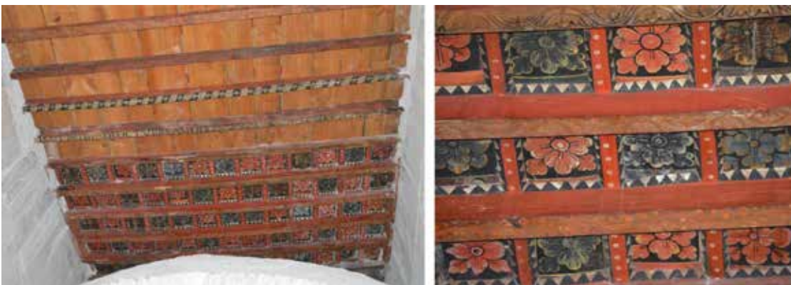
Fig. 4. Vista general de los restos originales de carpintería de armar en la Iglesia de Mula (izqda.), y detalle de las policromías en la solución de cinta y saetino (dcha.).
