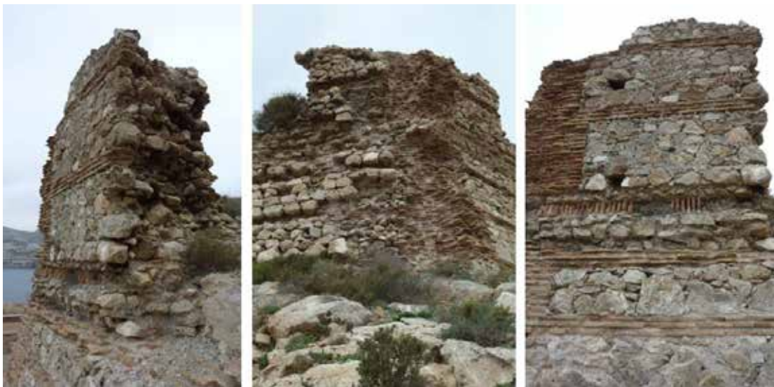
Fig. 4. Diferentes imágenes del estado actual de conservación de los muros de mampostería y aparejo de ladrillo macizo de la Torre Navidad. (P.E. Collado).
