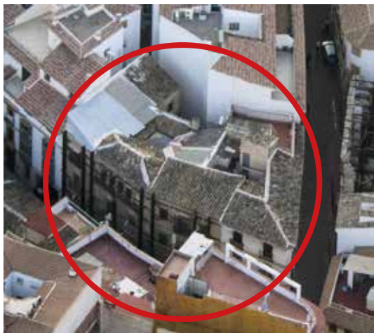
Figura 1. Casa de los Irurita. Lorca. Vista aérea al inicio de los trabajos
