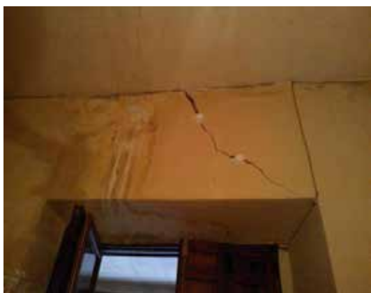
Fig. 4. Imagen de una grietas
