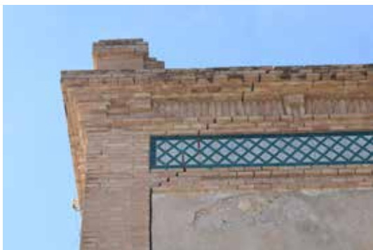
Fig. 6. Grietas en fachada en apeadero de Los Baños.
