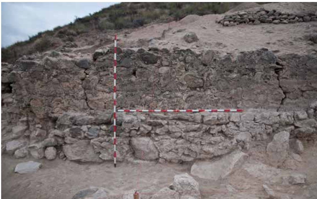
Fig. 3. Zócalo con refuerzo de la muralla occidental de Bolvax, en la que se observan las grietas provocadas por el sismo y el refuerzo de la misma (Fotografía: Tete Lukas)
