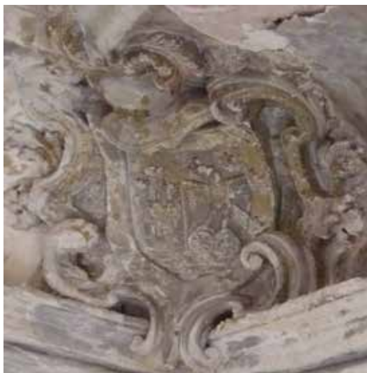
Fig. 5. Detalle de presencia de humedad en escudo nobiliario.
