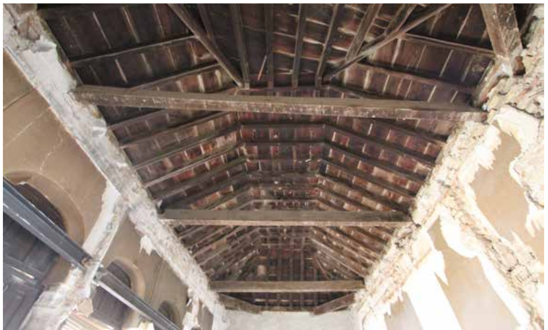
Figura 8. Casa Irurita en Lorca. Armadura de cubierta del mirador, nada más retirar los falsos techos
