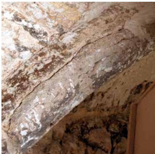
Figura 1: Dovela de yeso parcialmente fracturada de la bóveda de la Torre del Reloj, en la fortaleza de Caravaca. Año 2007.
