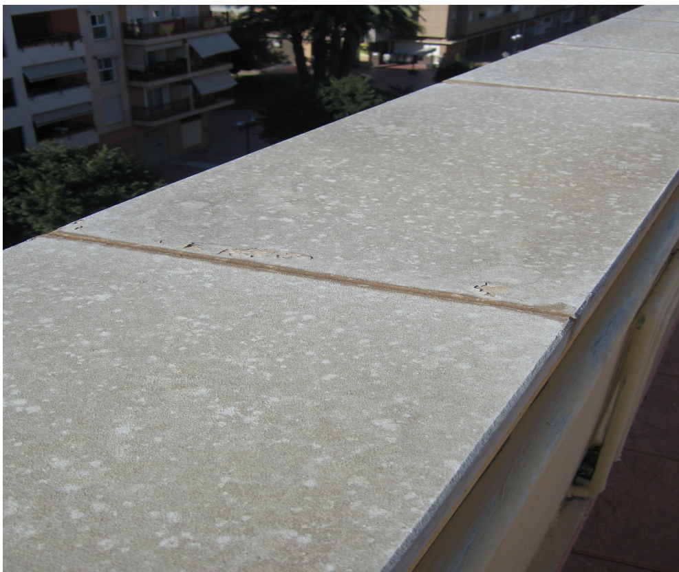
Figura 1.- Albardilla de piedra caliza en cubre-muros de antepecho de cubierta plana con lesiones de desprendimiento de revestimiento de pintura y juntas mal resueltas.
