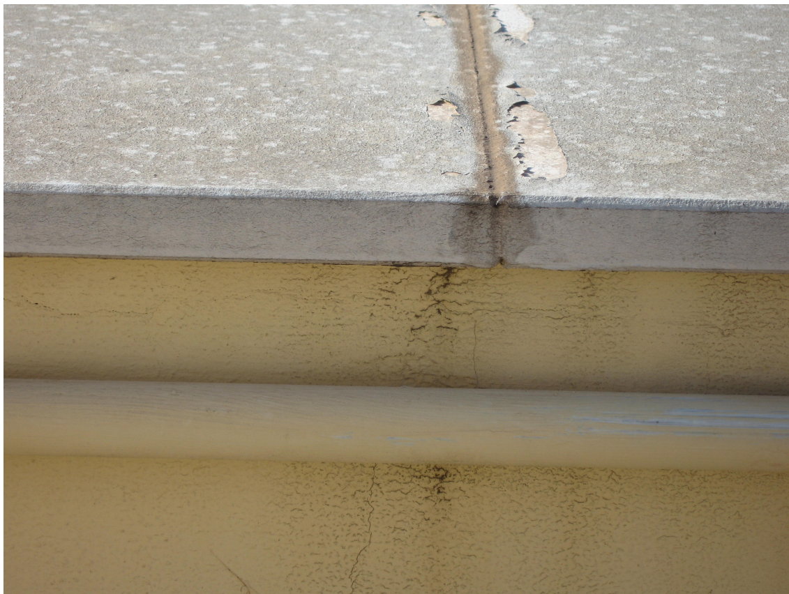
Foto. - 2. Detalles de la lesión: filtraciones por humedad en junta y desprendimiento superficial del revestimiento empleado por erosión en albardilla de piedra caliza.
