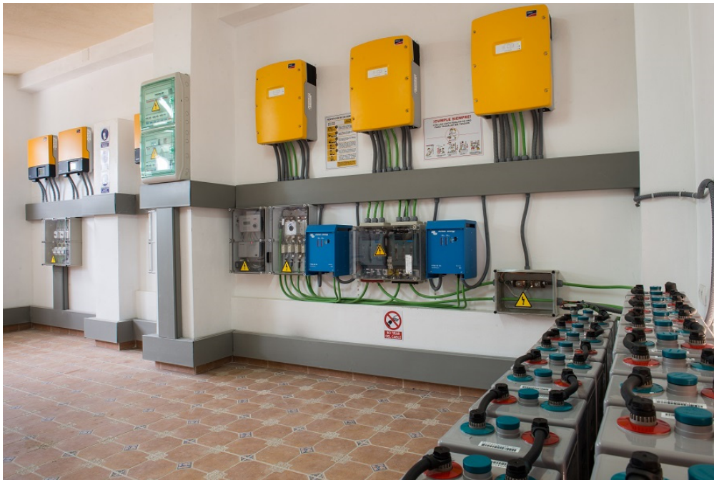
Figura 3. Inversores y baterías del sistema de generación.
