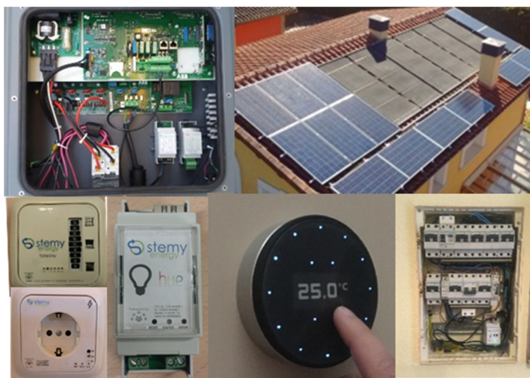
Figura 2. Equipos en casa piloto (de izda a decha y de arriba abajo): inversor, paneles solares, control de persianas, control de radiadores, control de luces, termostato, monitorización consumo en cuadro de protecciones.
