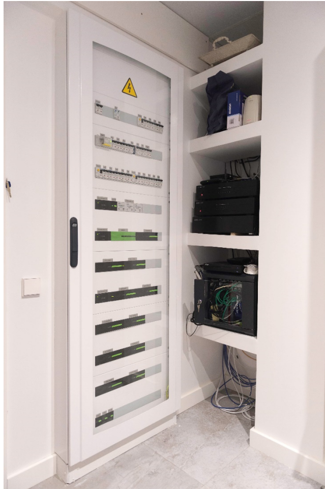
Figura 7. Cuadro eléctrico, servidor de música y amplificador.
