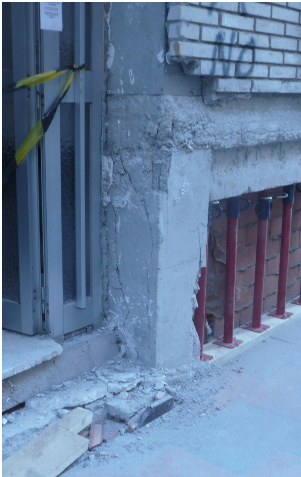
En la Figura: Donde se aprecia con más detalle las lesiones indicadas en las fotografías anteriores. Se observa el canto del forjado de planta baja y debajo una viga de cuelgue que parece que hace la función de dintel, apuntalado, por desprendimiento de la fábrica exterior. ¿El apuntalamiento es suficiente y útil?
