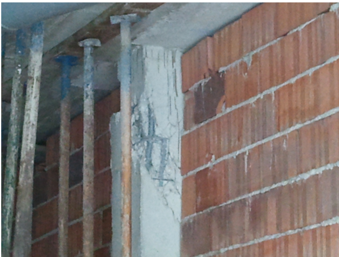
Figura 1. Ejemplo de ejecución de medidas de seguridad, para garantizar la estabilidad estructural del pilar dañado por esfuerzo cortante, con deformación plástica de su armadura principal y desplome. La fábrica de bloques cerámicos sirve de ayuda auxiliar para preservar la estabilidad estructural del elemento al entrar en carga.
