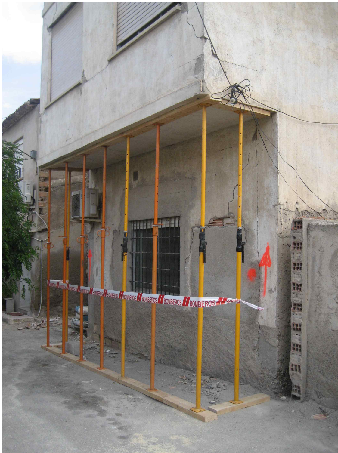
FIGURA 9. Edificio en voladizo. Los extremos volados han sufrido movimientos verticales y horizontales, dando lugar a flecha deferida en extremo mas volado. Las deformaciones estructurales se transforman en fuertes solicitaciones sobre el cerramiento exterior de fachada, las cuales determinan su rotura. Se ha apeado con puntales metálicos para soportar el cerramiento de la fachada volada por prevención y seguridad.
