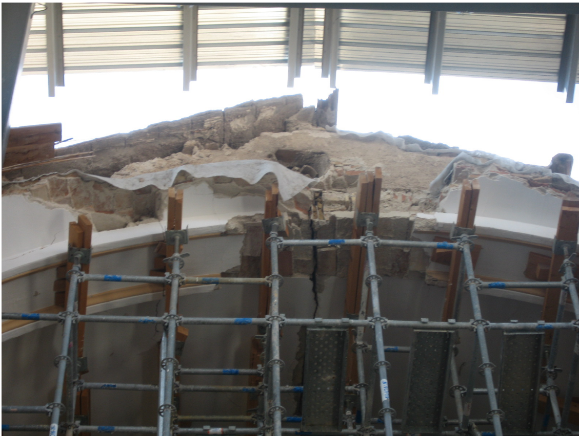
FIGURA. Colapso del crucero de la iglesia de Santiago. Apeo supletorio , mediante puntales telescopios de acero y bridas fijas y giratorias de dos tipos de diámetros. La opción de ejecutar un apeo de supletorio como el que se muestra en la foto permite realizar operaciones de reparación globales o parciales por razones técnicas.
