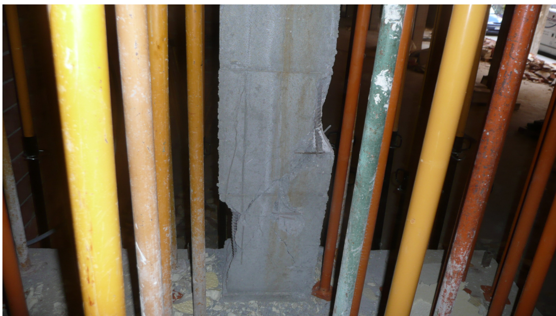
FIGURA 4. DESPLAZAMIENTO DE LA BASE DE PILAR POR FUERTE CORTANTE. APUNTALAMIENTO RIGUROSO DE URGENCIA. Edificio situado en calle Castilla, de Lorca. Este apuntalamiento permite la transmisión de carga vertical a otras plantas o terreno mediante el empleo de puntales metálicos, se observa la no existencia de durmientes en base de los elementos metálicos, a compresión. No apto para poder sustituir o reparar el pilar desplazado por cortante con deformación de armaduras, daños graves.
