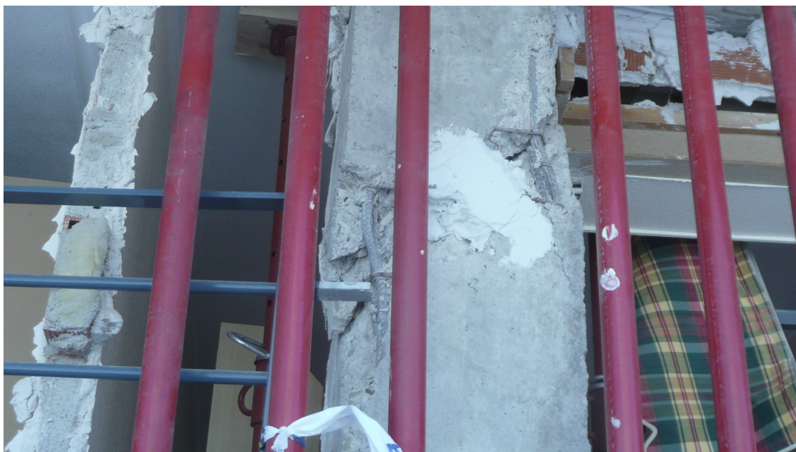
FIGURA 8. Lesión grave en cabeza de pilar de planta baja por cortante. Rotura plástica del hormigón y acero. Pilar sobre cargado y momento flector fuerte. Desprendimiento, desplazamiento del hormigón y pandeo de armaduras. El apeo realizado impide el orden y tipo de intervención posteriores para reparar el elemento dañado.
