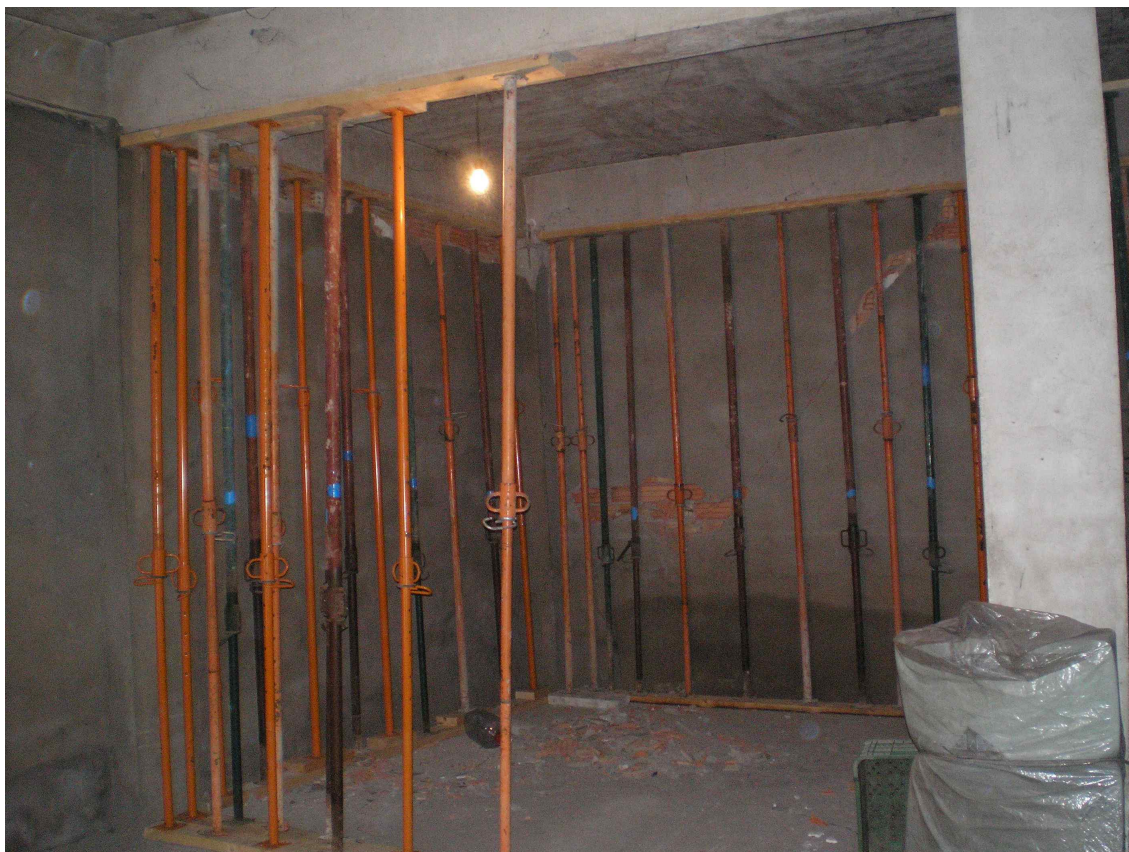
FIGURA 16. Apeo supletorio: Tornapuntas metálicas verticales con durmientes y sopandas de madera, de transmisión de la carga de las vigas colgadas al suelo o terreno descargando los extremos de las mismas por lesiones por cortante. Ataja un peligro inminente. No supone una solución de apeo definitiva.
