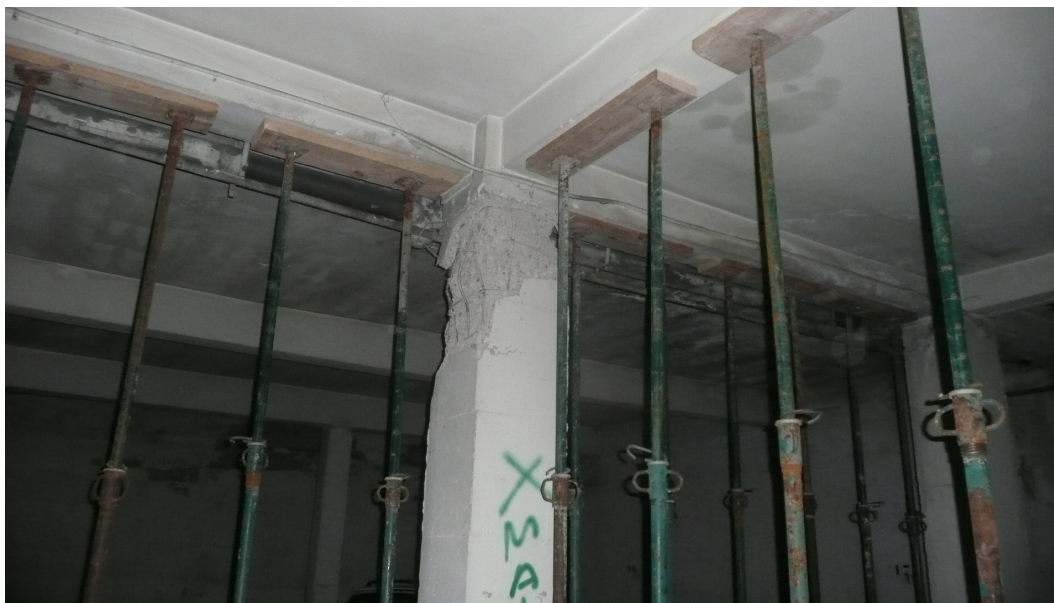
FIGURA 7. Lesión grave en cabeza de pilar de planta sótano por flexión combinada con la carga axial. Aparecen indicios de rotura plástica con deformación de armaduras principales. Desprendimiento y rotura de hormigón. El apeo de elementos verticales realizados bajo las vigas colgadas descarga las cargas de la cabeza del pilar. El apeo realizado es apto para poder intervenir en el elemento dañado.
