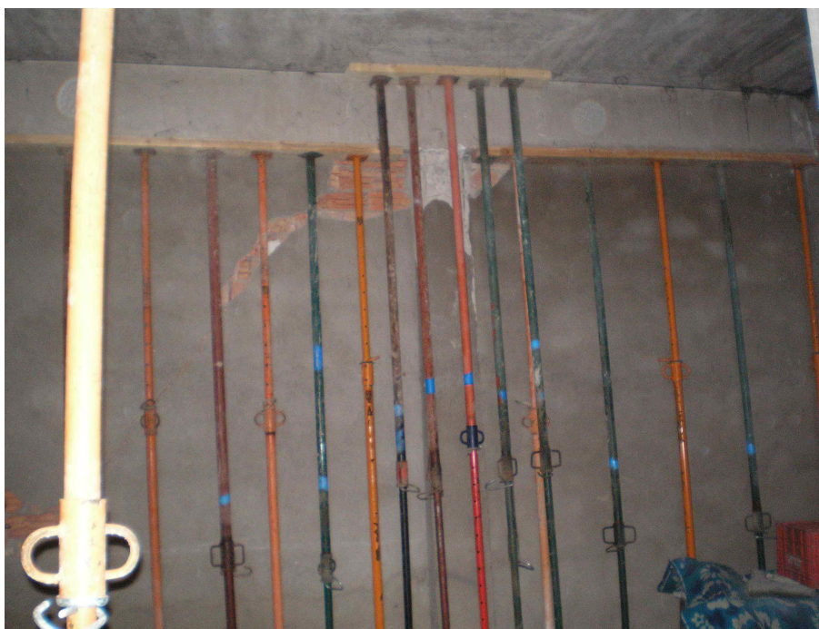
FIGURA 15. Apeo supletorio: Tornapuntas metálicas verticales con durmientes y sopandas de madera, de transmisión de la carga del forjado y de la viga colgada horizontal al suelo o terreno descargando la cabeza del pilar por lesiones graves. Ataja un peligro inminente. No supone una solución de apeo definitiva.
