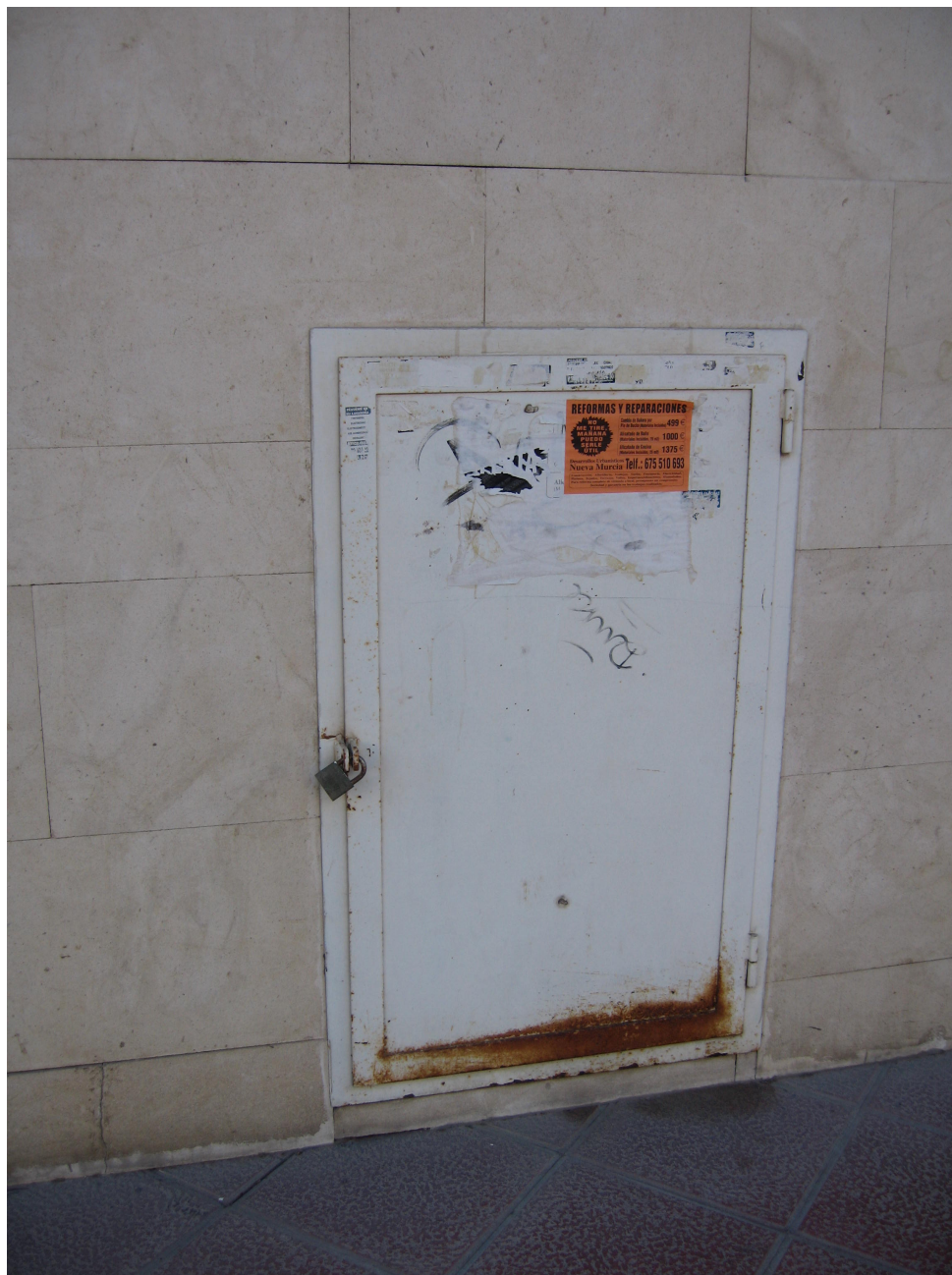
Foto. - 2. Detalles de la lesión: corrosión por aireación diferencial en parte baja de puerta metálica
