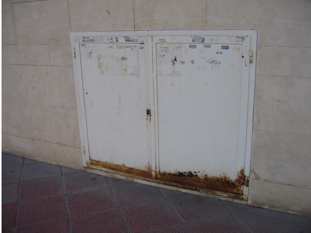
Foto 1.- Vista general del registro en planta baja del edificio, donde se observa la alteración de corrosión por aireación diferencial en bajos de registros de puerta metálica.
