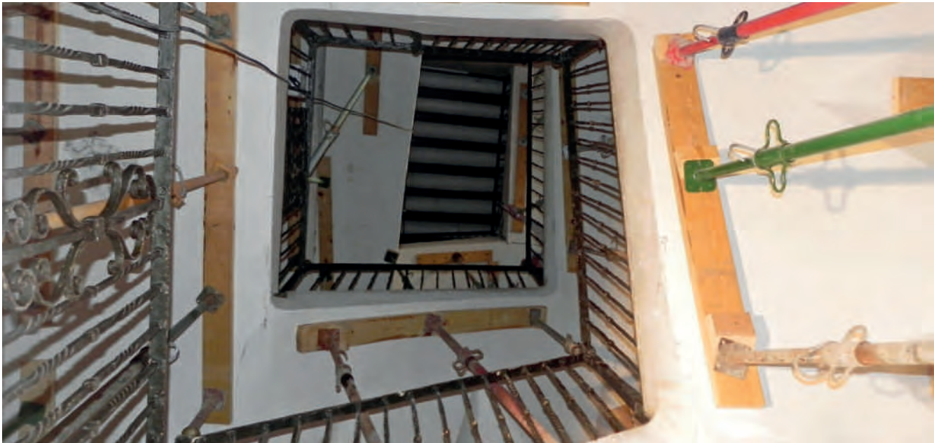
Figura 4. Imagen del apuntalamiento completo de la parte interior de la zanca de la escalera tras los terremotos. En el último piso se aprecia cómo se realizó una intervención anterior en la que se construyó un forjado y el espacio de la escalera fue absorbido por una de las viviendas, con la consiguiente mutilación de la imagen y de la luz que debía llegar al resto de plantas. Fotografía: Juan de Dios de la Hoz.
