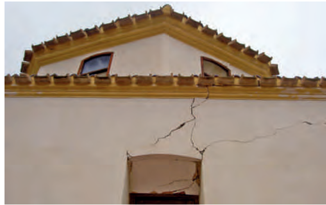
Figura 7. Daños del terremoto en el torreón de la escalera principal.
