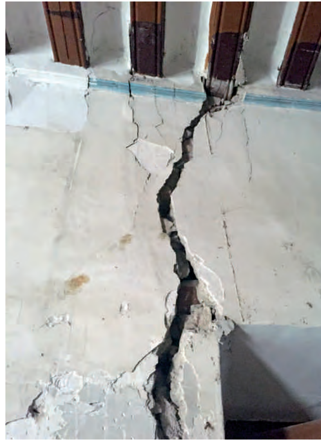
Figura 10. Considerable grieta estructural en muro de planta baja, estancia izquierda.
