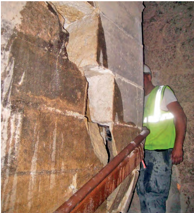
Figura 19. La grieta interior más peligrosa se rellena con mortero de cal hidráulica y el muro vuelve a transmitir su compresión. Unos 20 cm de desplazamiento hacen que el muro pase a tener solo el 80 % de su grueso en continuidad, con lo que las tensiones internas aumentan en un 25 %, aun dentro de lo admisible para esta fábrica.
