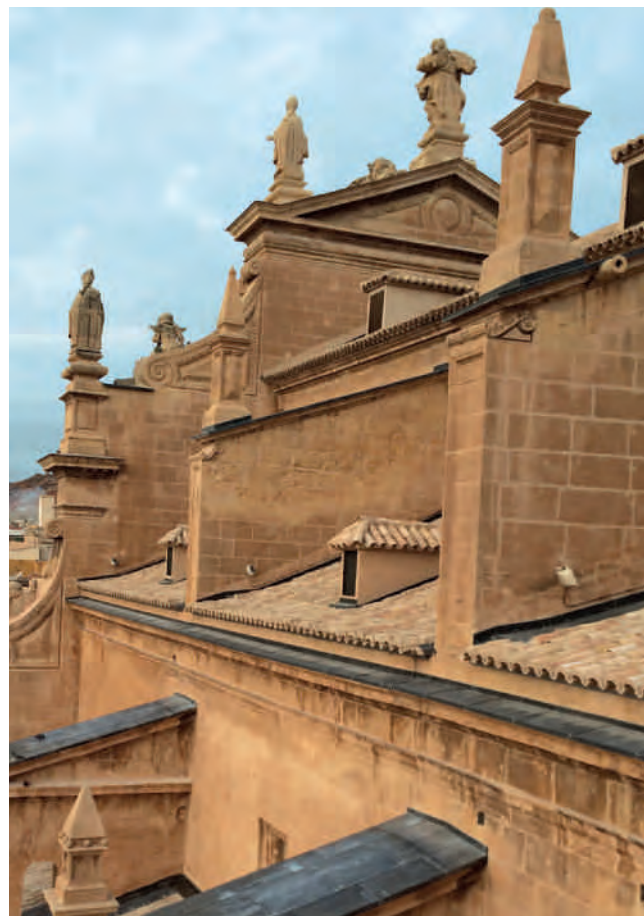
Figura 16. Faldones, contrafuertes y aleros de la fachada sur, una vez finalizados los trabajos sobre ellos. Fotografía: Juan de Dios de la Hoz.
