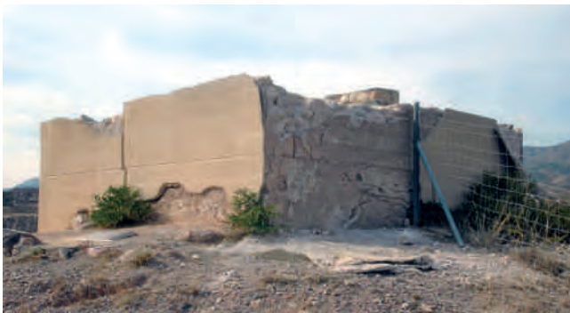
Figura 3. Estado de la torre en octubre de 2005, previo a la segunda intervención. Se observa el elevado nivel de deterioro de los paramentos, así como la pérdida y desprendimiento del revestimiento.
