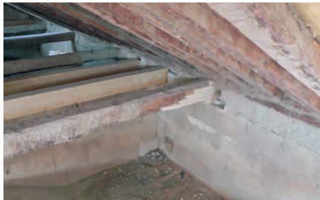
Figura 8. Dos fotografías del espacio bajo la cubierta de San Patricio: a la izquierda, antes de las obras, con ausencia casi total de tirantes horizontales (apenas se ve el resto de la cabeza de uno de ellos); a la derecha, una vez ejecutados los nuevos tirantes, utilizando piezas completas de madera laminada, o bien mediante la ejecución de prótesis de madera encoladas con resorcina, donde era posible la recuperación. Fotografías: Juan de Dios de la Hoz.
