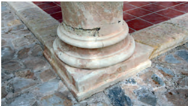
Figura 4. Ligerо desplazamiento de columna por la junta modular constructiva.
