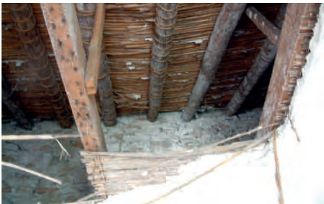
Figura 2. Estado de la estructura de madera de la cubierta en su empotramiento con el muro de la fachada.
