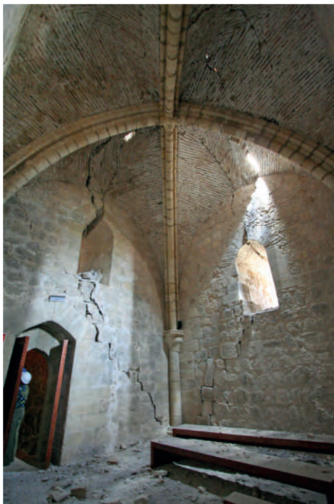
Figura 2. Fractura de esquina que dañó la basa y fuste de la columna en interior de la torre del Espolón.
