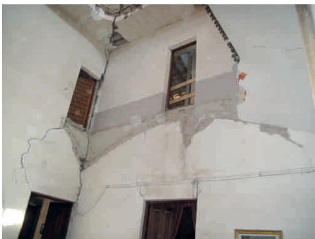
Figuras. 3 y 4. Diferentes tramos de la misma escalera de la casa de los Cachá desplomados tras el terremoto en Lorca.
