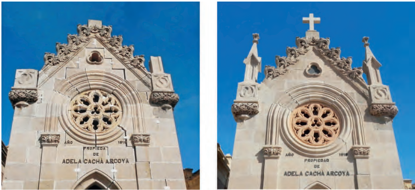
Figura 8. Imágenes comparativas de la parte superior de la fachada principal tras los terremotos (izquierda) y tras la restauración (derecha). Fotografías: Juan de Dios de la Hoz.
