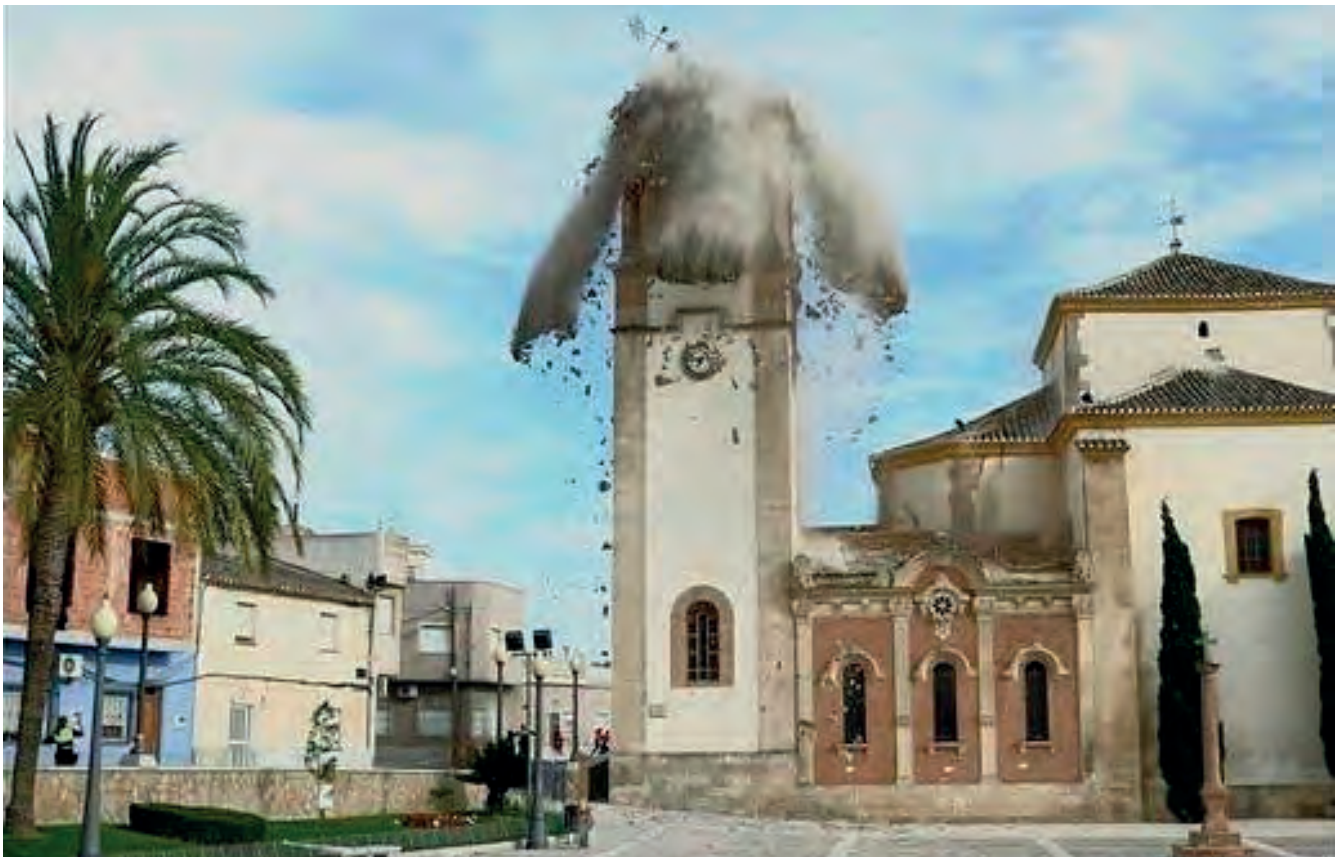
Figura 12. Instante en que colapsa el remate de la torre, captado por un viandante.
