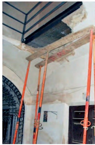
Figura 4. Caída de revestimientos.
