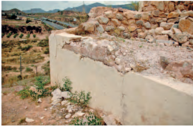
Figura 6. Cara sur y esquina suroeste. Se observa la pérdida de material del revestimiento así como la fisuración de la esquina del paramento.
