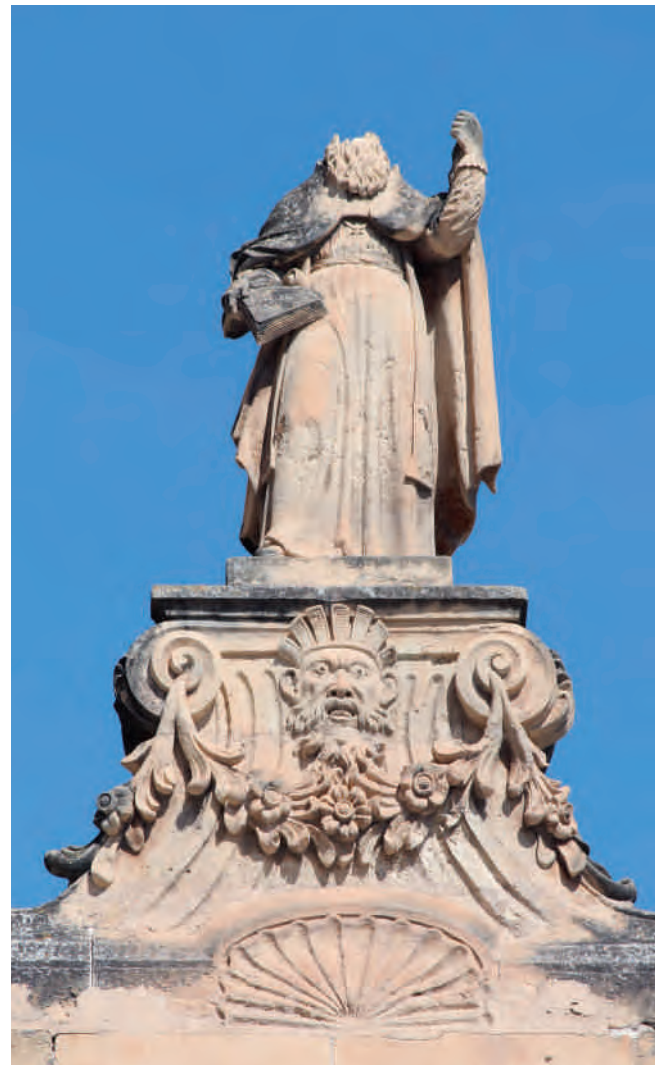
Figura 3. Rotura de escultura en fachada de salas capitulares.
