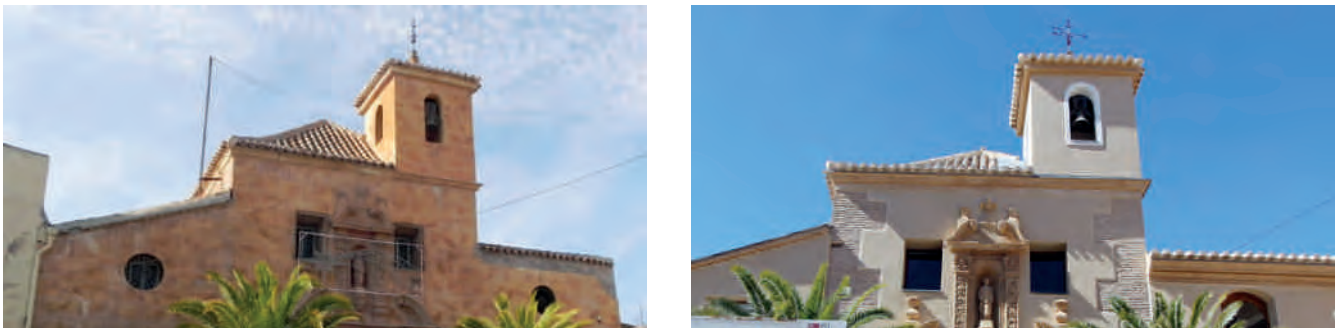
Figura 19. Estado de la parte alta de la fachada principal tras los terremotos y en la actualidad (febrero de 2016). Fotografías: Juan de Dios de la Hoz.
