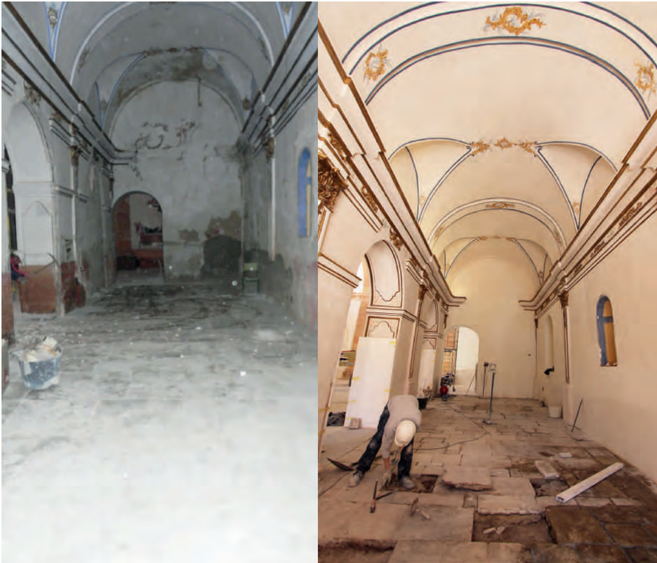
Figura 18. Estado del interior de la capilla del lateral de la Epístola tras los terremotos y en la actualidad (recordemos que no se encuentran aún finalizadas las obras). Fotografías: Luis de la Hoz y Carmen Martínez Ríos.
