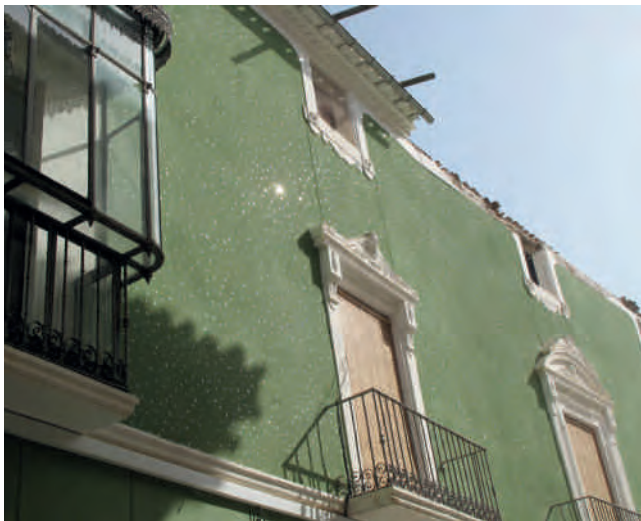
Figura 1. Cornisa del alero desprendida.
