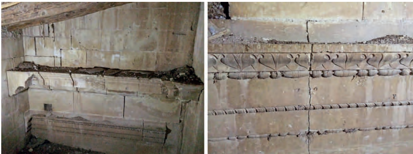
Figura 11. Detalles de la cornisa tallada en piedra, encontrada en el espacio bajo la cubierta del transepto norte. Fotografías: Juan de Dios de la Hoz.
