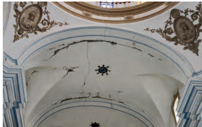
Figura 5. Detalle del estado en el que quedó una de las bóvedas de la nave central. Fotografía: Juan de Dios de la Hoz.
