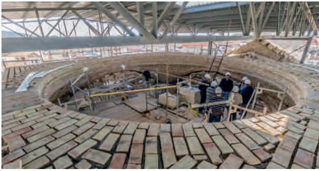
Figuras 15. Estructura concluida, conformando la base del tambor de la cúpula. Fotografía: Jaime J. Díaz.
