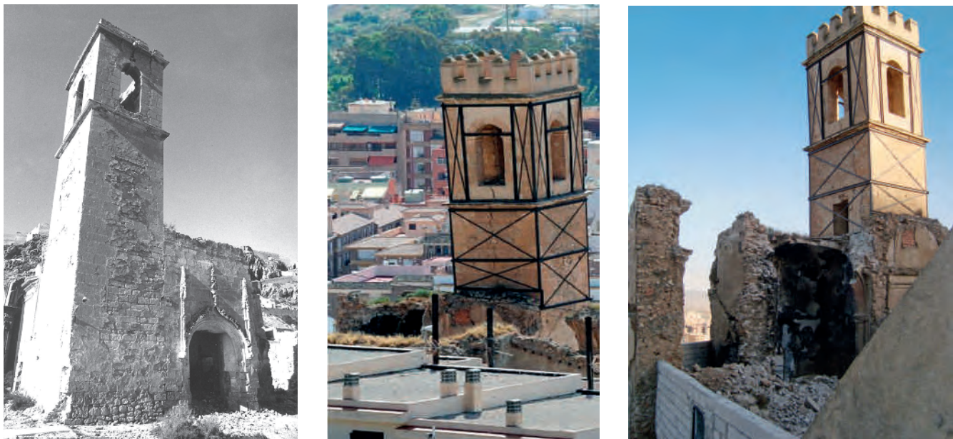
Figura 2. Izquierda: iglesia de San Pedro de Lorca en 1978. Derecha: estado de la iglesia después del terremoto de 2011. Fotografías: Inventario Bienes Muebles de Murcia, Ministerio de Cultura (1978) y Comunidad Autónoma de la Región de Murcia.
