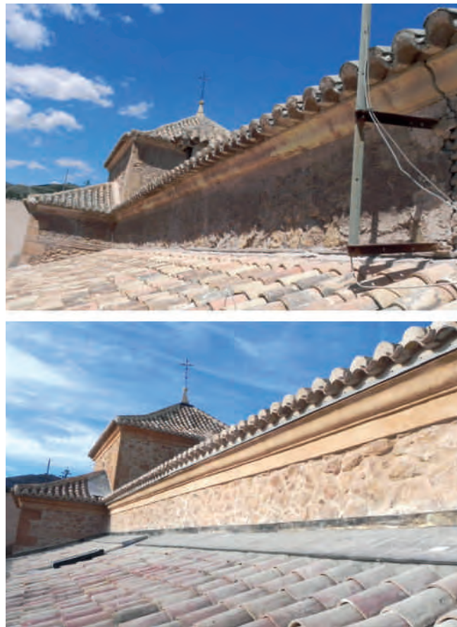
Figura 14. Imágenes de las cubiertas en el estado en el que se encontraban antes y después de las obras: Fotografías Juan de Dios de la Hoz.
