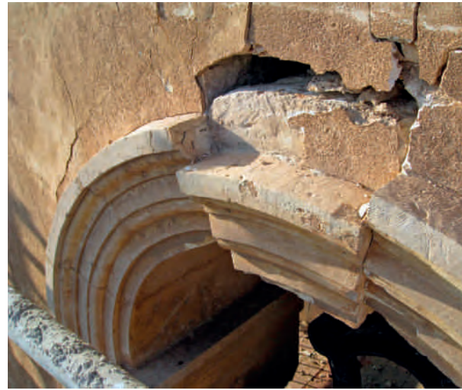
Figura 2. Uno de los arcos de la torre de la iglesia de San Mateo, con un enorme desplazamiento vertical de la clave. Fotografía: Juan de Dios de la Hoz.
