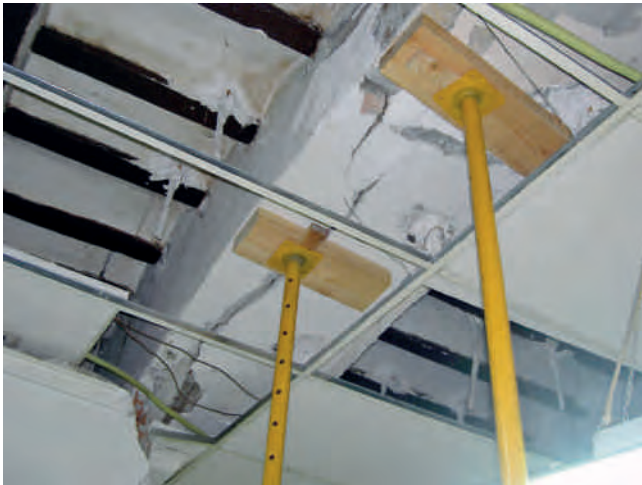
Figura 14. Cargadero arruinado en la vivienda que está integrada en el edificio.
