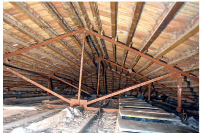
Figura 13. Cubierta sobre el salón de baile, en situación muy precaria ante fenómenos atmosféricos.
