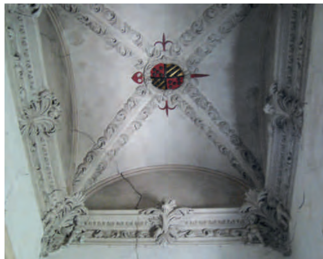
Figura 6. La bóveda de la escalera antes de la restauración.
