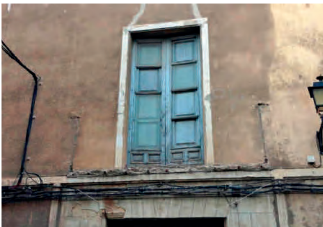
Figura 27. Detalle de carpintería de balcones y restos de balcones.
