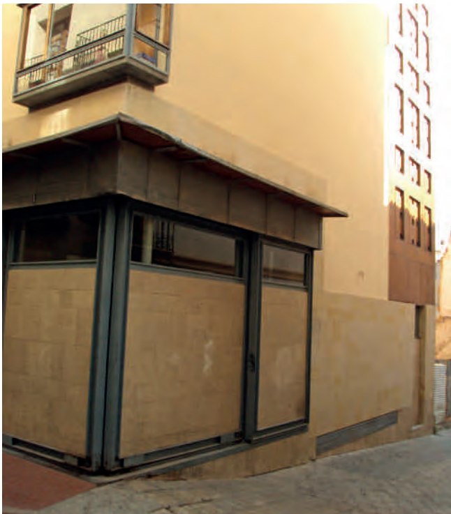
Figura 14. Paneles de madera deteriorados.
