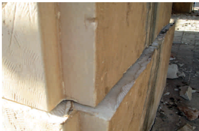
Figura 6. Detalle del desplazamiento sufrido en una de las esquinas de la torre durante el terremoto. Fotografía: Juan de Dios de la Hoz.
