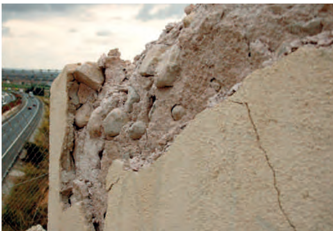
Figura 10. Desprendimientos del revestimiento y parte del muro en la cara norte.
