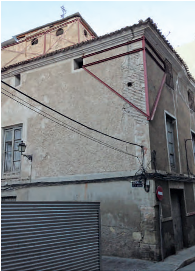
Figura 9. Estructura de arriostramiento de fachada y torreón, realizadas en las obras de emergencia, tras el terremoto.
