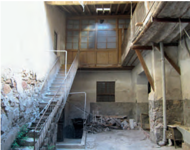
Figura 4. Patio trasero con edificación secundaria, tras terremoto.
