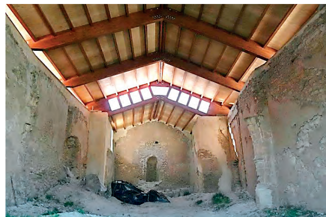
Figuras 53 y 54. La cubierta de madera durante su ejecución y vista del interior durante los trabajos.
