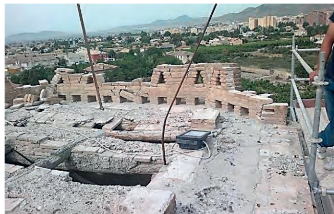
Figuras 37 y 38. El remate de la torre al comienzo de nuestras obras, desde abajo y desde arriba del andamio.
