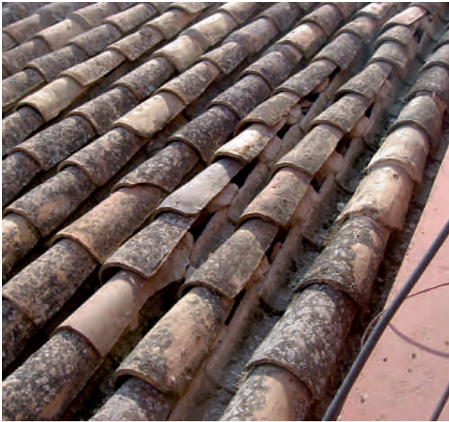
Figura 7. Ríos de tejas desplazados en el tejado sobre el patio de butacas.
