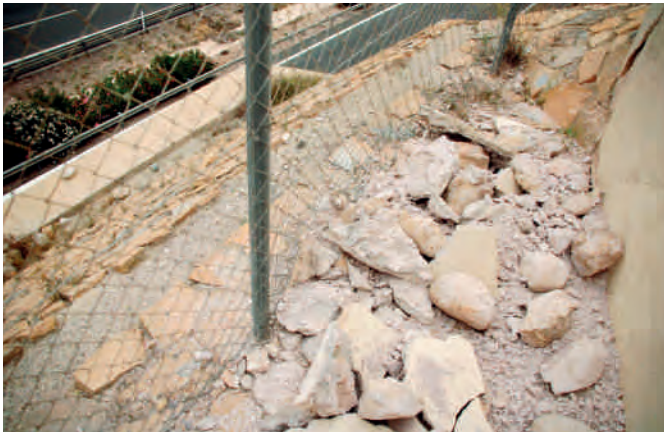
Figura 8. La caída de materiales provenientes de los muros especialmente en la cara norte aconseja la retirada y consolidación de materiales.
