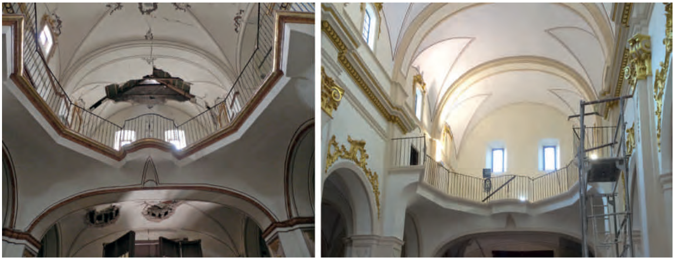
Figura 19. Estado en el que quedó la bóveda sobre el coro tras los terremotos (izquierda) y tras las obras de restauración (derecha). Fotografías: Juan de Dios de la Hoz.
