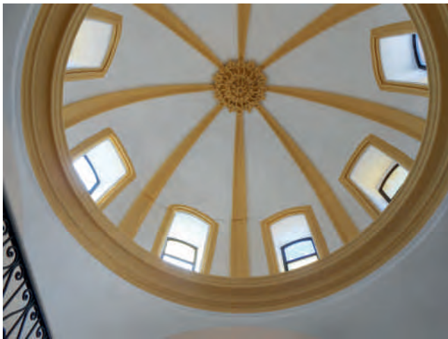
Figura 10. Daños del terremoto en la cúpula de la escalera principal.
