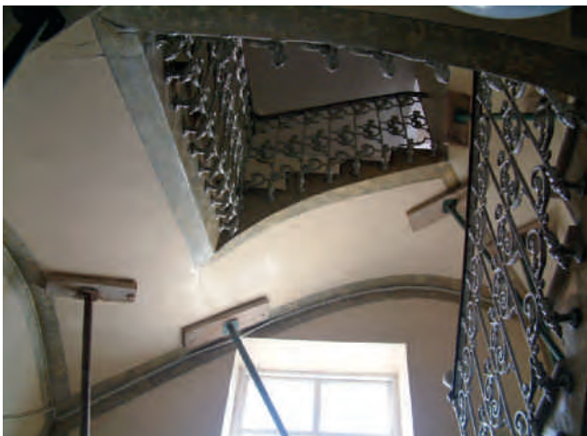
Figura 6. Diferentes tramos de la escalera agrietados sobre todo en los encuentros de las zancas con los descansillos.
