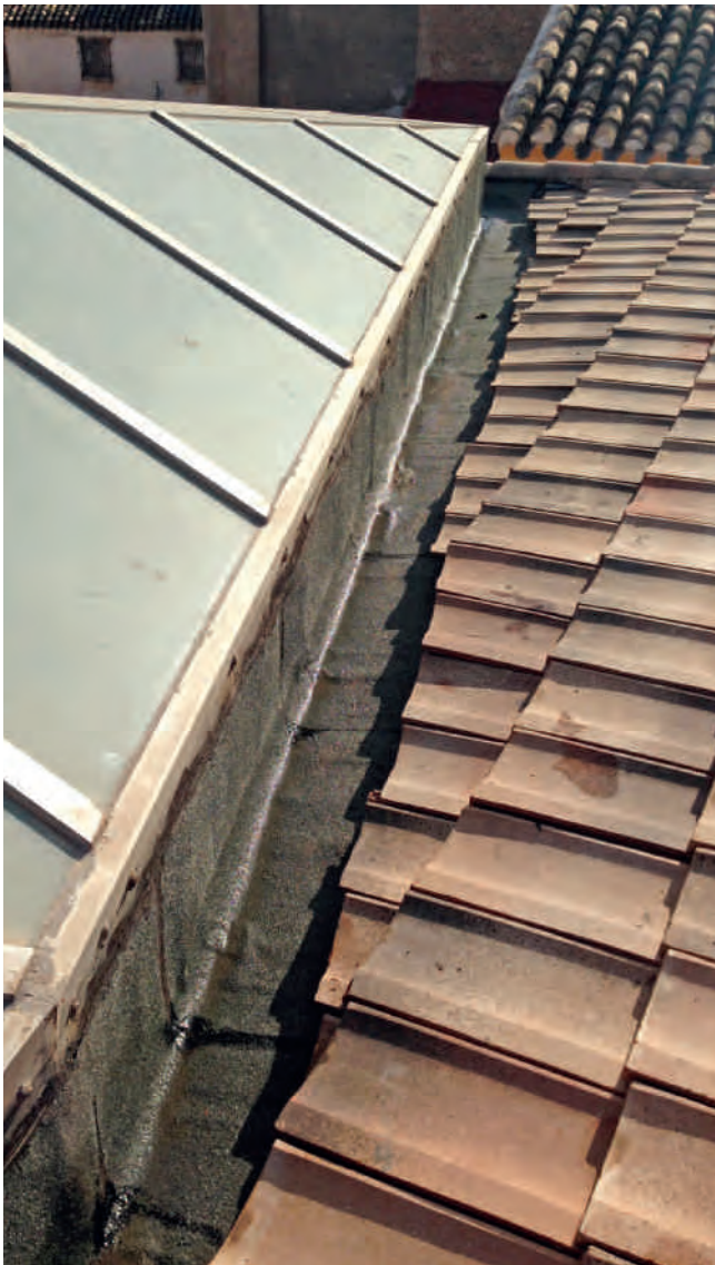
Figura 10. Canalón en encuentro entre paramentos.
