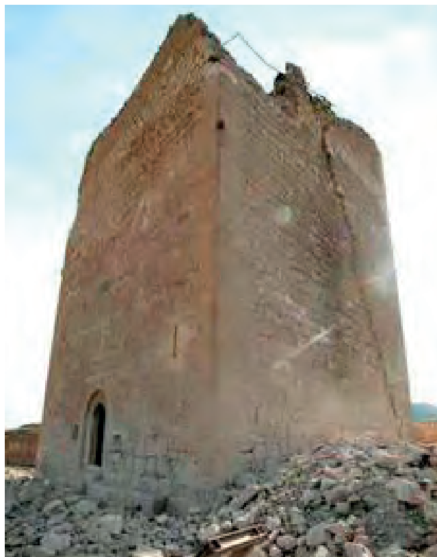
Figura 11. Estado de la torre del Espolón tras el seísmo.
