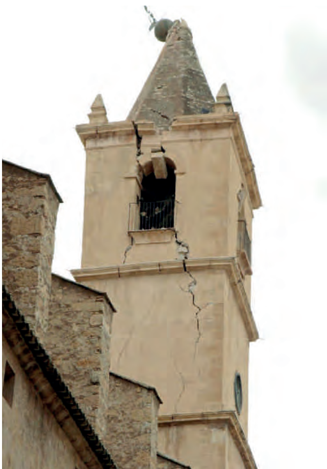
Figura 2. Torre de la iglesia de San Francisco tras el terremoto. Agencia EFE. 2011.
