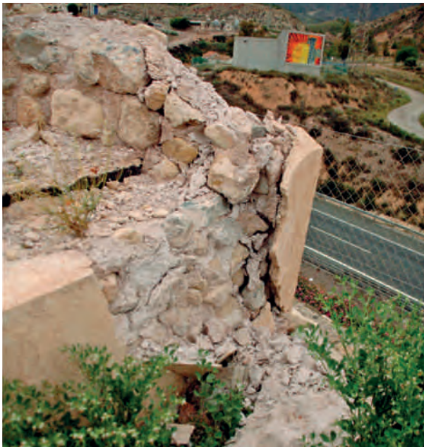
Figura 4. Esquina noreste. Caída de revestimientos y partes del muro.
