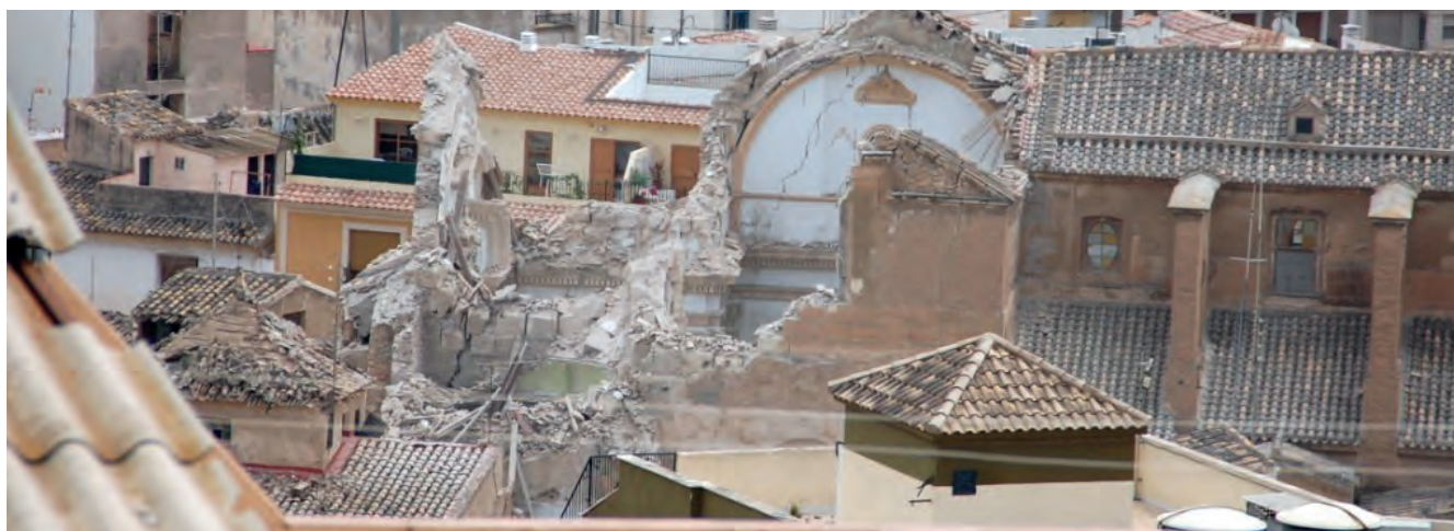
Figura 3. Colapso total, tras los seísmos, de la cúpula del crucero de la iglesia de Santiago, debido a la rigidez que le aportaba una nueva losa de cubierta, construida en hormigón armado (espesor medio 18 cm), realizada en una restauración anterior y colocada sobre sus estructuras leñosas originales. Fotografía: Juan de Dios de la Hoz.
