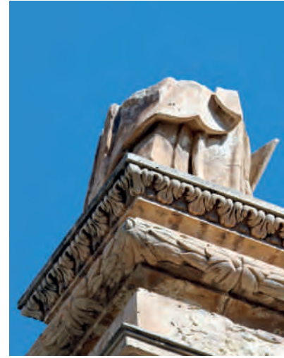
Figura 13. Desmontaje de los sillares desplazados de escultura del primer cuerpo de la fachada barroca de la colegiata.
