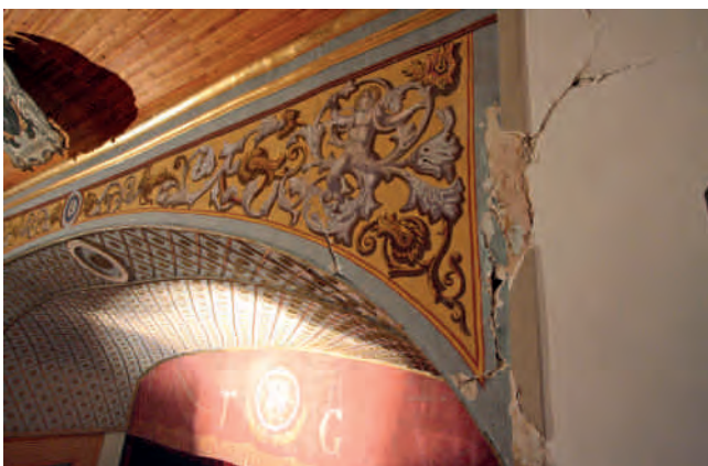
Figura 9. Agrietamiento y pérdida de material en la embocadura del escenario.
