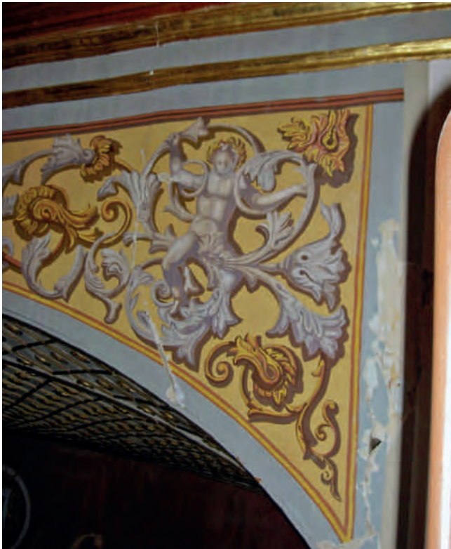
Figura 10. Agrietamientos en la embocadura del escenario.
