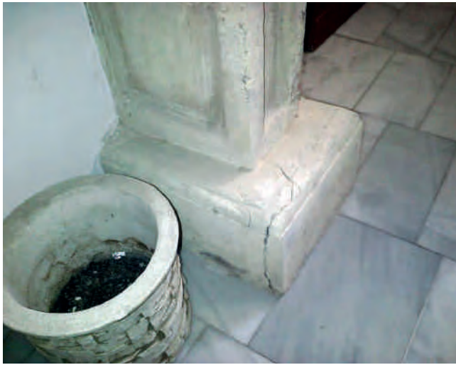
Figura 7. Daños en basas de soportes.
