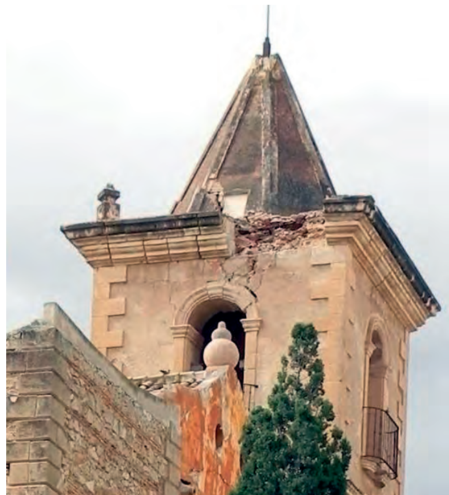
Figura 4. Imagen de la torre de San Mateo tras los terremotos. Se aprecia la rotura por su base del chapitel octogonal, la caída de grandes piezas de su cornisa superior, así como varios de los pináculos girados sobre su eje y otros caídos sobre la vía pública. Fotografía: Juan de Dios de la Hoz.
