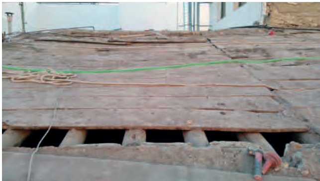
Figura 11. Detalle de estado del tablero de cubierta bajo la teja.
