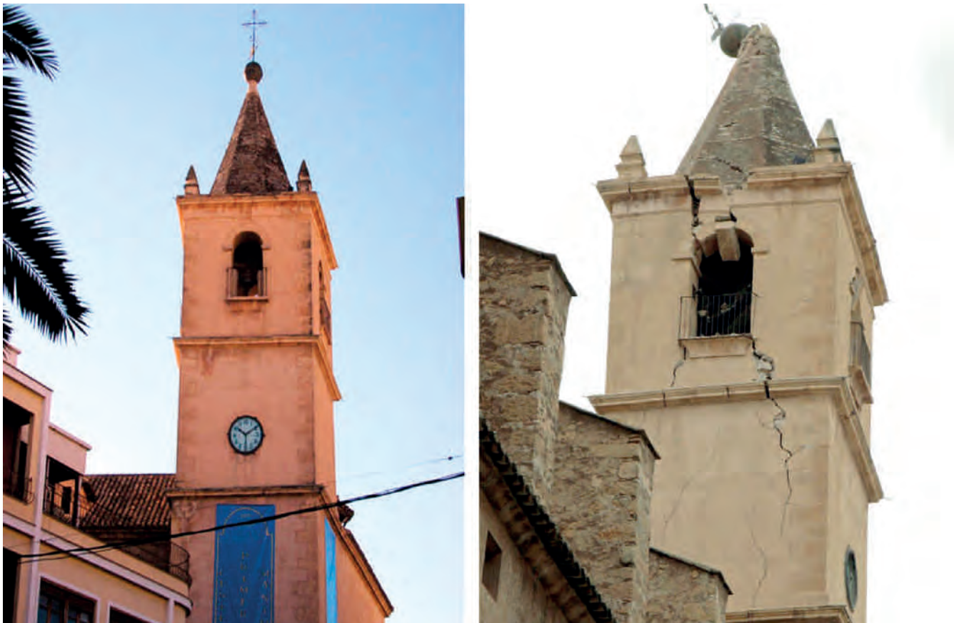
Figura 11. Torre de la iglesia del convento de San Francisco, antes y después del seísmo. Fotografías: Comunidad Autónoma Región de Murcia y Manuel Muñoz.
