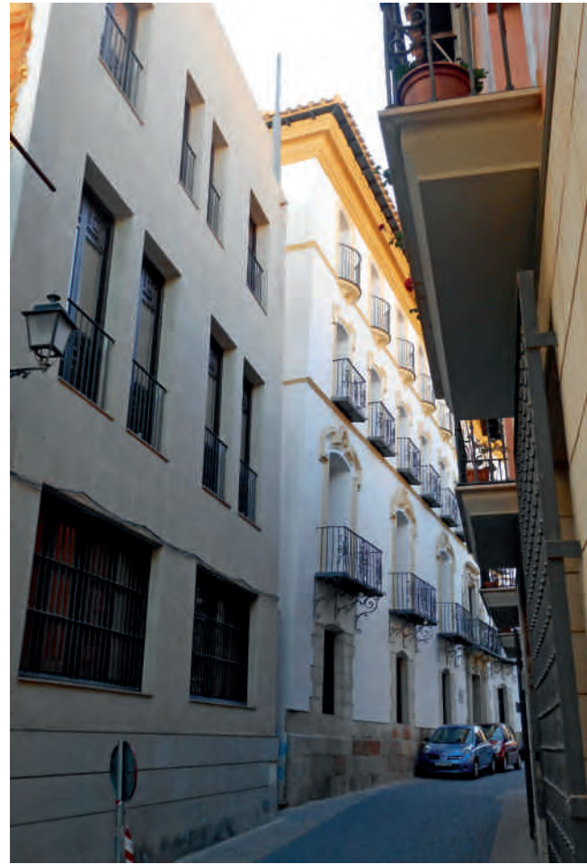
Figura 4. Desplome de la fachada principal hacia la calle Abad de los Arcos.
