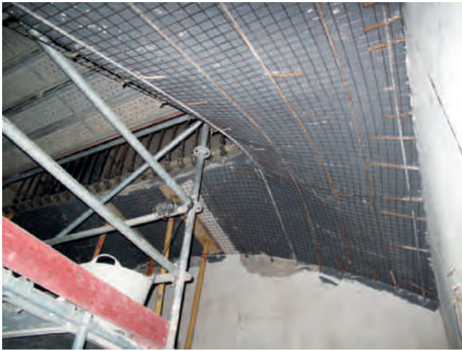
Figura 5. Colocación de armadura e el intradós de la bóveda del tramo de escalera a reforzar. Previamente se han colocado los anclajes a los muros laterales de carga.
