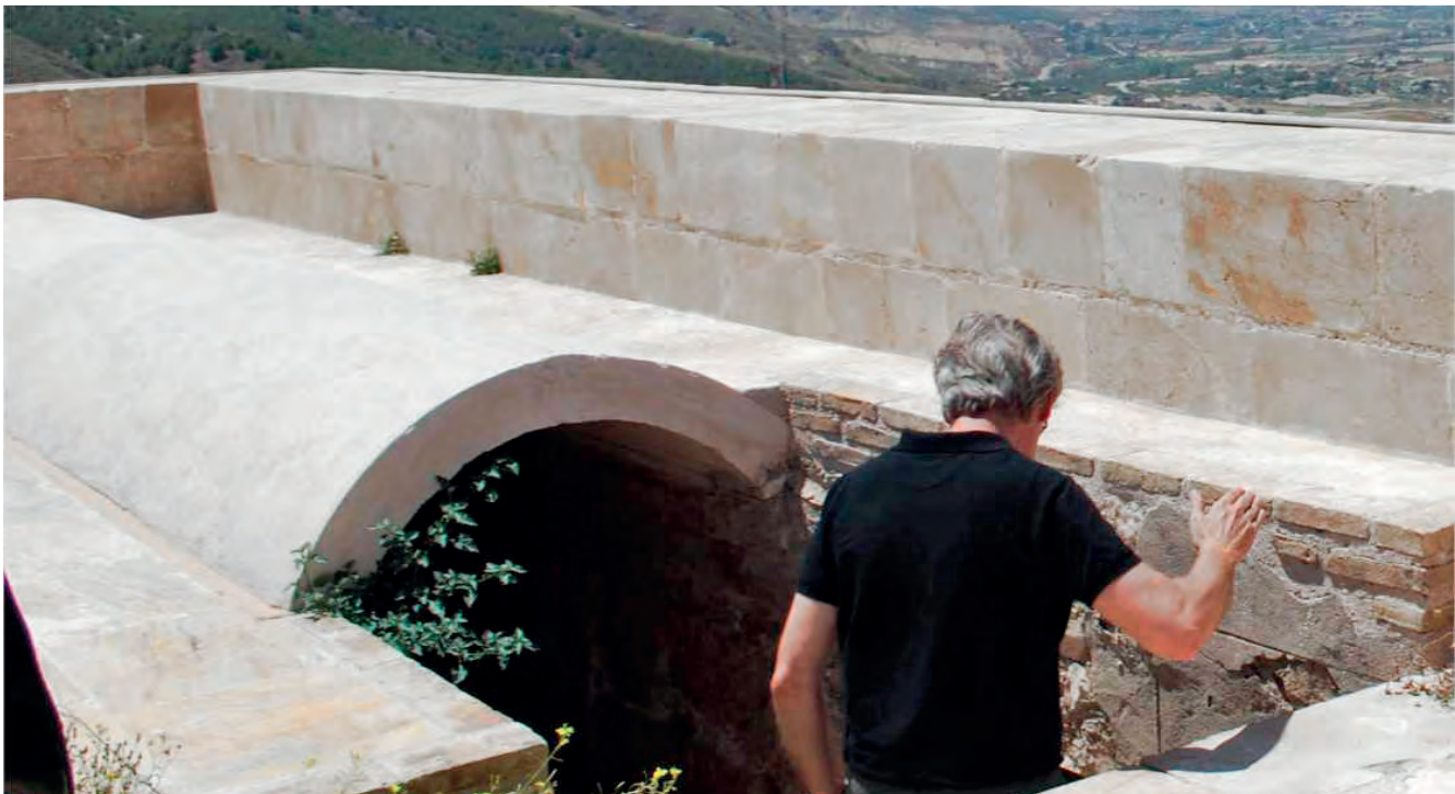
Figura 39. La bóveda reconstruida con hormigón de cal y el peto de sillares terminado. Dichos sillares tiene flejes interiores que los atan entre sí y también se ha dispuesto una pletina de acero inoxidable por encima del peto que ancla las piezas que, por su disposición, no pueden ser trabadas con el resto, en previsión de futuros seísmos.
