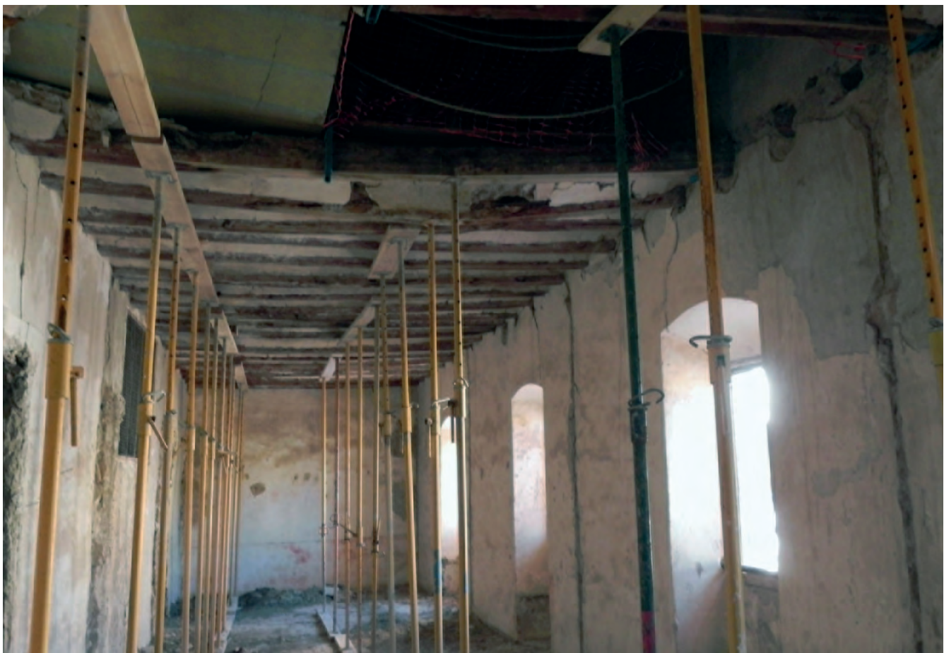
Figura 20. Uno de los forjados del cuerpo sobre la sacristía, en el estado que quedó tras los terremotos, con palos partidos y muy flectados, incluso rotos por el desplome tras recibir el impacto de la caída de la cubierta. Fotografía: Juan de Dios de la Hoz.
