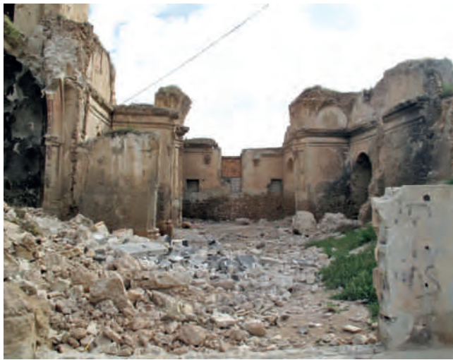
Figura 5. Situación de la iglesia unos días después del terremoto. Los escombros del suelo pertenecen a la única bóveda original que permaneció hasta nuestros días. Imagen tomada el 24 de mayo de 2011. Fotografía: José Manuel Chacón Bulnes.
