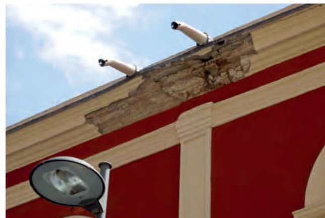
Figura 6. Cornisa rota en la fachada lateral derecha.
