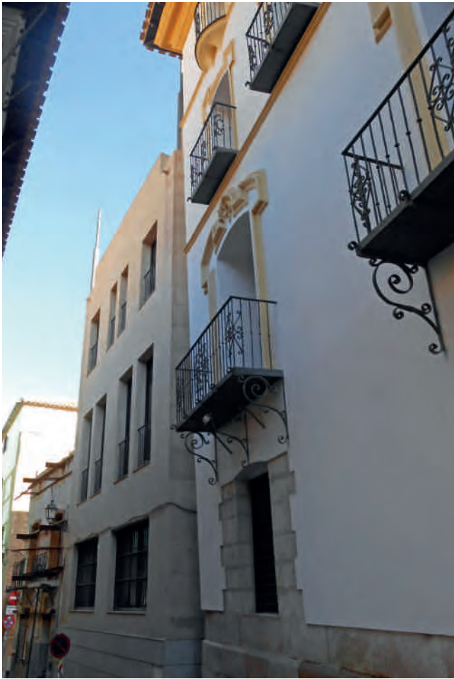
Figura 3. Fachada principal desplomada hacia la calle en su ala norte.
