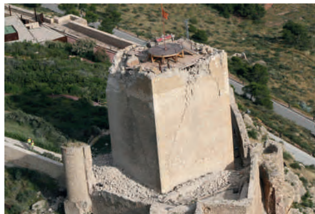
Figura 10. Colapso parcial elementos constructivos en patrimonio.
