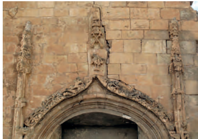
Figura 3. Imagen del acceso con grietas sobre el arco de entrada. Fotografías: realizadas el 17 de mayo de 2011. Fotografía: José Manuel Chacón Bulnes.
