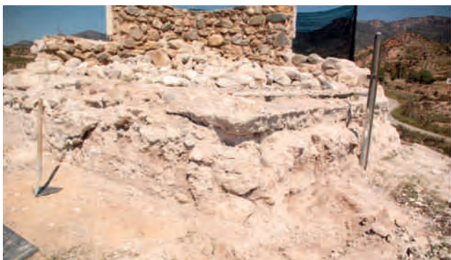
Figura 12. Pérdida de revestimiento.
