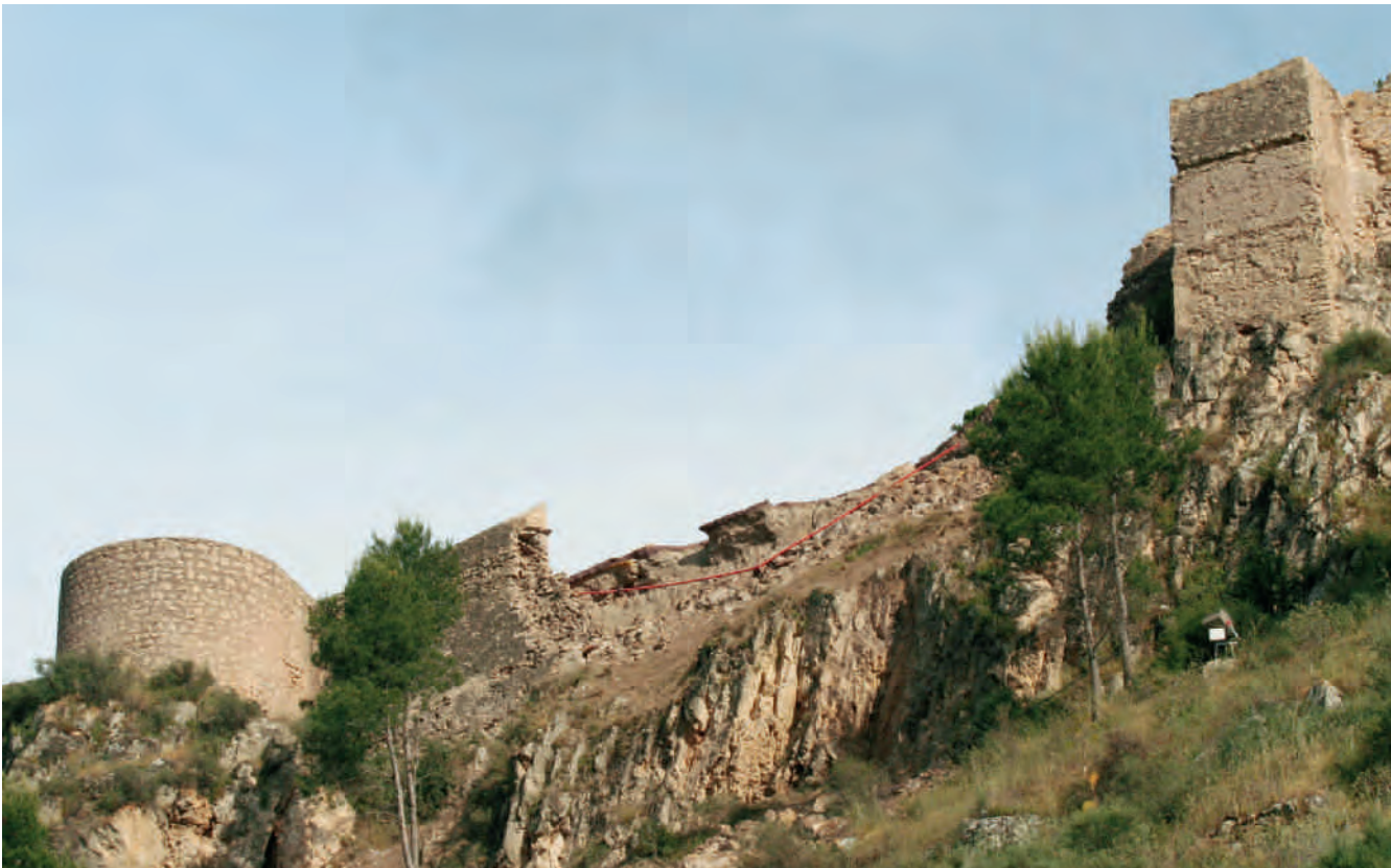
Figura 1. Desplome hacia la ladera de uno de los lienzos de la muralla.
