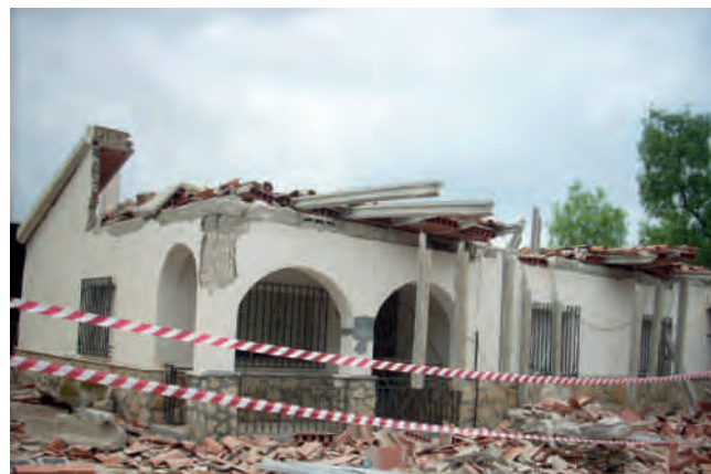
Figura 9. Colapso parcial elementos constructivos en viviendas.
