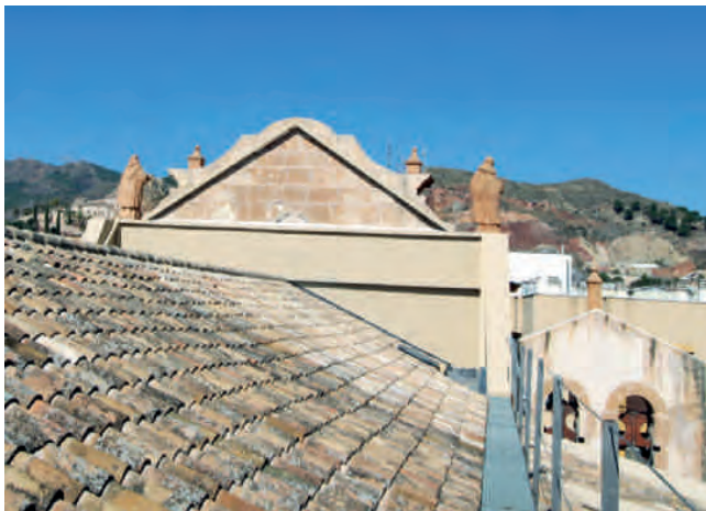
Figura 14. Vista de la parte trasera del tímpano de la fachada principal, en la que se aprecia la nueva estructura a base de perfiles tubulares y UPN 200 y pletinas metálicas, para disminuir su vulnerabilidad sísmica. Fotografía: Carmen Martínez Ríos.
