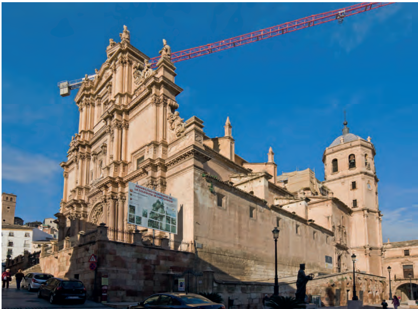
Figura 8. Colegiata de San Patricio durante las obras de restauración. Fotografía: José Luis Municio.
