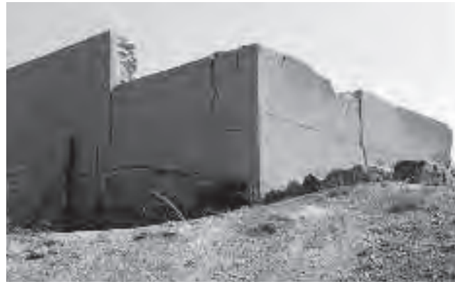
Figura 2. Primeros deterioros en las esquinas suroeste y sureste aparecidos tras la primera intervención.
