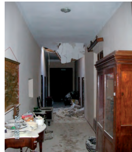
Figura 5. Caída de falsos techo.
