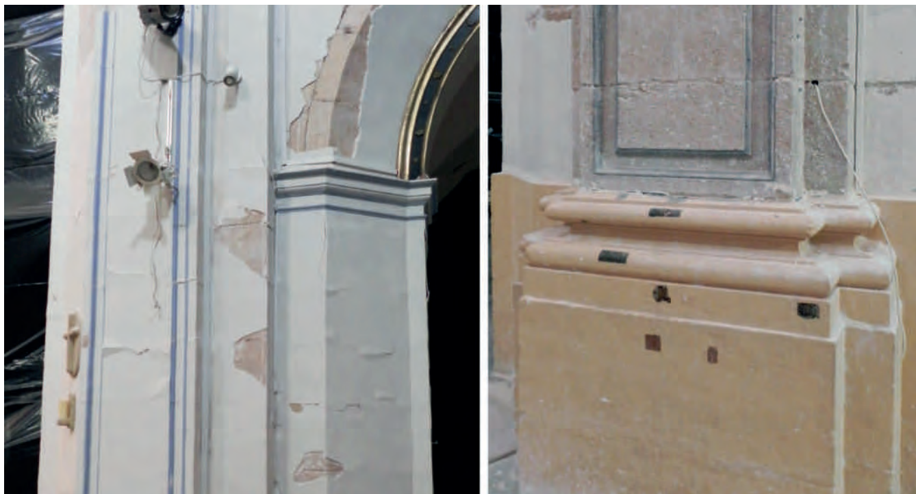
Figura 12. Dos imágenes de los restos de pintura en el interior del templo. La primera con el estado tras el terremoto y la siguiente una vez retirados los yesos del fuste, quedando vista la fábrica y apareciendo parte de las policromías dadas sobre la piedra. Posteriormente, se amplió este levantado de pinturas a los zócalos. Fotografías: Juan de Dios de la Hoz.
