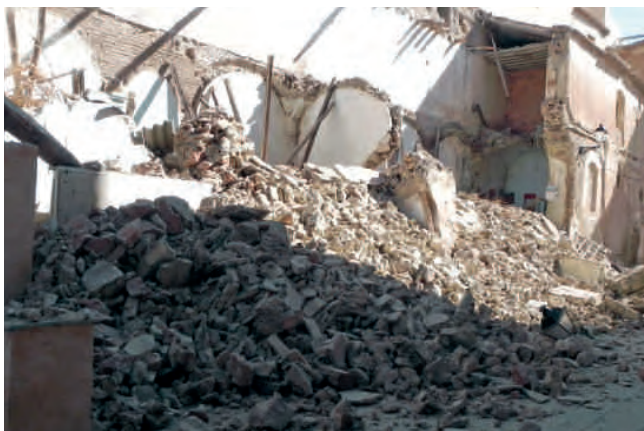
Figura 22. Estado de la Panda norte del claustro, tras su desplome.
