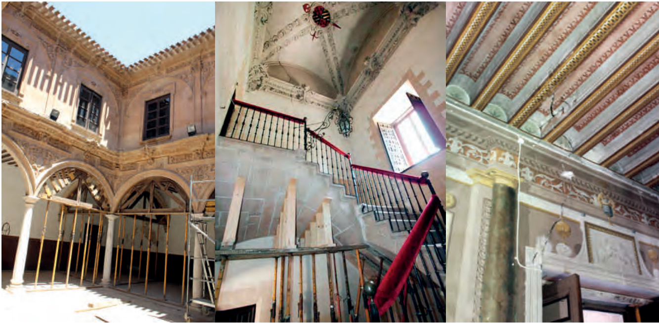
Figura 5. Apeos de patio, escalera y daños de revestimientos.
