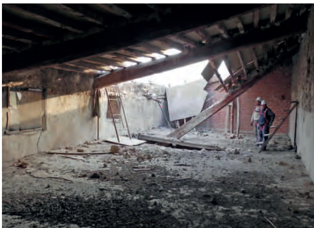
Figura 15. Desplome parcial de la cubierta del cuerpo sobre la sacristía por rotura en el apoyo inferior de una de las grandes vigas.
