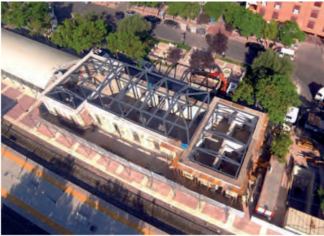
Figura 7. Vista aérea con la estructura metálica en ejecución. Fotografía: F. J. García Carreras.
