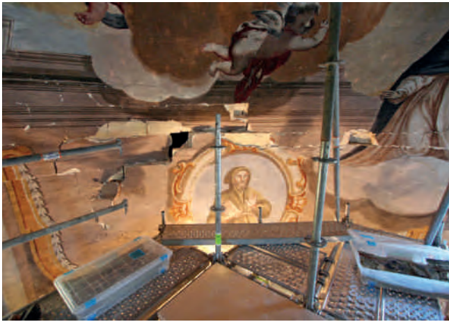
Figura 7. Daños en la cúpula de la capilla del Rosario.
