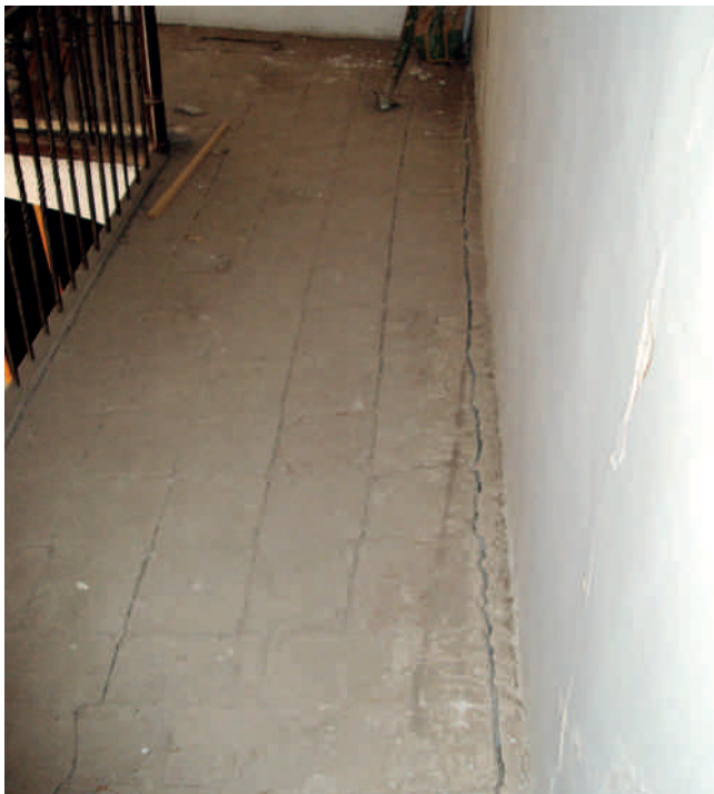
Figura 12. Separación bóveda escalera-muro de apoyo. Rotura bóveda catalana.
