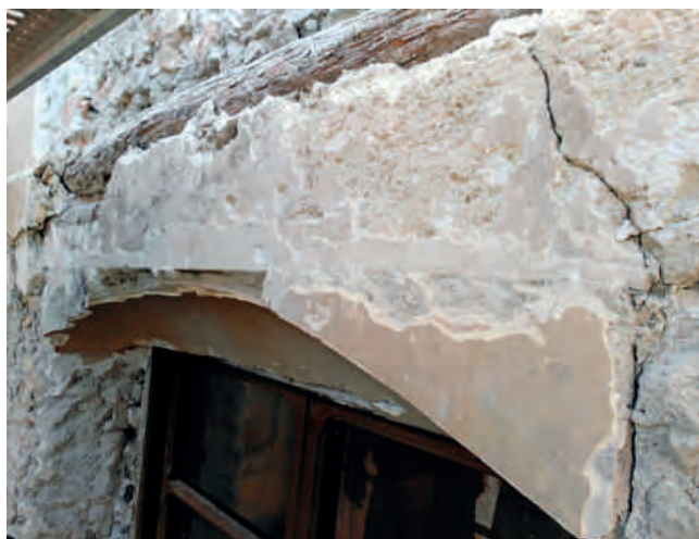
Figura 13. Detalle de deformación de hueco.
