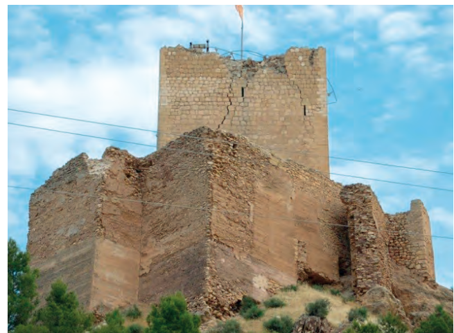
Figura 11. La torre tras el segundo movimiento sísmico donde cayeron todas las almenas y se abrió una importante grieta.
