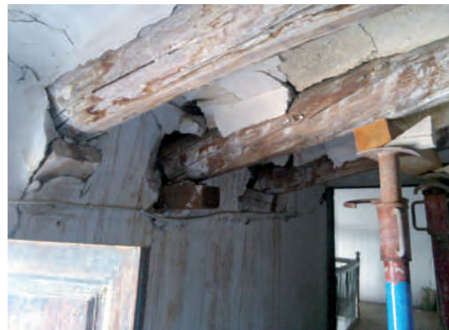
Figura 15. Daños en cubiertas.
