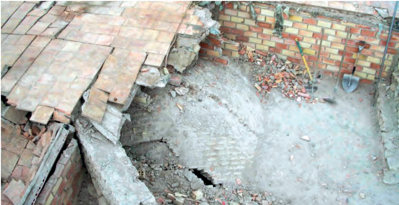
Figura 18. Cubierta a la catalana destruida y supradós de las bóvedas fracturadas.
