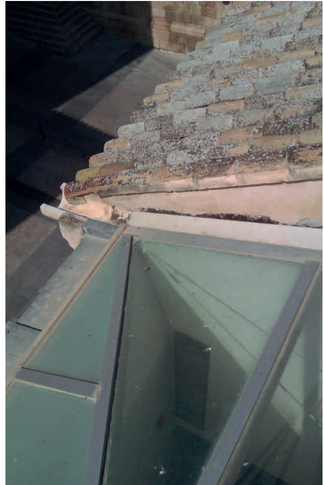
Figura 9. Filtraciones en encuentro entre paramentos.
