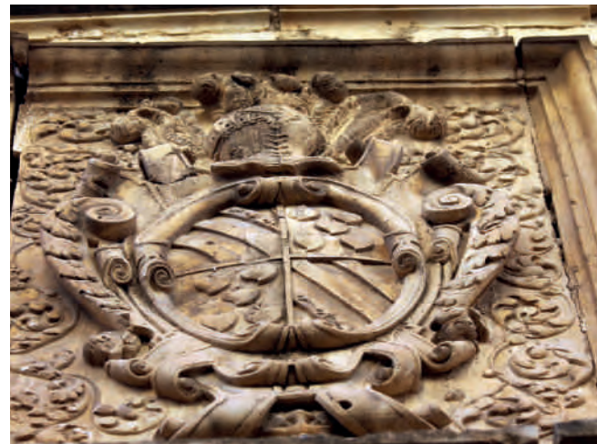
Figura 10. Apertura de juntas de los sillares del escudo de fachada de casa Guevara.
