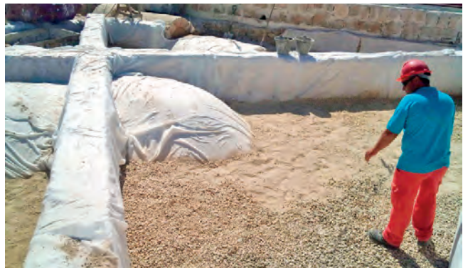
Figuras 20 y 21. Las bóvedas se refuerzan en su trasdós con un mortero de cal en el que se mezcla fibra de polipropileno. Después se acabará macizando todo el volumen superior zahorra y cal mezclada en seco. Un geotextil separa la capa de material que hemos añadido en nuestra restauración.
