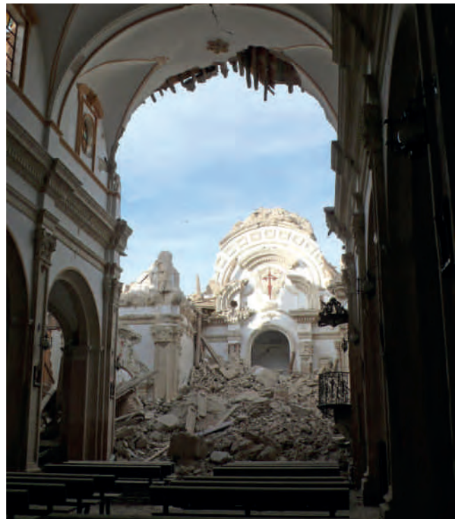
Figura 5. Iglesia de Santiago tras el terremoto. Fotografía: C. Cirujano.
