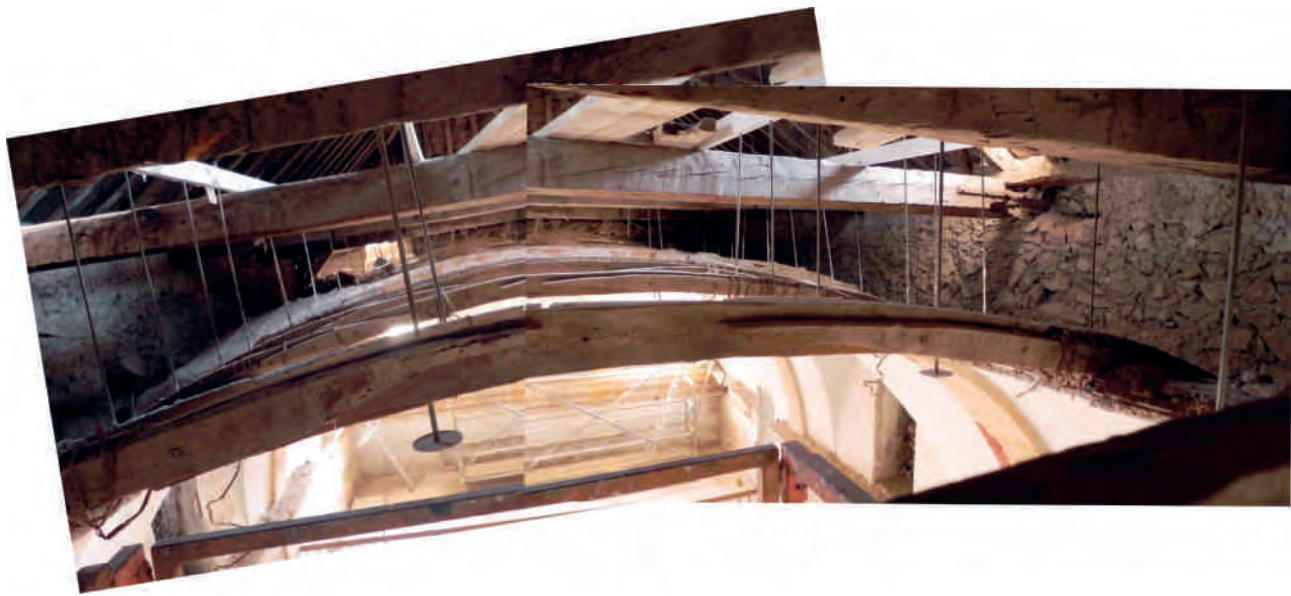
Figura 4. Montaje fotográfico donde se aprecia el estado en el que quedó la bóveda de la nave central a los pocos días de los terremotos. Todas estas estructuras horizontales sufrieron enormes esfuerzos, quedando en ocasiones en precario equilibrio. En este caso, el cañizo y el yeso de toda la bóveda hubieron de retirarse al encontrarse irre recuperables. Fotografías: Luis de la Hoz.
