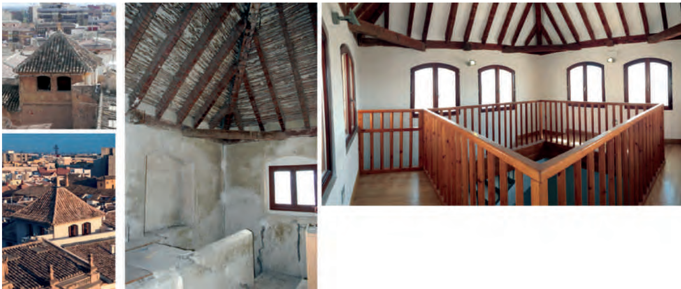
Figura 16. Imágenes comparativas (tanto del interior como del exterior del edificio), con los estados previos y finales de la parte superior del torreón que alberga la escalera del inmueble, una vez recuperadas las armaduras, cubiertas, remates, revocos y carpinterías. Fotografías: Juan de Dios de la Hoz.
