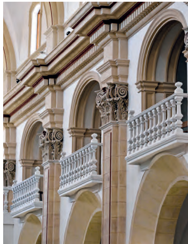
Figura 14B. Imagen con el estado de los paramentos de la nave central una vez recuperadas las fábricas de sillería y ejecutados los trabajos de pintura y patinado. Fotografía: Joaquín Zamora.
