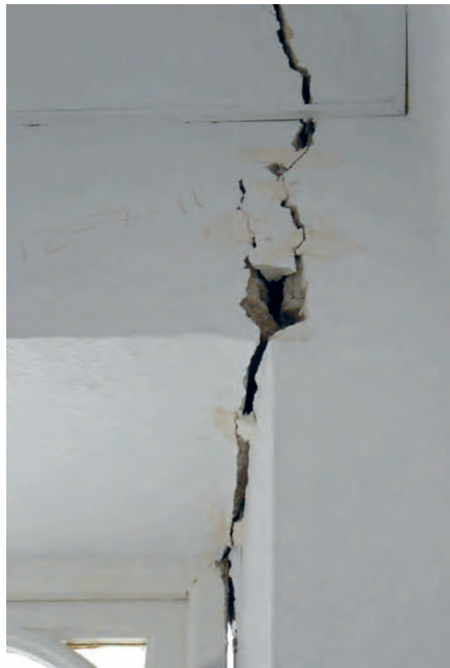
Figura 17. Daños en dependencias de la planta noble.
