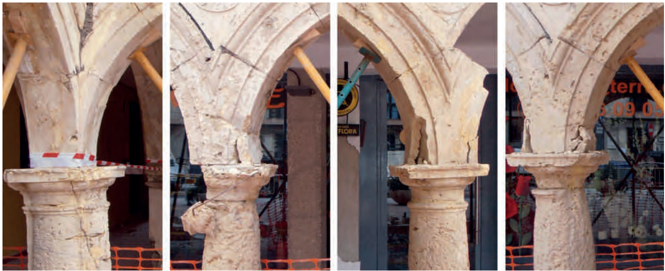
Figura 6. Estado de los salmeres del lado este del claustro bajo. Fotografía: JCC.
