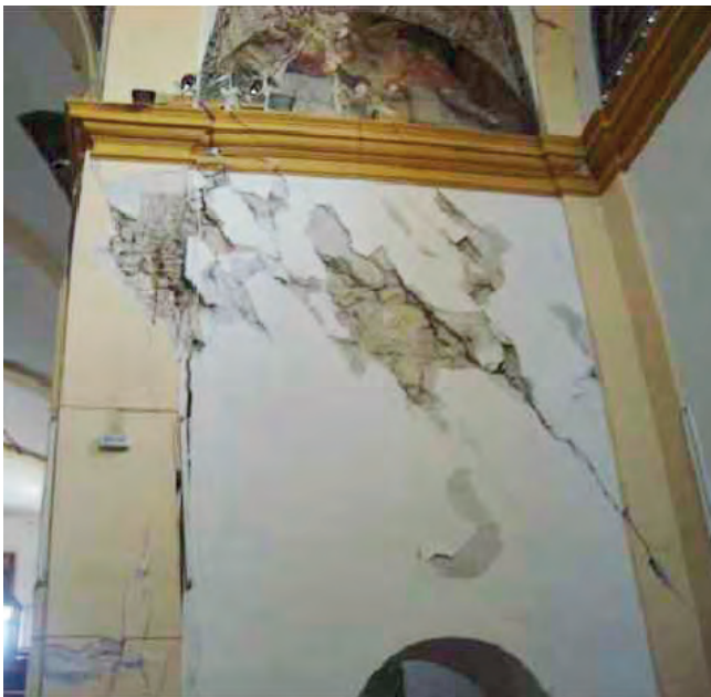
Figuras 17 y 18. Agrietamientos en el crucero del templo.
