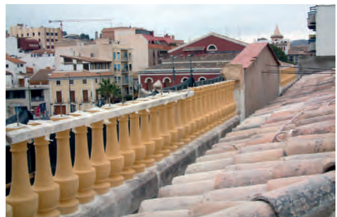
Figura 11. Colocación de los balaustres de la cubierta, falta colocar el pasamanos de piedra.
