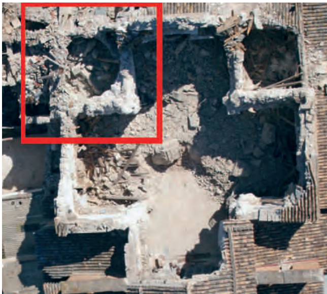
Figuras 21. Vista aérea del templo tras el terremoto. Se ha resaltado la capilla del Sacramento, en el lateral del Evangelio, tal y como quedó tras el derrumbe de su cúpula y la cubierta. Fotografía: Lorquimur.
