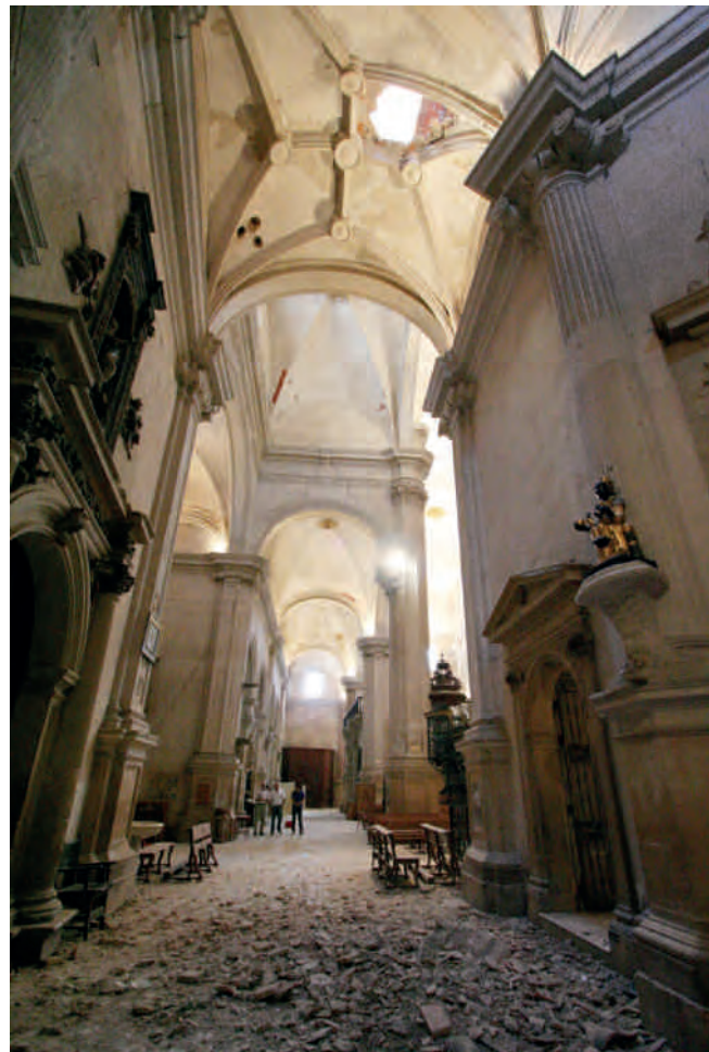
Figura 3. Caída de uno de los florones de la torre en el interior de la Girola, atravesando la cubierta y la bóveda. Fotografía: Carmen Martínez Ríos.
