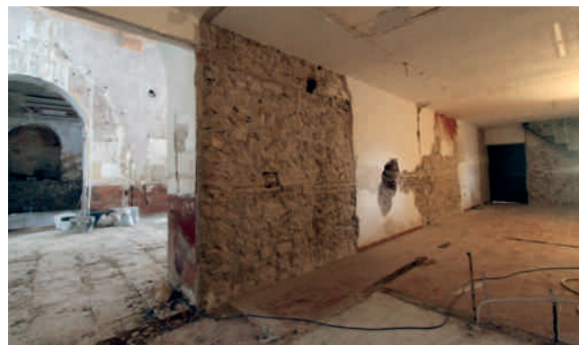
Figura 8. Imagen donde se aprecia la existencia de la fábrica de la antigua fachada exterior de la nave central, en su lado del evangelio. Se trata de mampostería ordinaria, con machones y verdugadas de ladrillo, además de presentar distintos restos y huecos originales, correspondiente a diferentes momentos de uso del edificio (arcos, zócalos, mechinales, etc.). Fotografía: Carmen Martínez Ríos.
