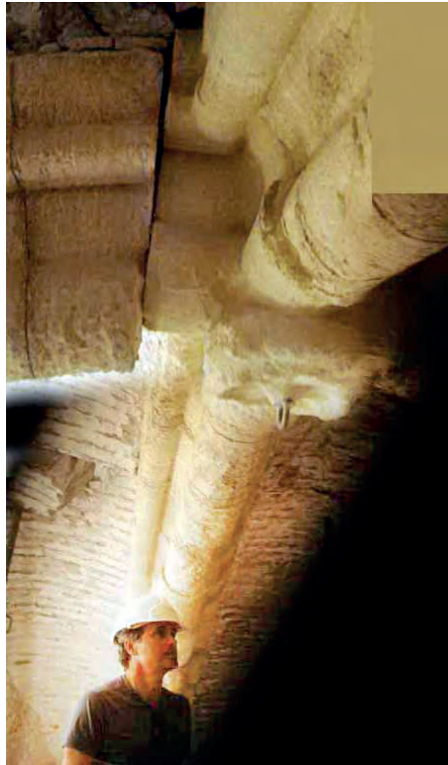
Figura 26. Desplazamiento de una dovela de piedra de unos 60 cm de canto. Se queda comprimida en esta posición, al no poder introducirse materialmente nada en la junta, ni ser necesario al presentar un plano de contacto continuo.
