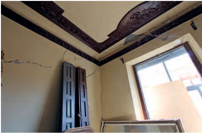
Figura 15. Daños en el Senado, en la planta noble, con fachada a Pío XII.
