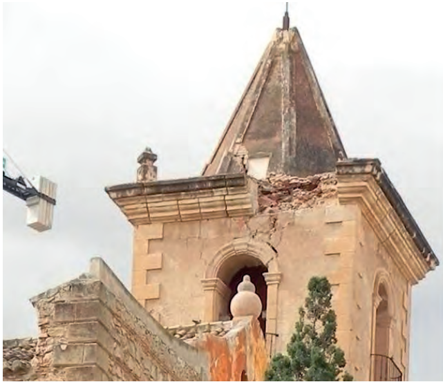
Figura 1. Torre de la iglesia de San Mateo tras los terremotos, con graves desplazamientos de sillares de su cornisa. Fotografía: Juan de Dios de la Hoz.
