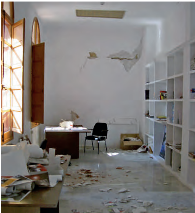
Figura 12. cascotes caídos de falsos techos y paredes.
