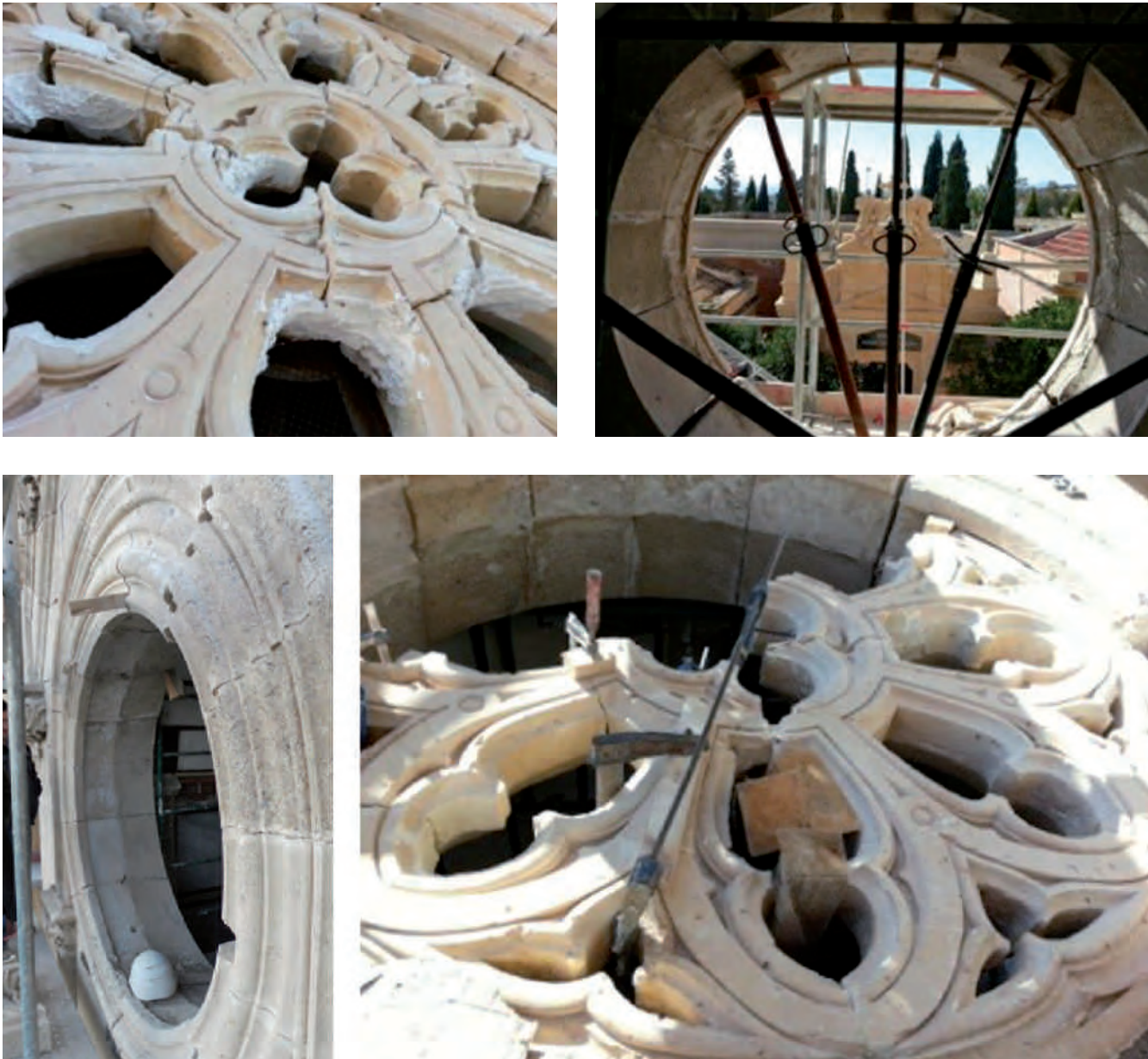
Figura 7. Cuatro fases de la recuperación de la tracería del óculo. Estado inicial tras los terremotos; desmontado y apuntalado interior; completamente consolidado en todas las piezas (hemos dejado en la fotografía un casco, para que se pueda relacionar la escala del elemento constructivo); durante el montaje de cada una de las piezas de tracería. Fotografías: Reyes Molina.
