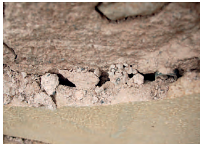
Figura 11. Separación del revestimiento del soporte.
