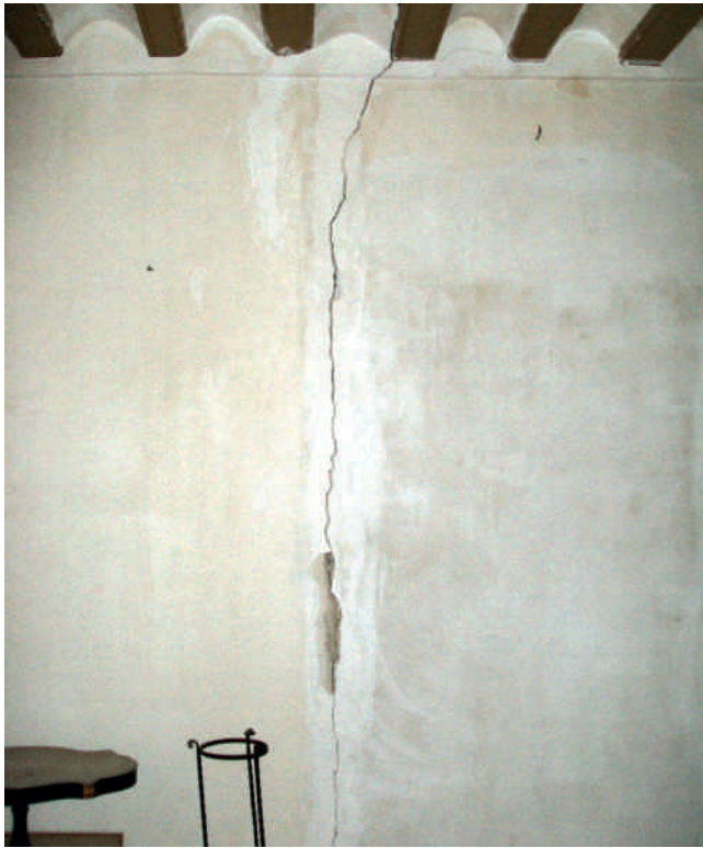
Figura 11. Grieta vertical vuelco de la edificación.
