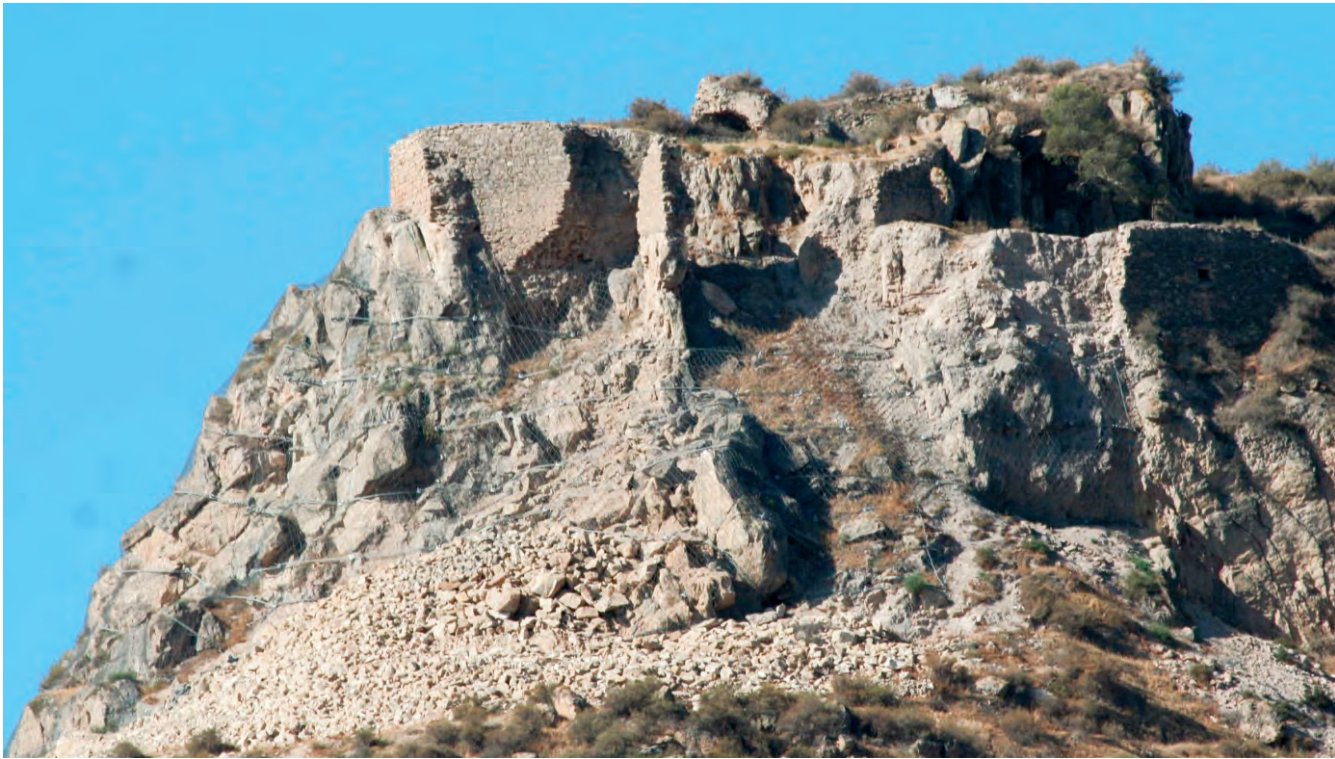
Figura 45. Extremo este de las murallas en la zona delante de la ermita de San Clemente en el año 2013.
