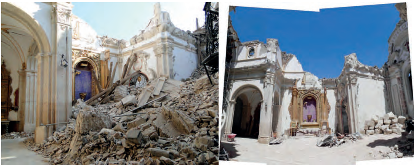
Figuras 6. A la izquierda, vista interior del lateral del Evangelio con la montaña de escombros acumulados (se aprecian restos de fábricas y acabados, pero no de tejas, ni de la estructura de la cubierta, pues quedaron en gran parte en la zona inferior del derrumbe). A la derecha, una vez retirados estos, se aprecia la completa destrucción de todo el templo, desde el nivel de las cornisas hacia arriba. También los muros más dañados, correspondientes a los laterales de la capilla del Sacramento, pues fueron quienes recibieron el mayor impacto. Fotografías: Juan de Dios de la Hoz.
