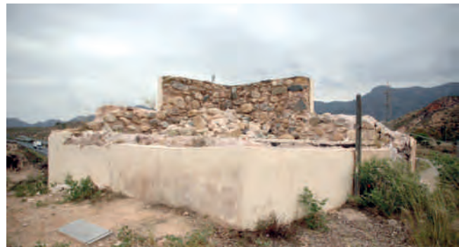
Figura 4. Estado de la torre tras las distintas actuaciones. Se observa la reducción en altura con respecto a la primera intervención, el revestimiento exterior y los problemas de humedad en las caras sur y este.
