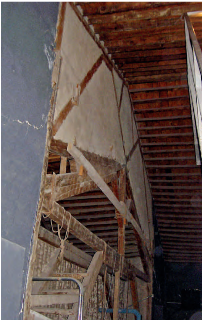
Figura 8. Agrietamiento en el tabicado de cercha sobre la embocadura del escenario.
