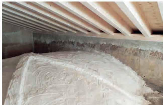
Figura 9. Imagen del trasdós de una de las bóvedas ya reparada de la nave lateral, así como los nuevos pares y durmiente de la armadura de madera que sustituye al forjado de viguetas de hormigón pretensado, bovedilla cerámica y capa de compresión anteriores. Fotografía: Juan de Dios de la Hoz.
