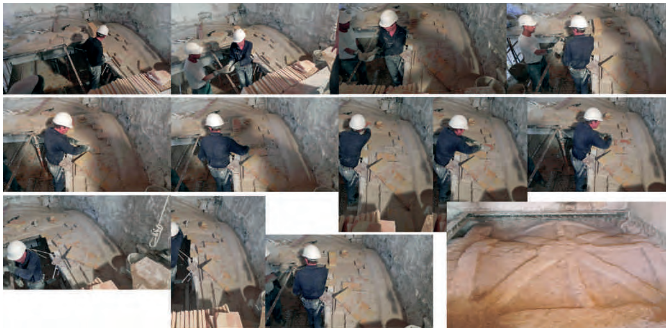
Figura 10. Secuencia de imágenes que muestra la reconstrucción, mediante el empleo de técnicas y materiales tradicionales, de una de las bóvedas del claustro. Fotografías: Juan de Dios de la Hoz.
