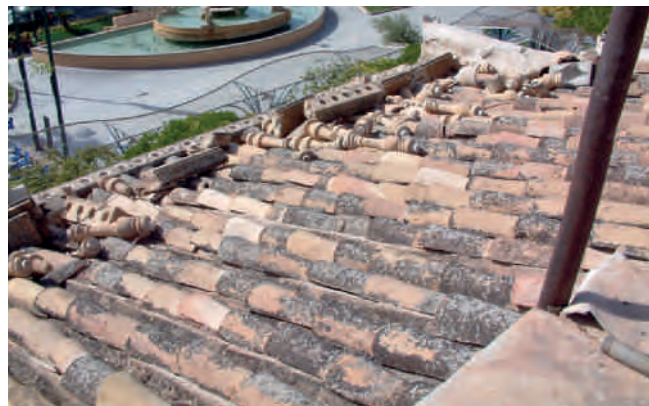
Figura 3. Situación de la balaustrada que coronaba el alero de la cubierta, tras el sismo.
