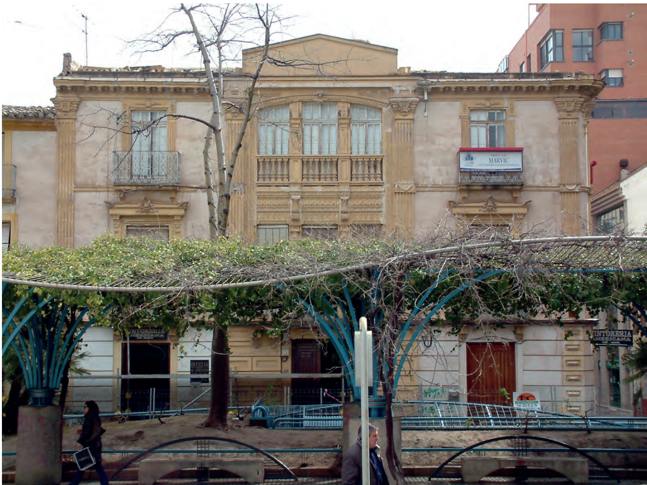
Figura 4. Fachada a la plaza de Colón con la balaustrada caída.
