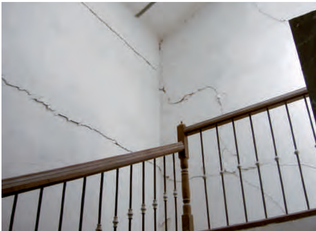
Figura 15. Agrietamiento de tabiquería en la escalera de la vivienda.
