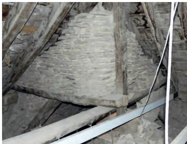
Figura 11. Imagen donde se aprecian los dos muros interiores de la torre, que se sustentaban de forma absolutamente precaria, sobre un brochal apoyado a su vez en un tirante o apoyando directamente sobre la cubierta. Fotografías: Juan de Dios de la Hoz.
