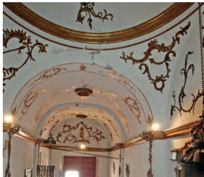
Figura 6. Grietas en arcos fajones y cúpula.
