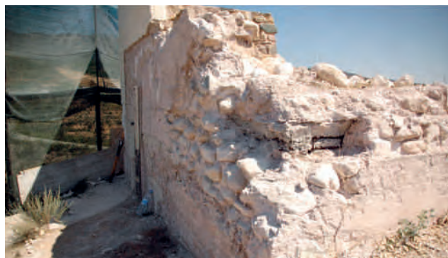
Figura 13. Desprendimiento de piedra en muros.
