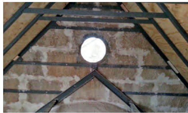
Figura 4. Imagen exterior e interior de la estructura metálica de cubierta del panteón, sobre la que monta la crestería. Fotografías: Reyes Molina.
