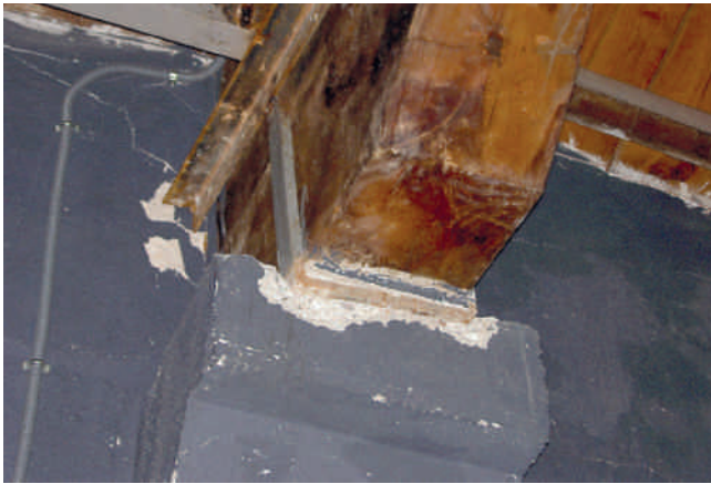
Figura 13. Pérdida de masa en ménsula de hormigón por apoyo de cercha.
