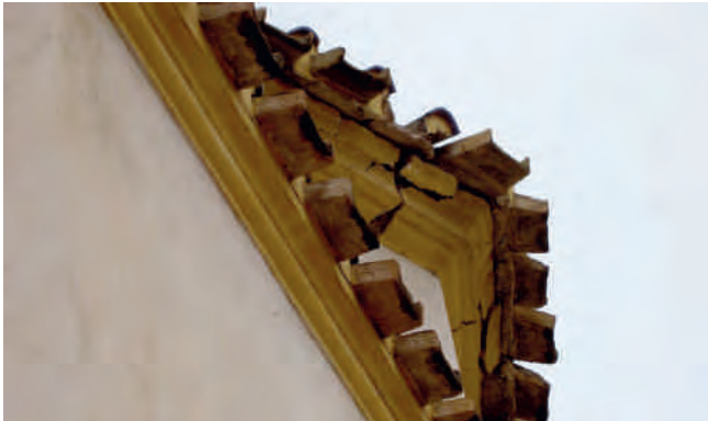
Figura 8. Daños del terremoto en el alero del tambor de remate del torreón.
