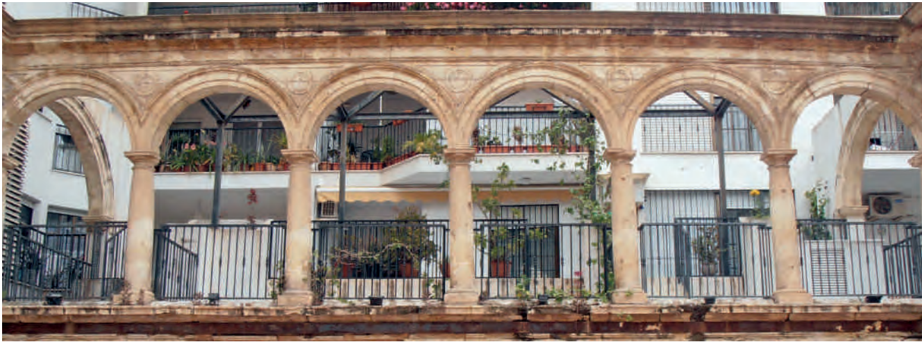
Figura 5. Arcada superior del alzado Este, con las estructuras auxiliares, zunchos y anclajes metálicos corroídos. Fotografía: JCC.
