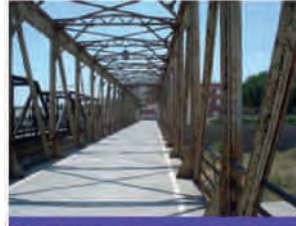
16. Pasarela peatonal. Elemento interesante, antiguo puente para el tren y actualmente de acceso peatonal. Sin embargo se encuentra en mal estado y no puede cumplir su función de comunicación por encontrarse con la barrera del centro comercial.
