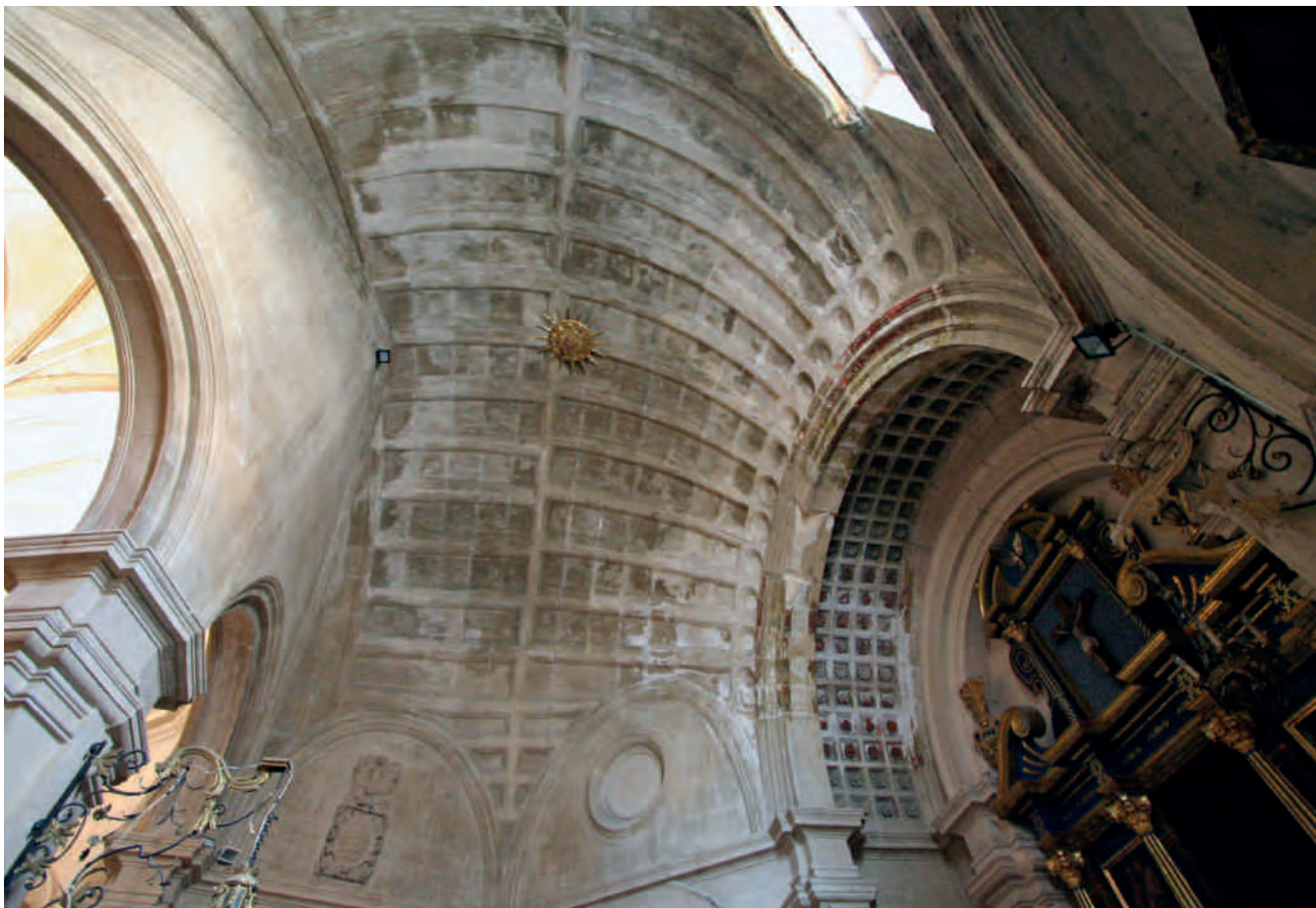
Figura 6. Daños en la bóveda de cantería de la capilla de la Virgen del Alcázar, en San Patricio.
