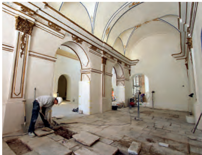
Figura 15. Trabajos para la limpieza y recuperación del solado de piedra dolomítica de gran espesor, manteniendo más del ochenta por 100 de las piezas (incluso aquellas rotas o partidas) con un ligero apomazado y rejuntado general.
