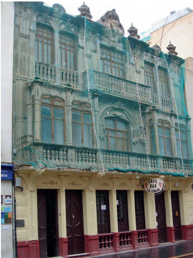
Figura 4. Fachada antes de la intervención, 2010.
