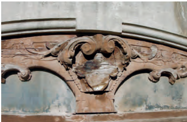
Figura 17. Estado original de elementos ornamentales de carpintería.
