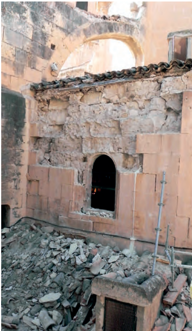
Figura 4. Muro de la girola de San Patricio, con grandes desplomes y caídas de sillares de la hoja exterior. Fotografía: Carmen Martínez Ríos
