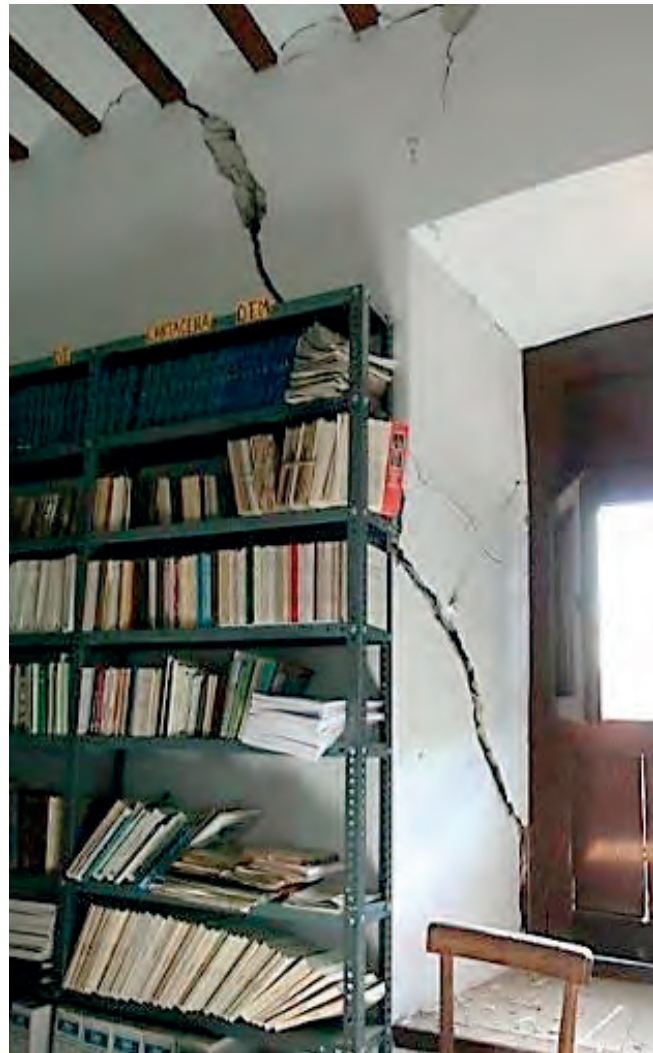
Figuras 19 y 20. Agrietamiento horizontal en la parte noroeste de la cúpula central y en la esquina noroeste del templo.
