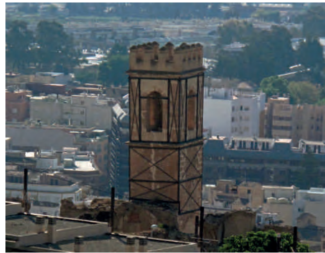
Figura 6. Situación de la iglesia tras las operaciones de zunchado de la torre. Imagen tomada el 2 de mayo de 2011. Fotografía: José Manuel Chacón Bulnes.
