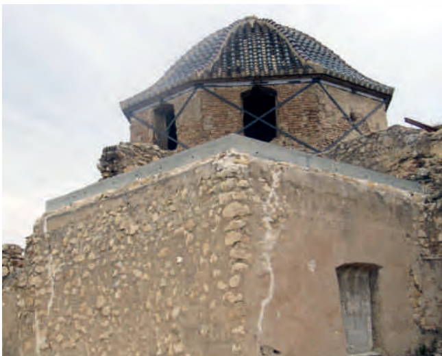
Figura 6. Vista de los refuerzos en la coronación de muros y zunchado del tambor del crucero.
