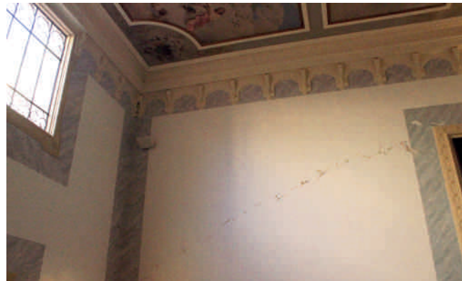
Figura 8. Grietas y fisuras horizontales en paramentos de caja de la escalera.
