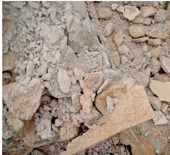
Figura 5. Desplome y desprendimientos de material en la esquina noreste.
