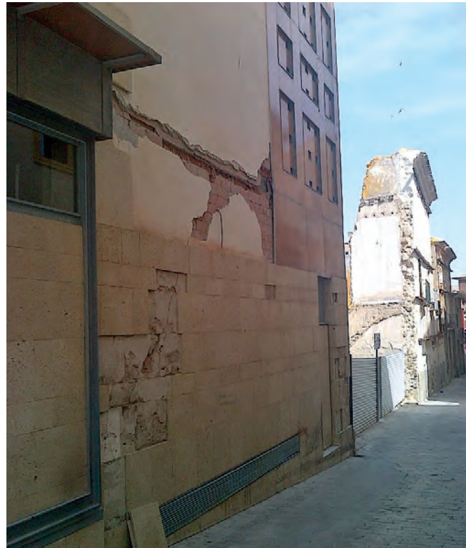
Figura 13. Piezas de aplacado de fachada desprendidas.
