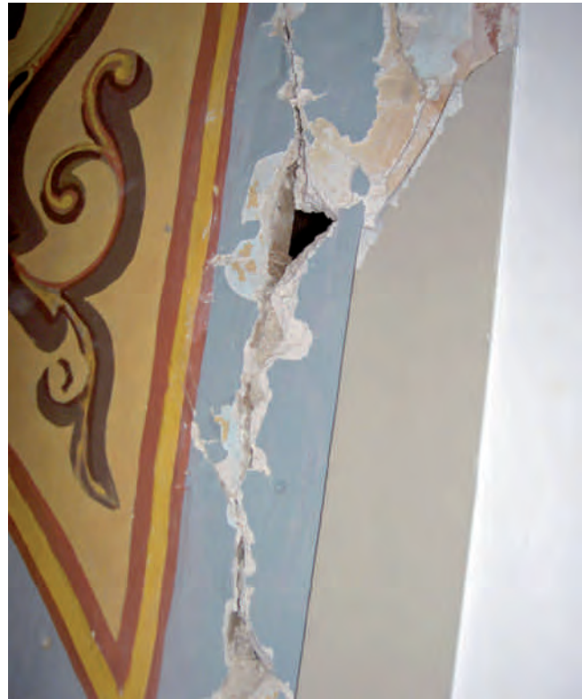
Figura 11. Detalle de pérdida de material en la embocadura del escenario.
