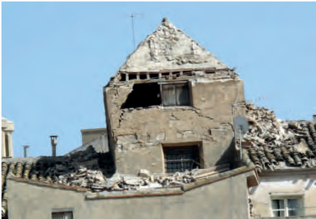
Figura 10. Estado de la torre. Desplome, rotura y caída de material de cubrición: tejas, aleros, veleta, etc.
