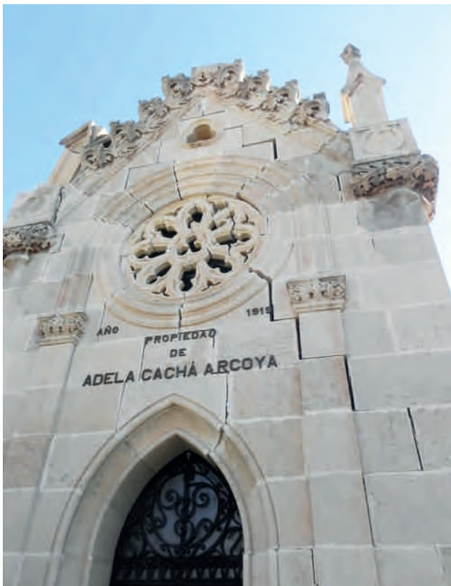
Figura 3. Imagen tras el terremoto, con la aparición de grandes grietas y desplazamiento de sillares en la fachada principal. Fotografía: Reyes Molina.
