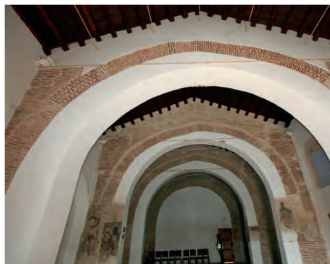
Figuras 15 y 16. Pequeños daños en arcos diafragma.
