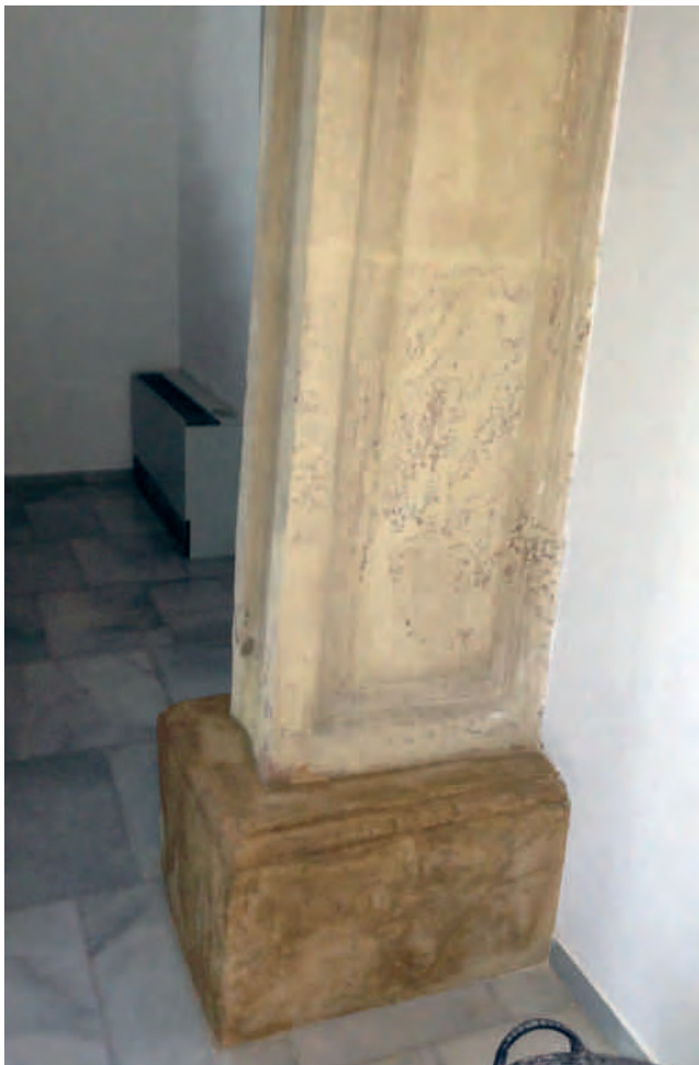
Figura 8. Daños en soportes y pilastras.
