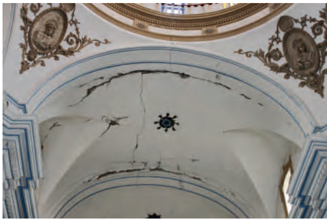
Figura 13. Iglesia de San Mateo tras la restauración y daños en bóvedas. Fotografía: Carmen Martínez Ríos.
