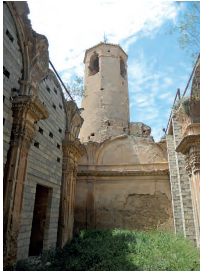
Figura 3. Vista interior de la nave, con la torre campanario al fondo, previo a la intervención.
