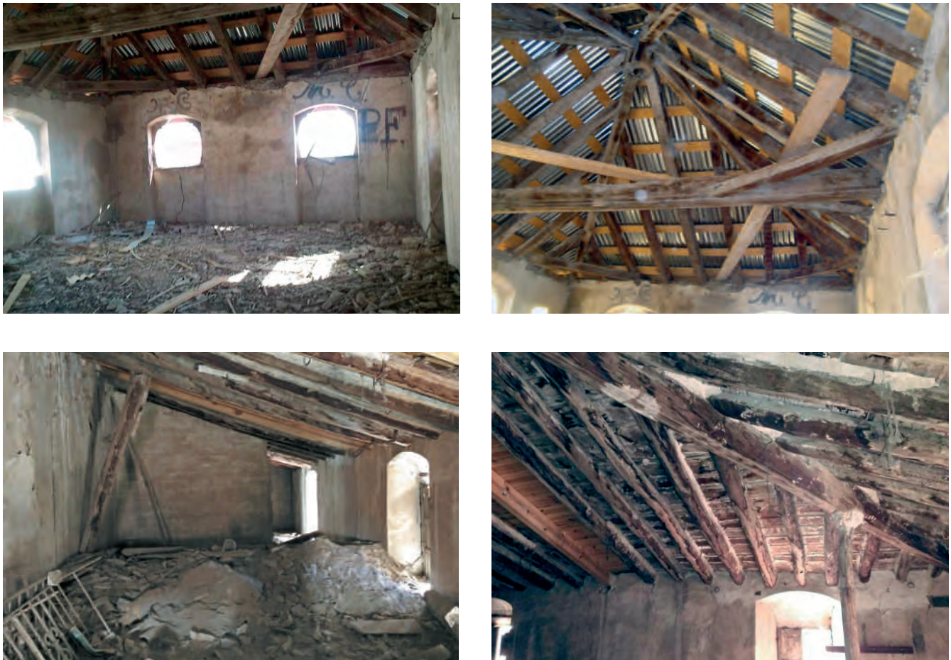
Figura 21. Detalles de la estructura de madera del torreón y situación tras los terremotos con la cubrición provisional de protección de chapa metálica.
