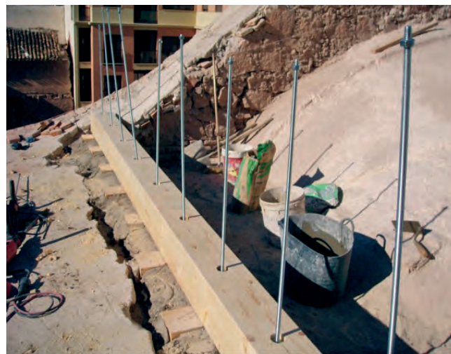
Figura 11. Ejecución de los nuevos durmientes nivelados con soleras de madera y detalle de las barras de acero calibradas para proceder a su fijación mediante tuerca y arandela. Fotografía: Juan de Dios de la Hoz.
