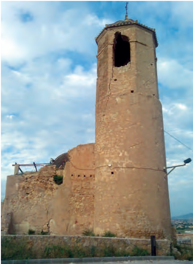
Figura 2. Vista general de la edificación, con la torre campanario en primer plano, tras los seísmos y previo a la intervención.
