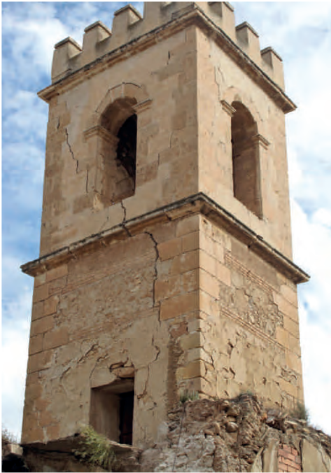
Figura 2. Imagen de la torre con las grietas en su fábrica provocadas por el terremoto. Fotografía: José Manuel Chacón Bulnes.
