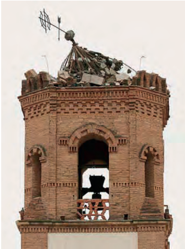
Figura 9. Colapso del cuerpo de remate y cupulín de la torre de la iglesia de Virgen de las Huertas.
