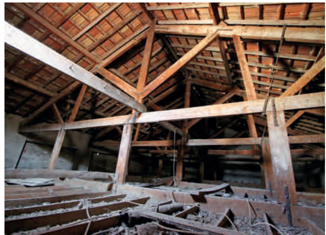
Figura 12. Cubierta sobre el salón de juego, en situación muy precaria ante fenómenos atmosféricos.
