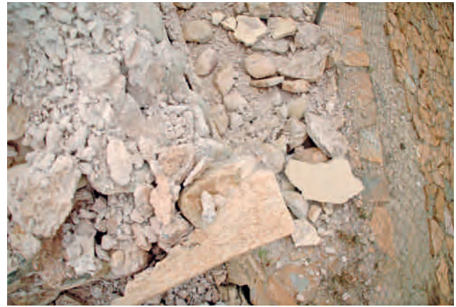
Figura 7. Cara norte. El revestimiento de la última intervención, se ha fisurado y desprendido del soporte.
