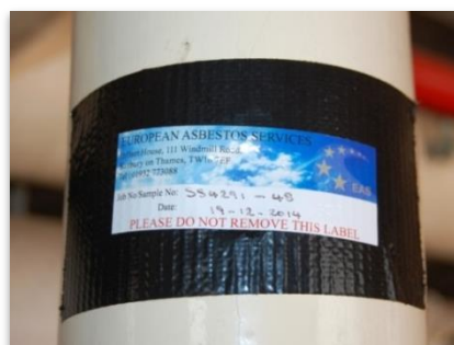
Tubería recubierta de amianto. Fuente: UEPG
