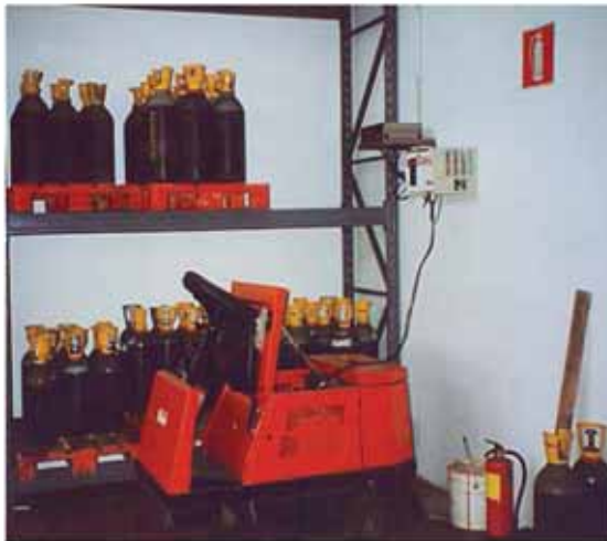
Ubicación inadecuada de los cargadores
