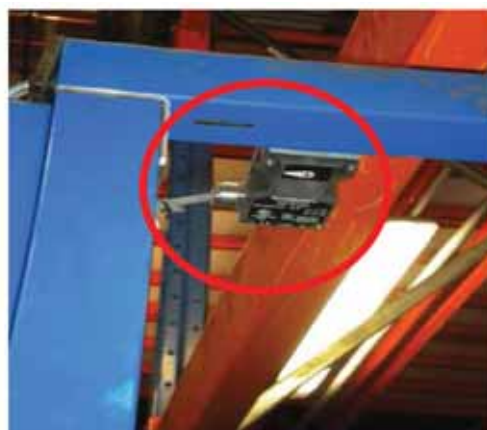
Puerta de acceso a un transelevador
