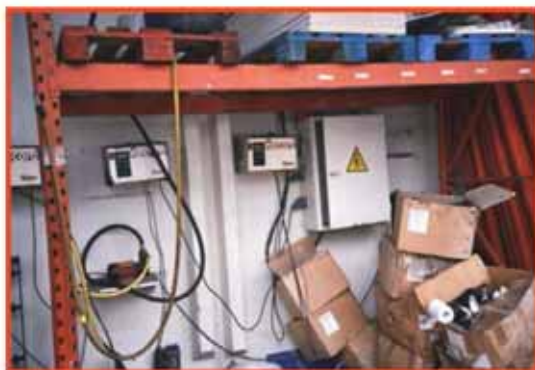
Ubicación inadecuada de los cargadores
