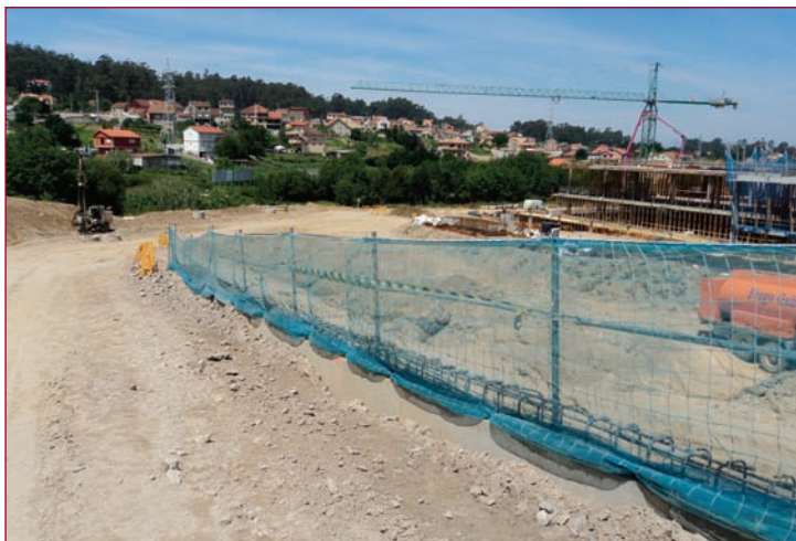
Barandilla complementada con red vertical
