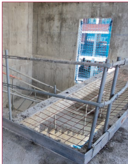
Barandilla perímetro de hueco en zona de escaleras
