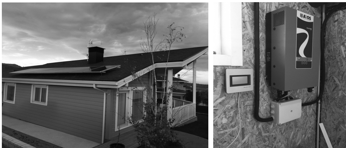
Figura 4. Instalación fotovoltaica autoconsumo
