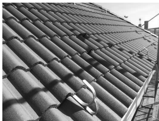
Figura 10. Preinstalación fotovoltaica en cubierta sureste
