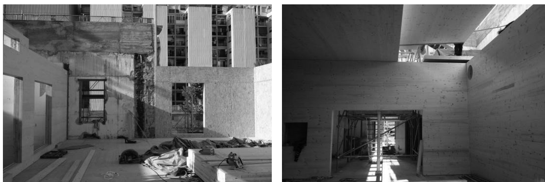
Figura 3. Relación entre la parte existente y la parte construida de nuevo y ampliada (izquierda) y sala de actos con estructura integra de madera contralaminada aparente (derecha)
