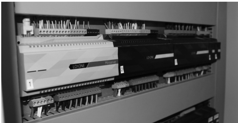
Figura 2. Instalación del Miniserver de Loxone
