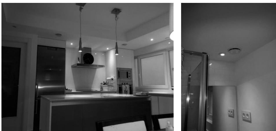
Figura 7. Integración de las Bocas extracción e impulsión en el interior de la vivienda
