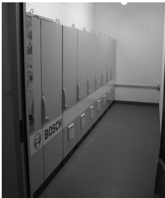
Figura 4. Foto del sistema de almacenamiento de energía de Bosch en la sala de máquinas
