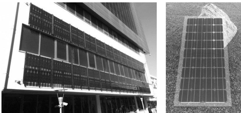
Figura 3. Vista de la fachada ventilada instalada. Unidad de vidrio fotovoltaico. Fuente: Onyx Solar
