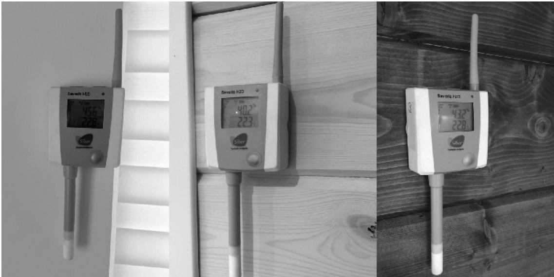
Figura 2. Sondas monitorización condiciones higrotérmicas
