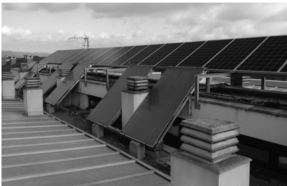
Figura 3. Energía solar, térmica y fotovoltaica
