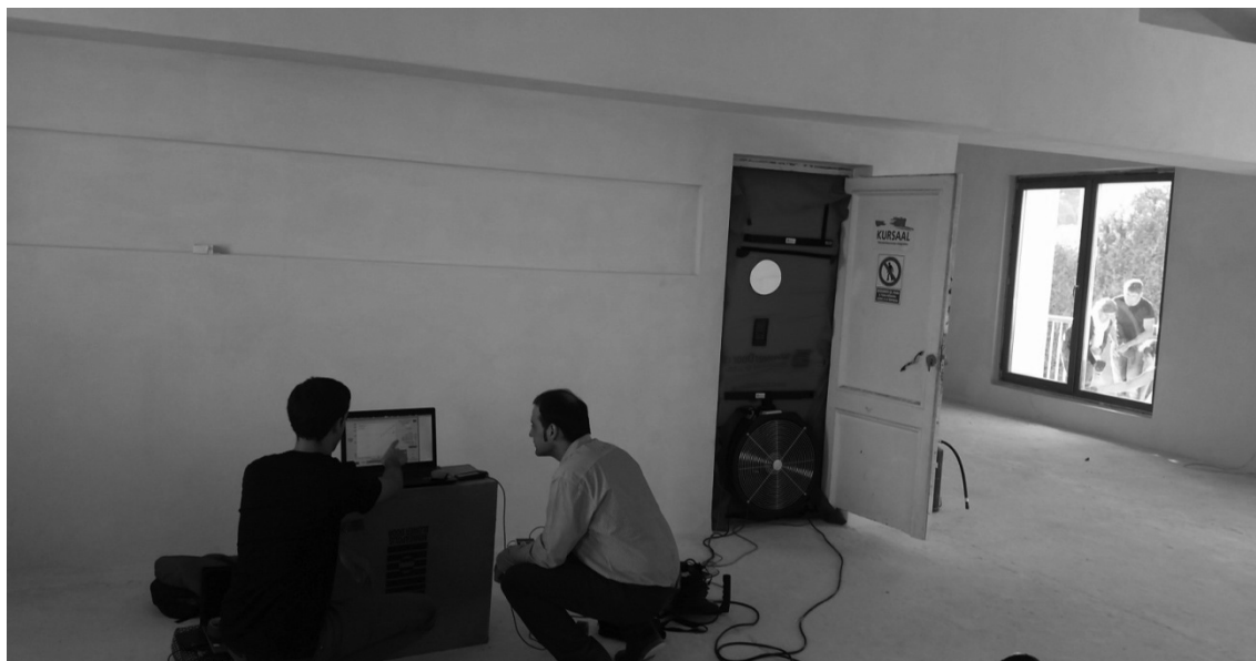
Figura 4. Realización del test Blower Door durante la ejecución de la obra para control de infiltraciones
