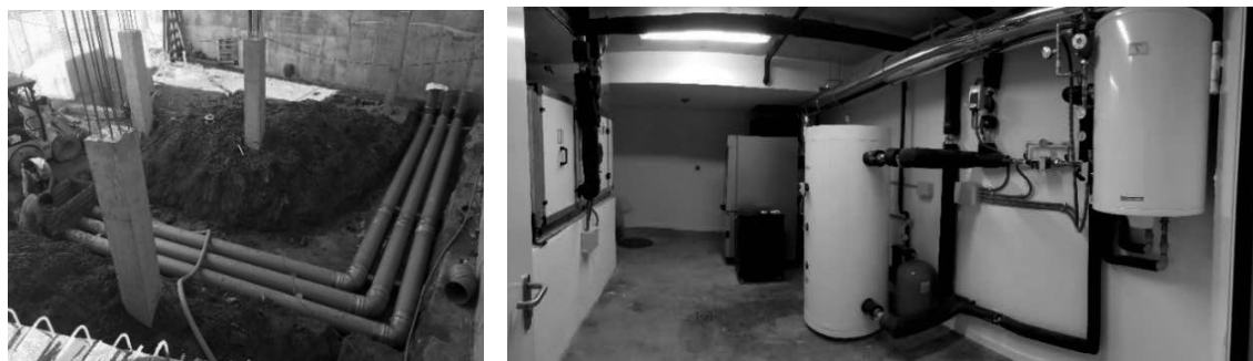
Figura 4. Galería geotérmica y sala con caldera de biomasa, depósito de inercia y UTA conectada a la galería
