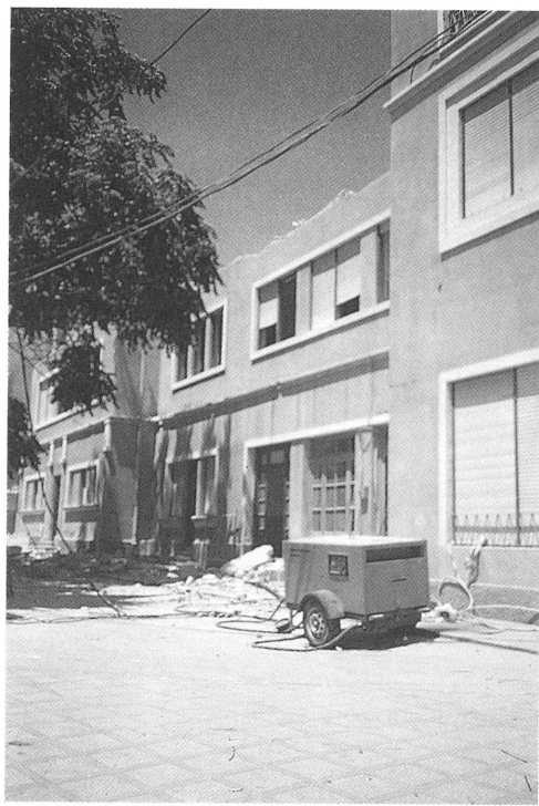
Foto 69. El compresor debe instalarse al aire libre.
