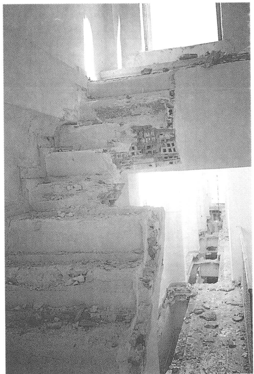
Foto 20. Escalera con excesivo peligro sin protecciones.
