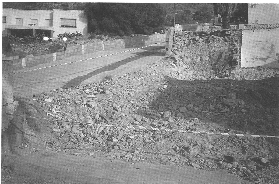
Foto 65. No se debe practicar el vaciado completo del solar cuando existan edificaciones vecinas.
