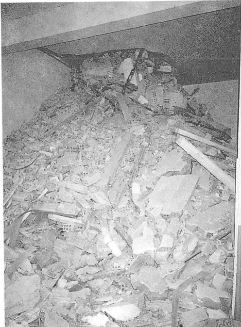
Foto 31. El escombro no debe alcanzar estas alturas para evitar sobrecargas en los forjados.
