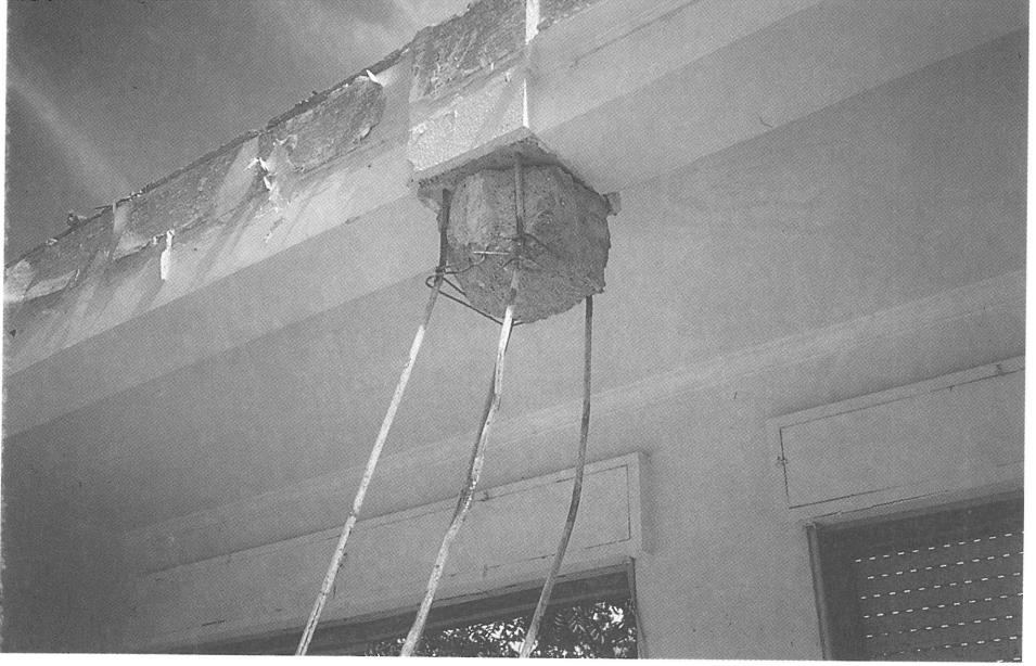
Foto 76. Situación crítica de máximo riesgo.
