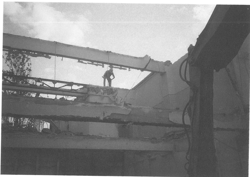
Foto 58. Las vigas metálicas suelen recuperarse completas en toda su longitud, lo que implica una seguridad específica.
