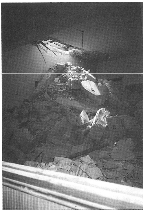
Foto 25. En la planta baja se delimitará la zona de peligro del vertido de los escombros.
