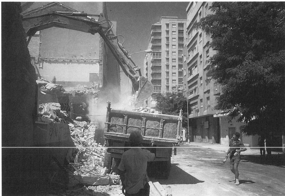
Foto 9. La carga de escombros deberá ordenarse y señalizar su peligrosidad.
