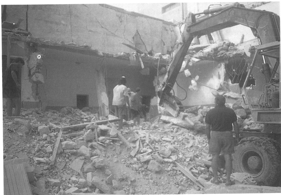
Foto 64. Recuperación de cable de acero partido por tracción y no haber previsto un segundo cable para su recuperación.
