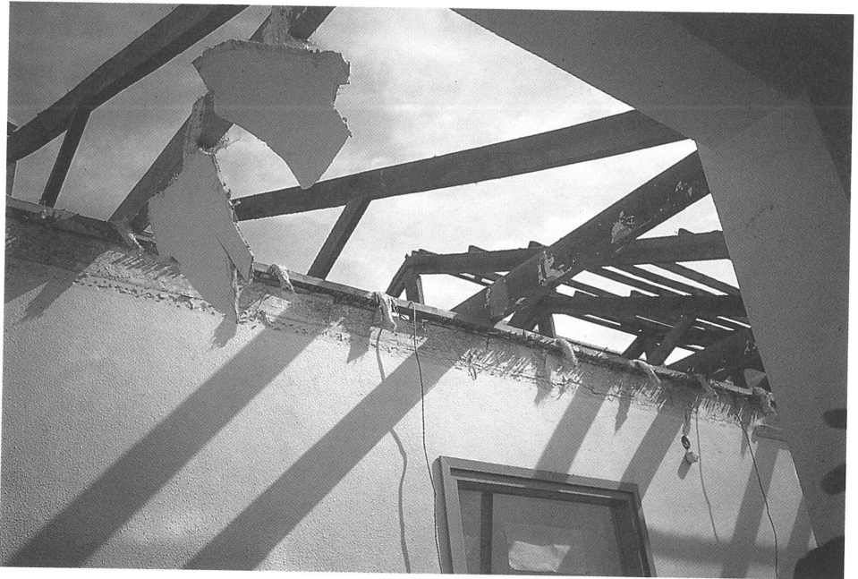
Foto 36. Siempre el primer elemento a derribar ha de ser la cubierta del edificio.
