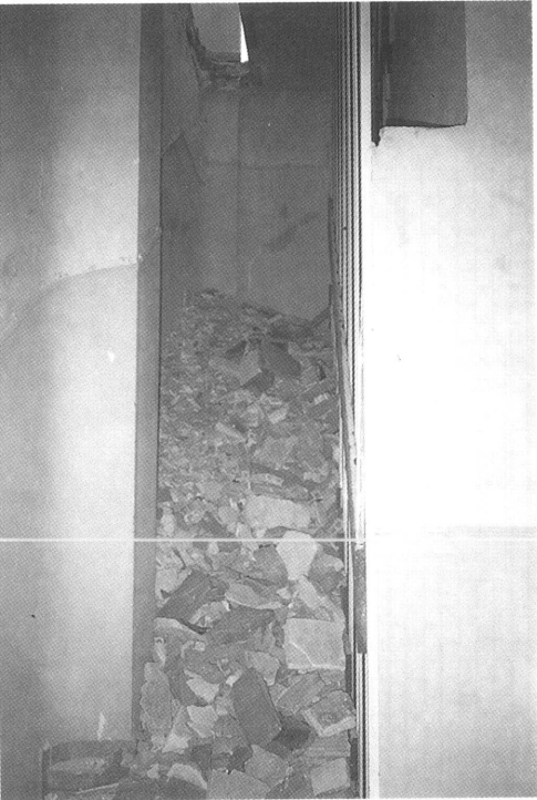
Foto 19. Las escaleras deben permanecer libres de escombros para poder ser utilizadas sin riesgo alguno.
