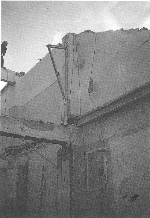
Foto 41. Momentos de peligro para los operarios por falta de organización.
