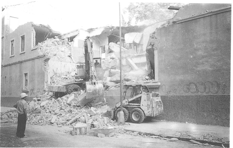
Foto 38. Hay que alternar el proceso de derribo con la retirada de escombros de una forma ordenada.
