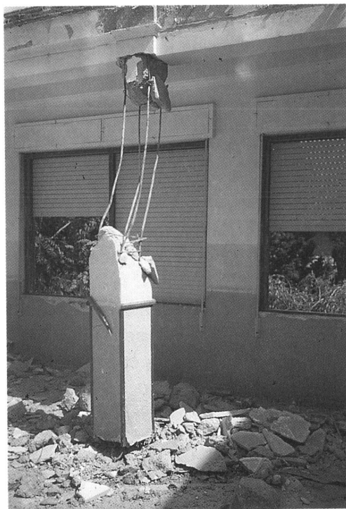
Foto 57. Los pilares, a veces, no cuentan con los solapes correspondientes en sus armaduras.
