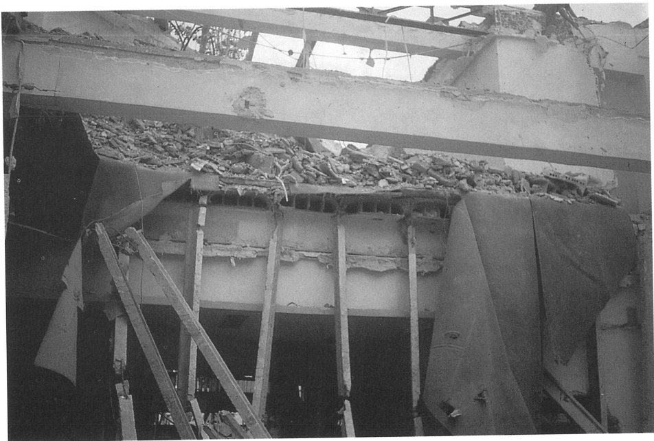
Foto 39. Ejemplo de desorden (peligroso) en una demolición.
