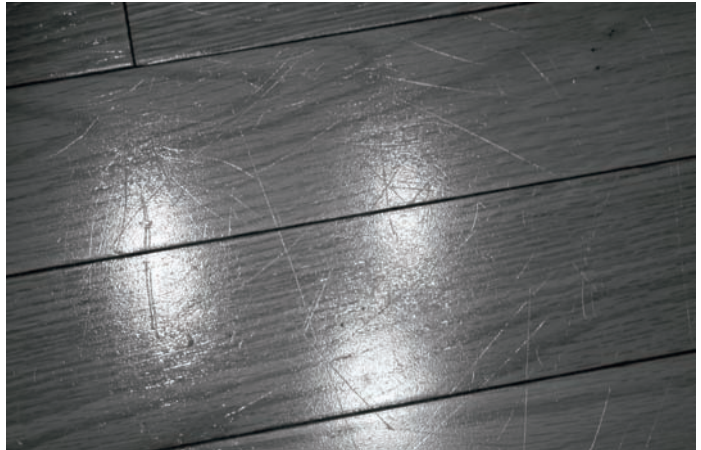
Figura 82 Ralladuras en el parqué. Fuente: www.hardwoodflooringinspectors.com
