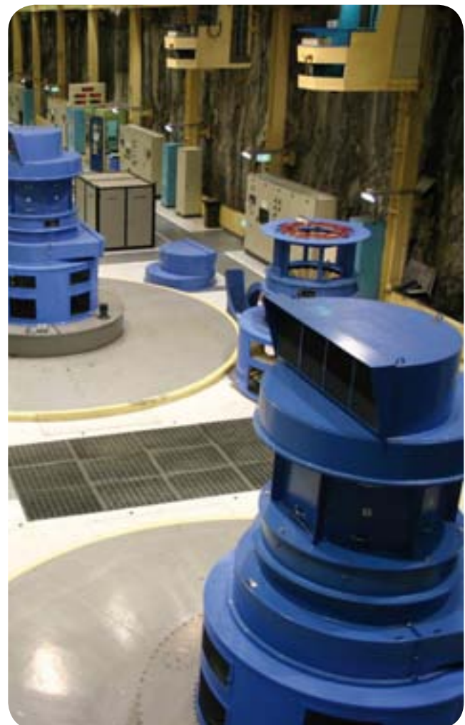
Turbinas verticales en una central hidroeléctrica.
