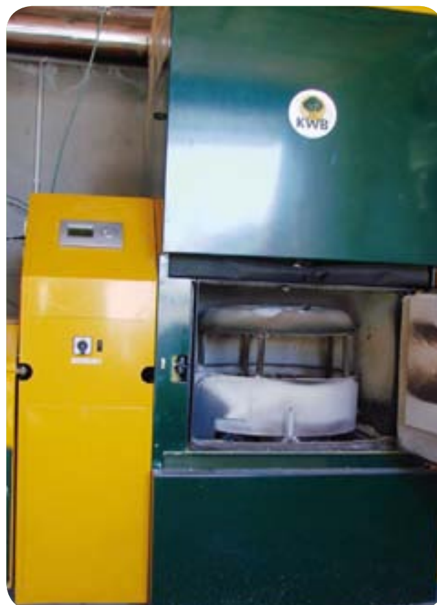
Caldera automática multi-combustible.
