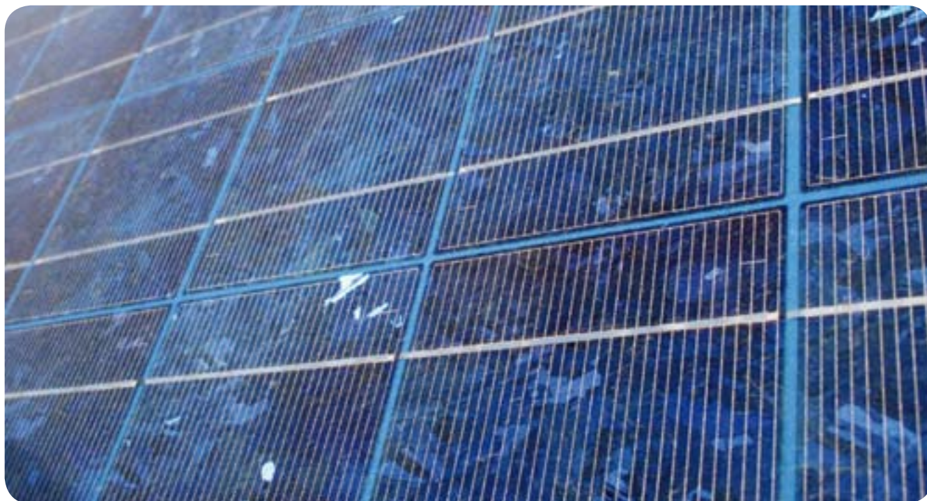
Detalle de panel fotovoltaico de silicio policristalino.
