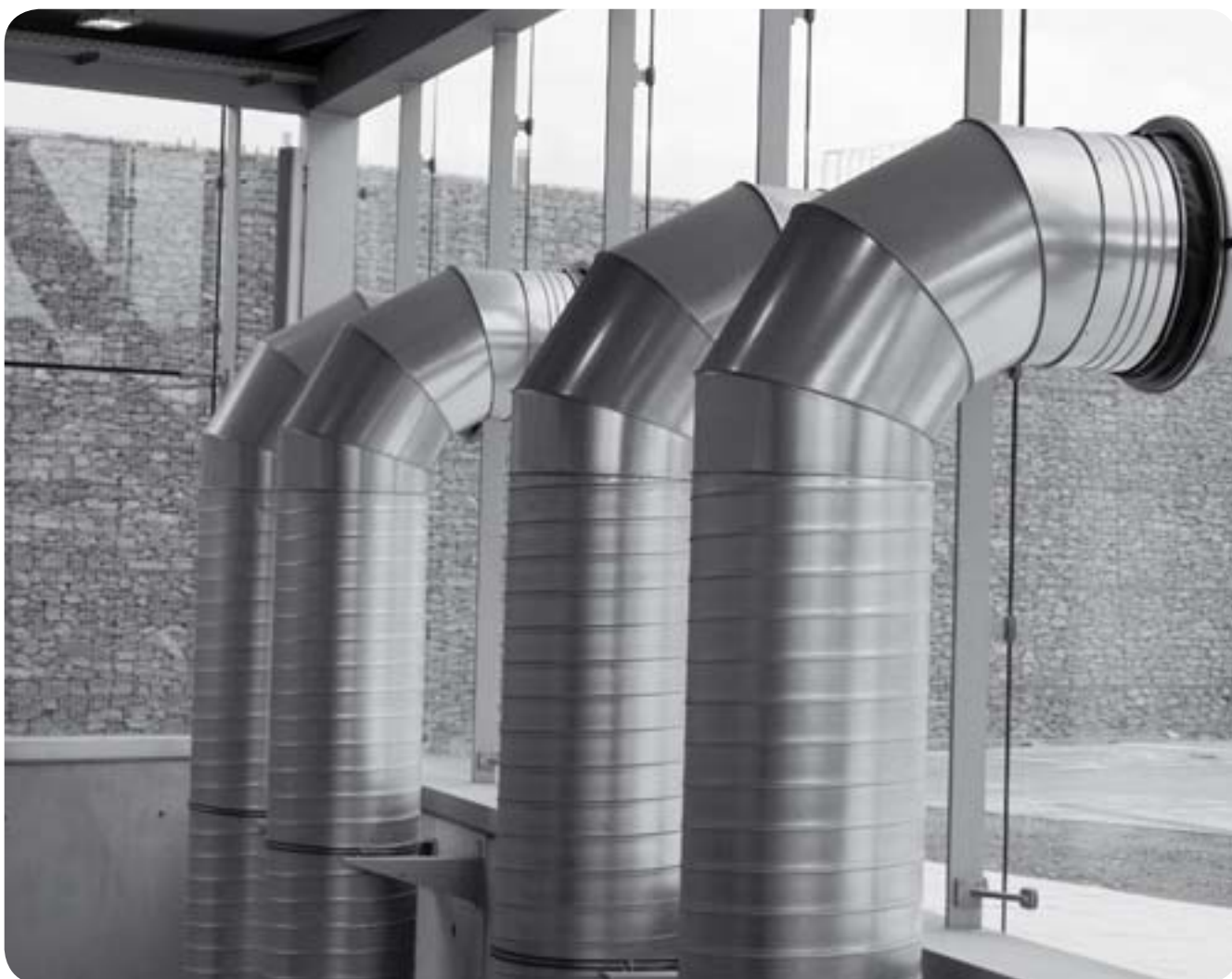
Ventilación forzada en estación de metro.
