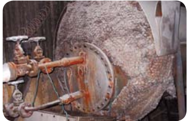
Caldera con aislamiento deteriorado.
