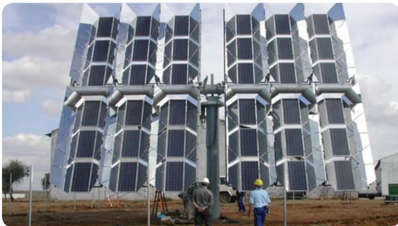
Módulos fotovoltaicos comerciales con concentración solar 2X en Sevilla PV. Plataforma Solúcar. Abengoa Solar.
