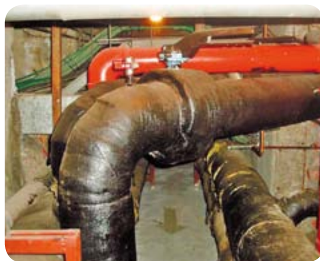
Red de distribución de vapor.
