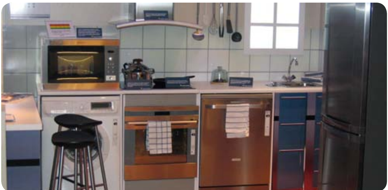
Vista interior de la cocina con sus equipos eléctricos. Casa eficiente de Gas Natural Fenosa.
