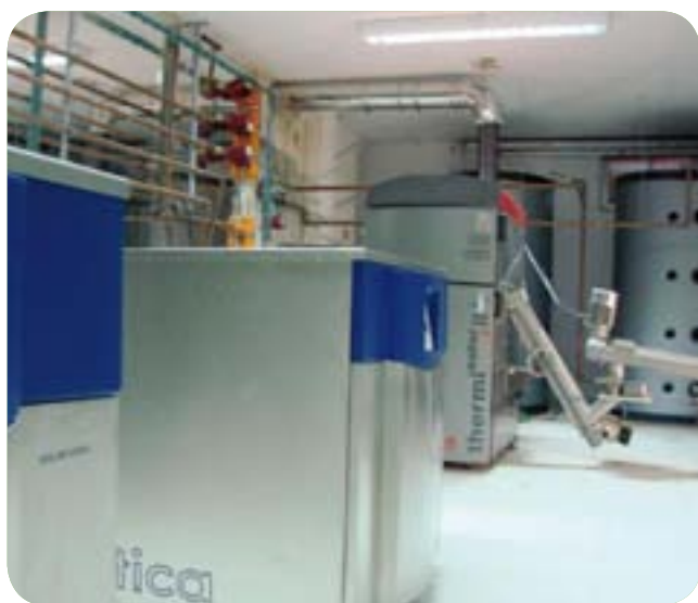
Sistema de climatización (Calor y frío) de la Casa de la Cultura de Viana de Cega, Valladolid.
