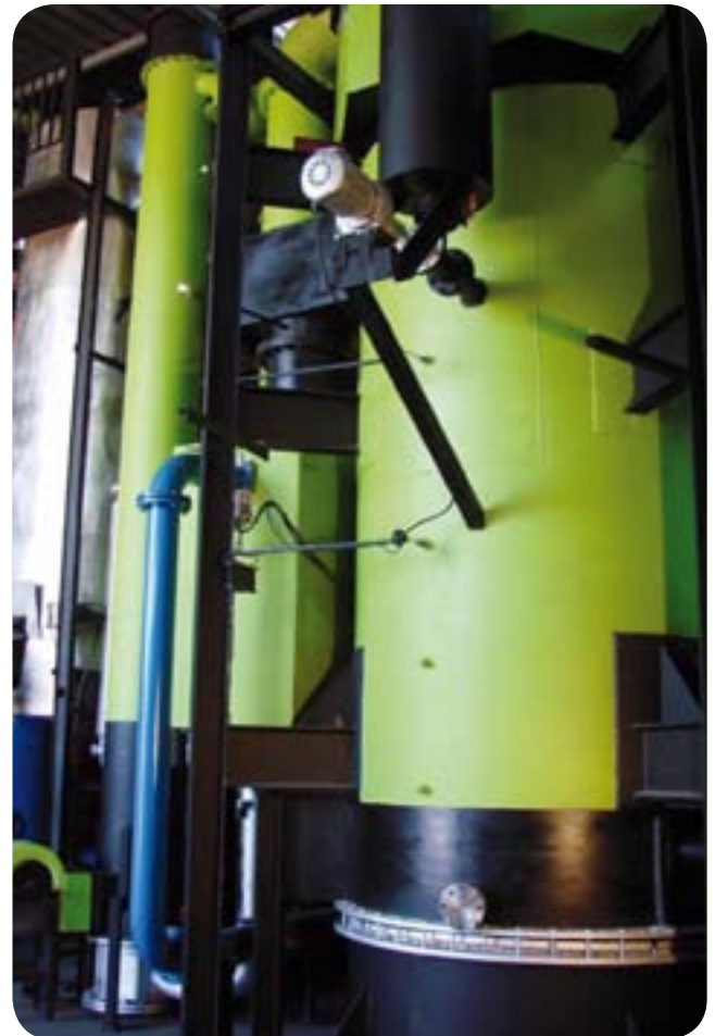
Gasificador de lecho fluidizado de Energía Natural de Mora.
