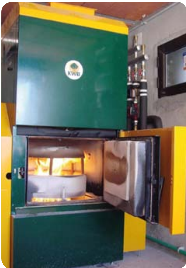
Cámara de combustión de una caldera de biomasa doméstica.
