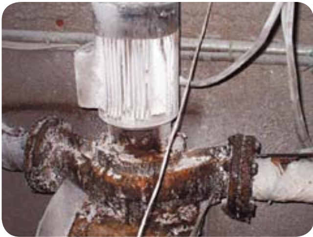
Falta de mantenimiento de la red de distribución.
