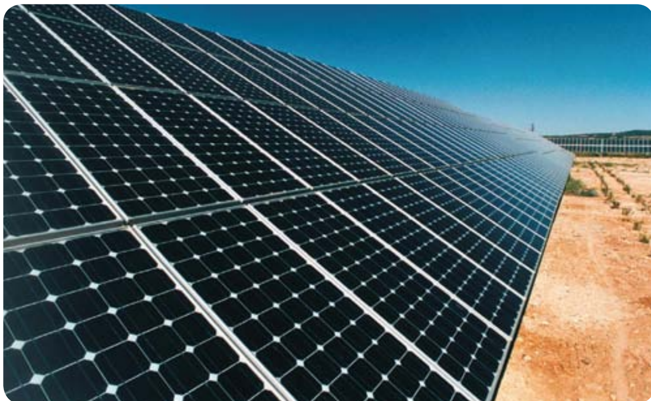
Paneles fotovoltaicos de la Central Toledo PV.
