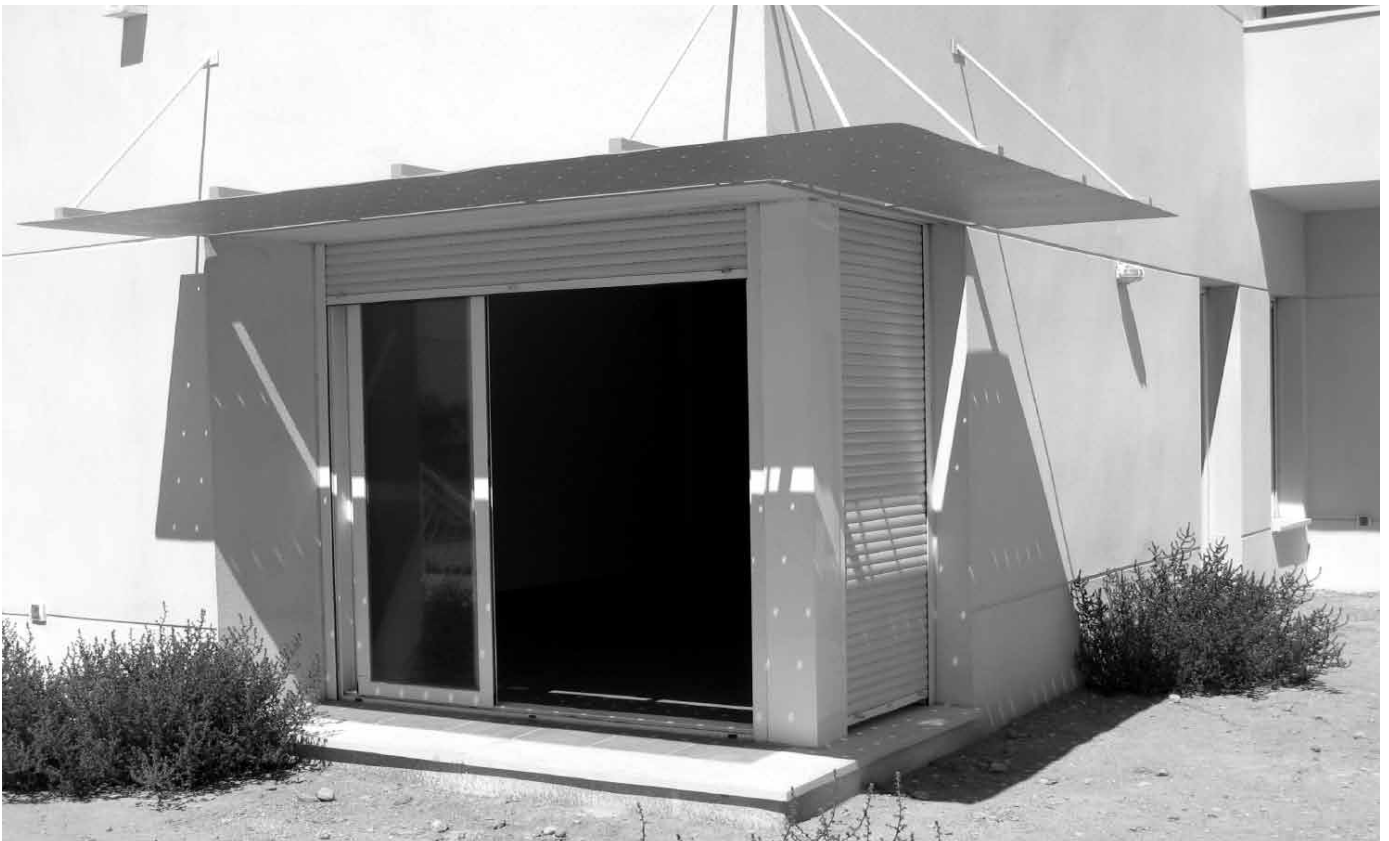
Elemento para sombra sobre ventana captora, obstrucción solar en verano. Conjunto de 351 viviendas bioclimáticas en El Toyo, Almería. Arquitectos: M. de Luxán, R. Tendero, P. Nau.
