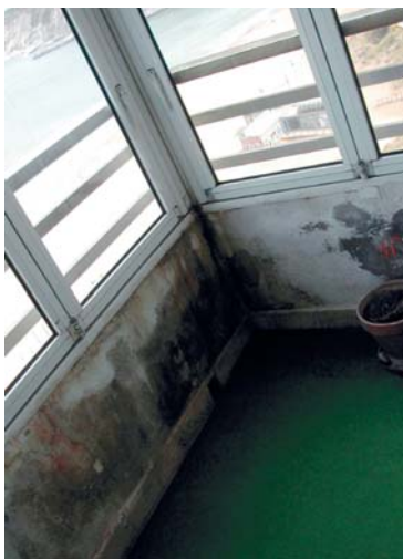
Fotografía 2. Efectos de condensación en puentes térmicos. Fuente: Javier Crespo.
