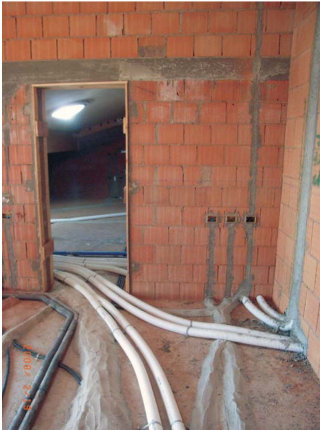
Fotografía 10. Multiresidencial «Sant Anna»: Distribución de los conductos de la ventilación en el suelo. Fuente: TBZ.
