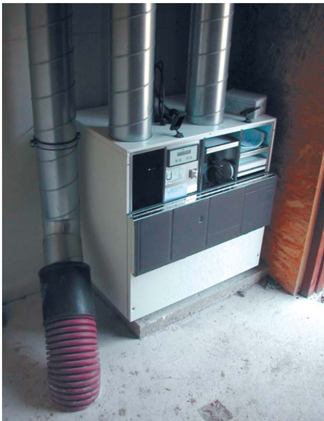
Fotografía 6. Recuperador de calor. Fuente: Wolfgang Berger.
