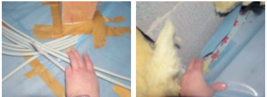
Fotografías 1 y 2. (izq.) Infiltración debido a penetración de cables. (drcha.) Infiltración debido a aislamiento incorrecto en el encuentro con la chimenea. (Fuente: Blower Door GmbH).
