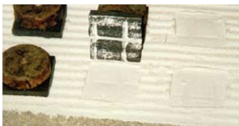
Rotura adhesiva baldosa/adhesivo (ANFAPA) RA-B
