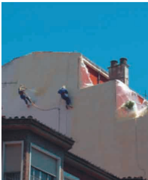
Foto 4. La gran adherencia del poliuretano proyectado hace que no requiera de ningún otro sistema adicional de sujeción. Fuente: ATEPA.
