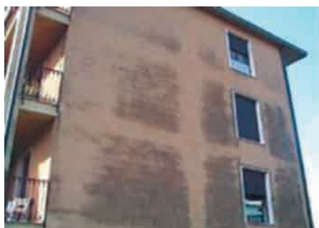
Figura 2. Edificio con defectos en los pilares y frentes de forjado. Fuente: Guía IDAE: Sistemas de Aislamiento Térmico por el exterior (SATE) para la Rehabilitación de la Envoltura Térmica de los Edificios.
