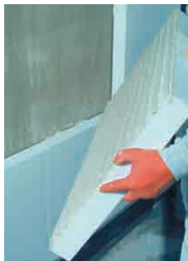
Figura 5. Detalle del pegado de una plancha de aislamiento en toda la superficie. Fuente: Guía IDAE: Sistemas de Aislamiento Térmico por el exterior (SATE) para la Rehabilitación de la Envoltura Térmica de los Edificios.
