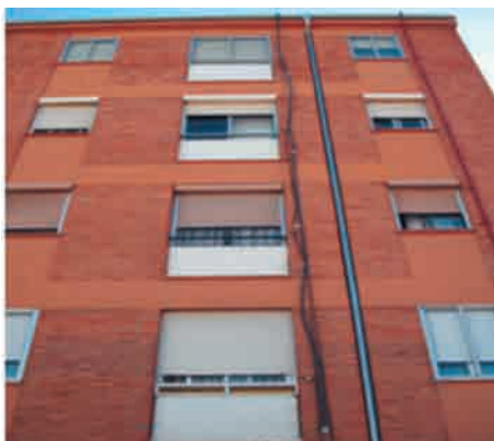
Figura 3. Fotografía de una fachada con conducciones exteriores antes de rehabilitar. Fuente: Guía IDAE: Sistemas de Aislamiento Térmico por el exterior (SATE) para la Rehabilitación de la Envolvente Térmica de los Edificios.
