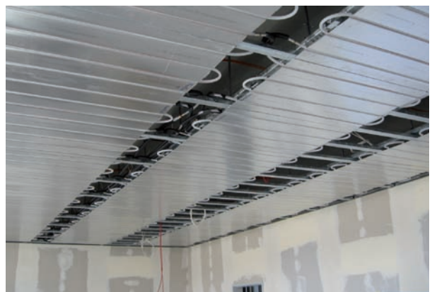
Fig. 75: Doble función: calefacción y refrigeración en la zona del techo
