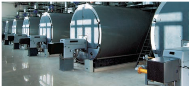
Fig. 100: Sistema de calefacción consistente en siete generadores de agua caliente con una potencia total de 105 MW
