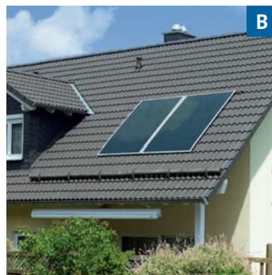
B Calentamiento solar del agua potable
