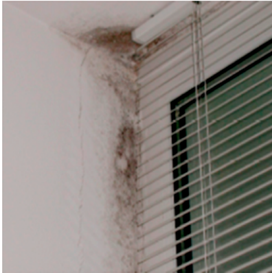
Figura 40. Problemas de humedades por una mala instalación de la carpintería
